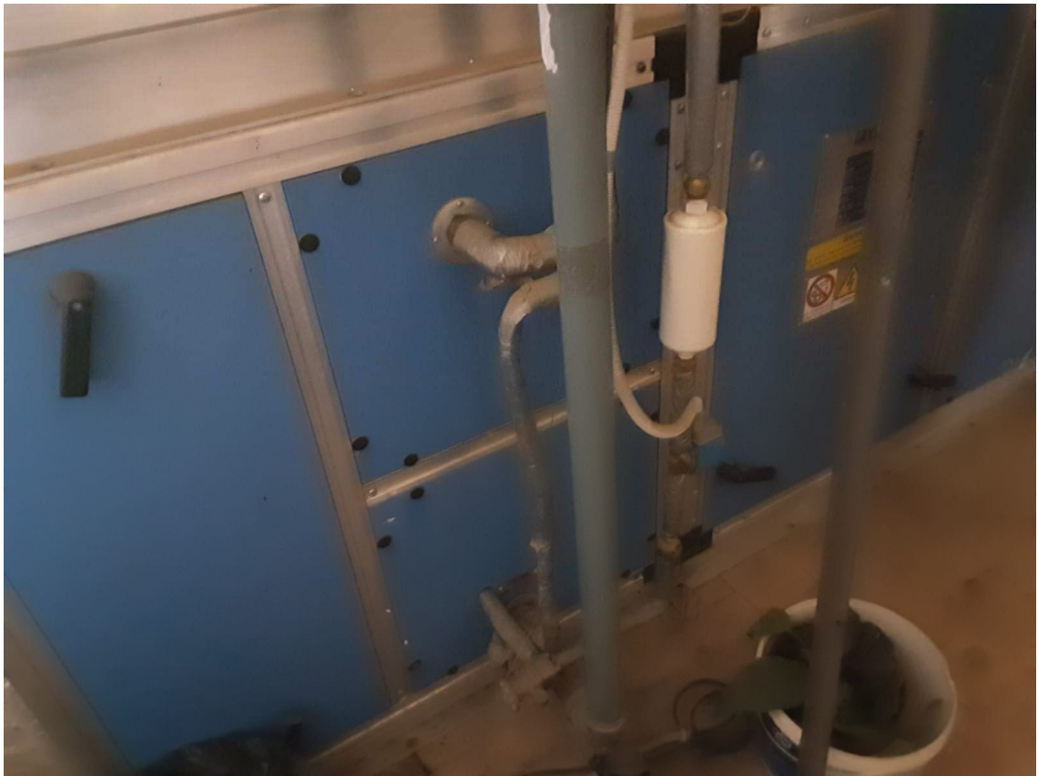
Фото 5. Отсутствуют узлы обвязки.
