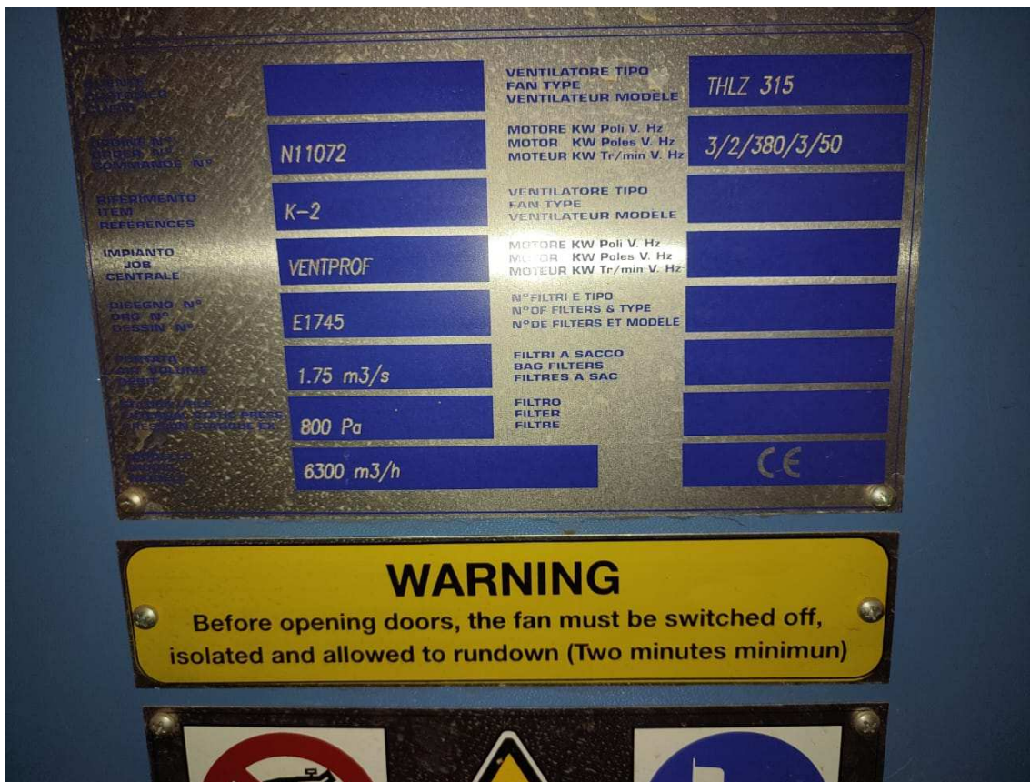
Фото 6. Производительность установки 6300 м³/ч.
