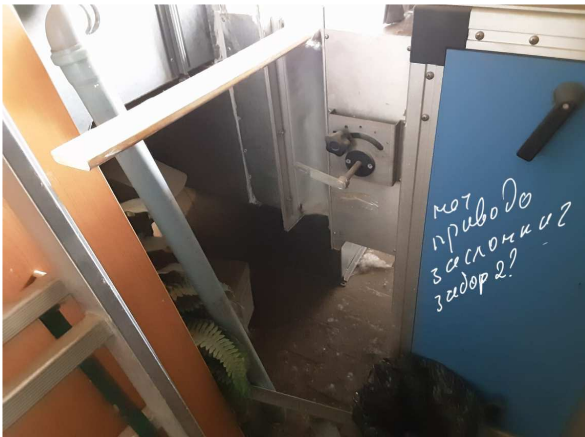
Фото 2. Отсутствуют приводы заслонок.
