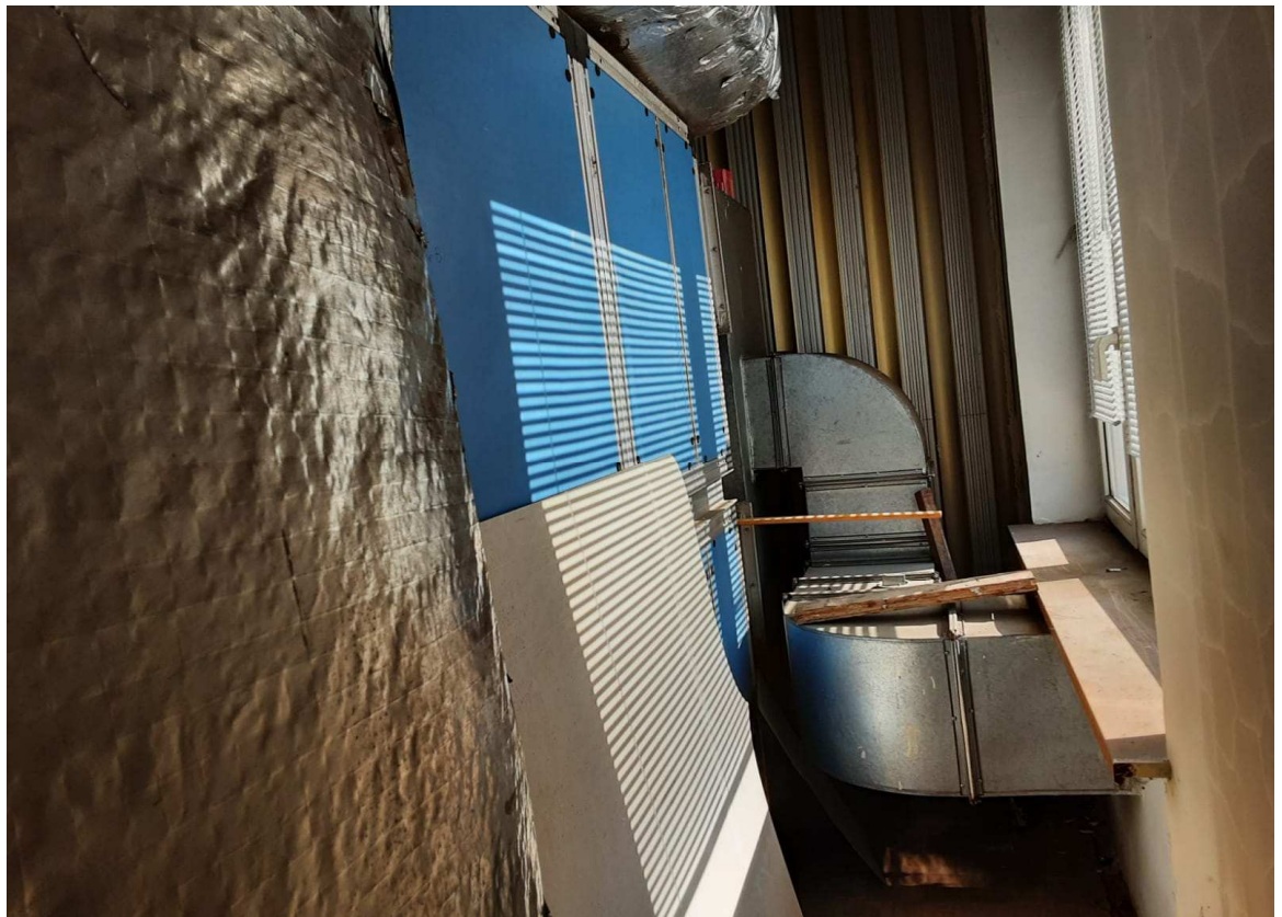
Фото 8. Сечение существующего дублирующего воздуховода на заборе воздуха составляет 450×450 мм.
