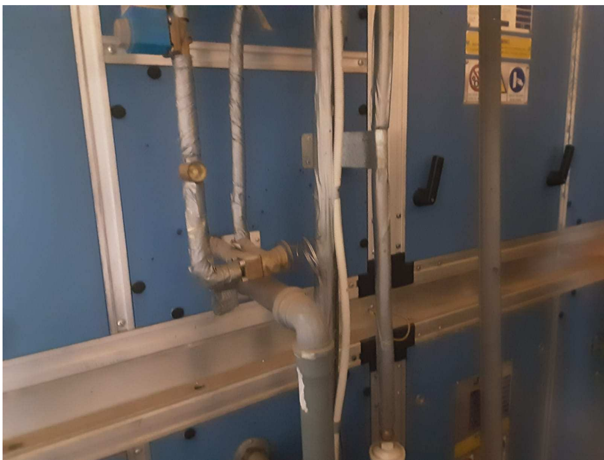
Фото 4. Отсутствуют узлы обвязки.
