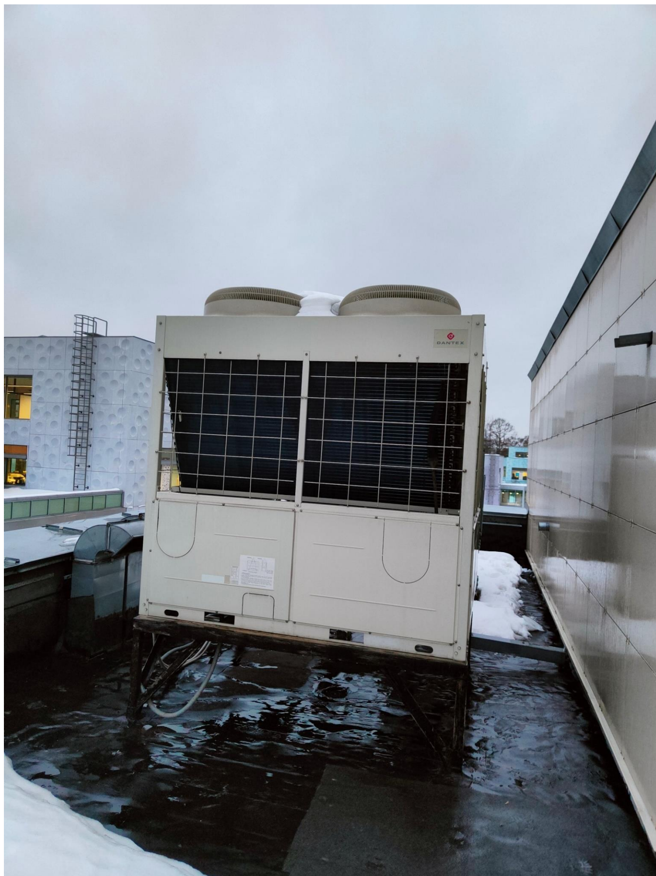
Фото 58. Чиллер на кровле не введён в эксплуатацию, не работает, не выполнено ПНР.
