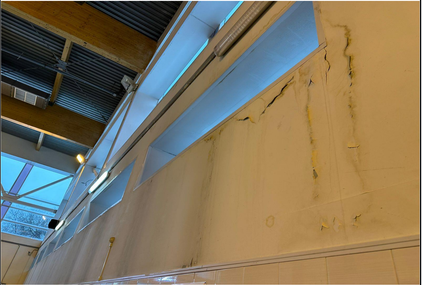
Фото 30. Первый этаж. Зона бассейна. Подтеки конденсата от стеклопакетов.
