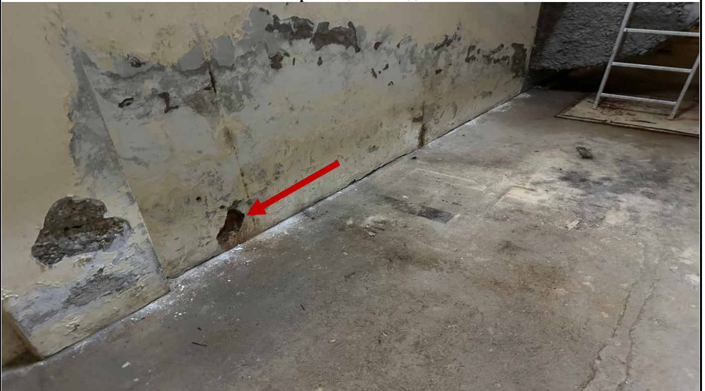
Фото 1. Подвал под чашей бассейна. Следы повсеместного намокания стен. Протечки канализации
