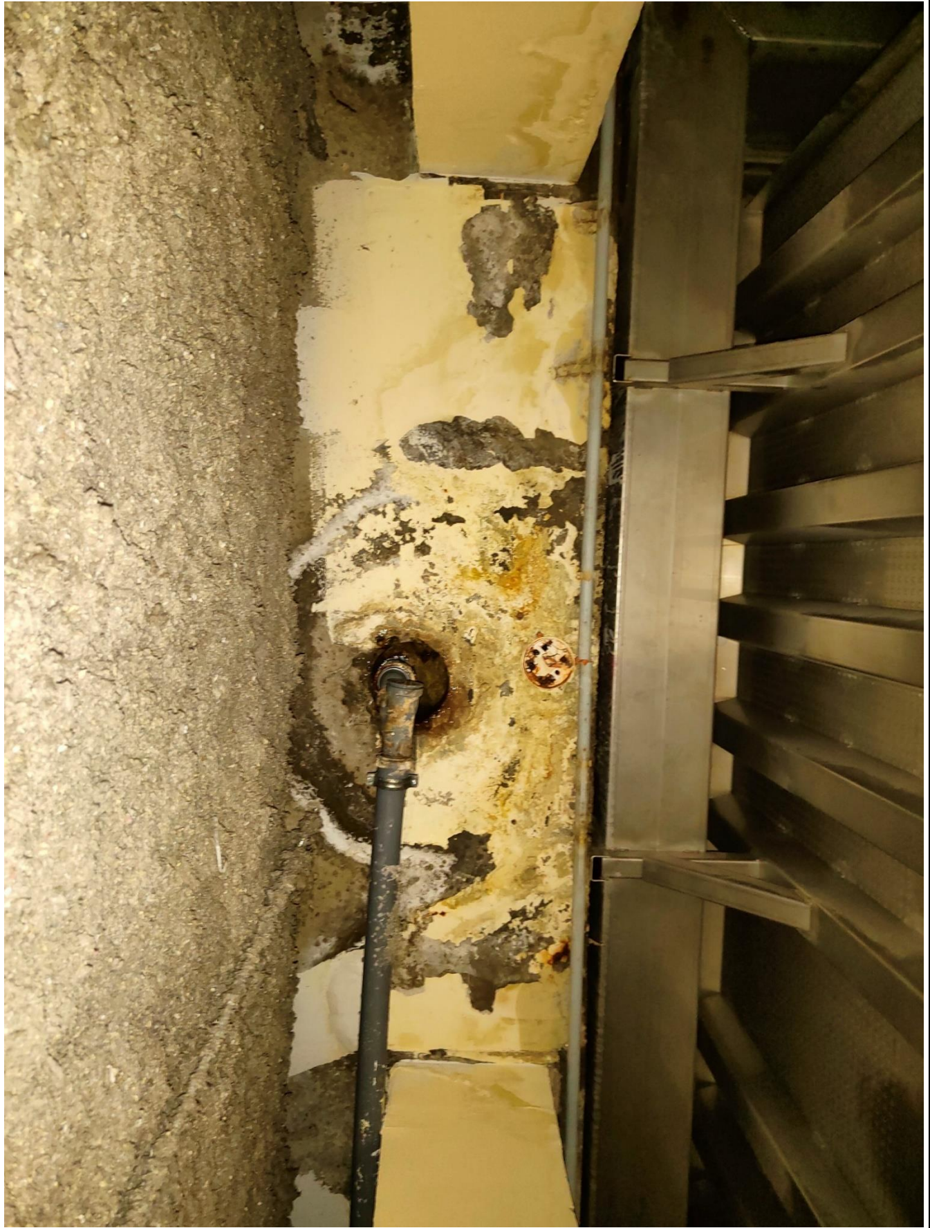
Фото 14. Из-за протечки дренажных трапов залив пожарных извещателей водой.
