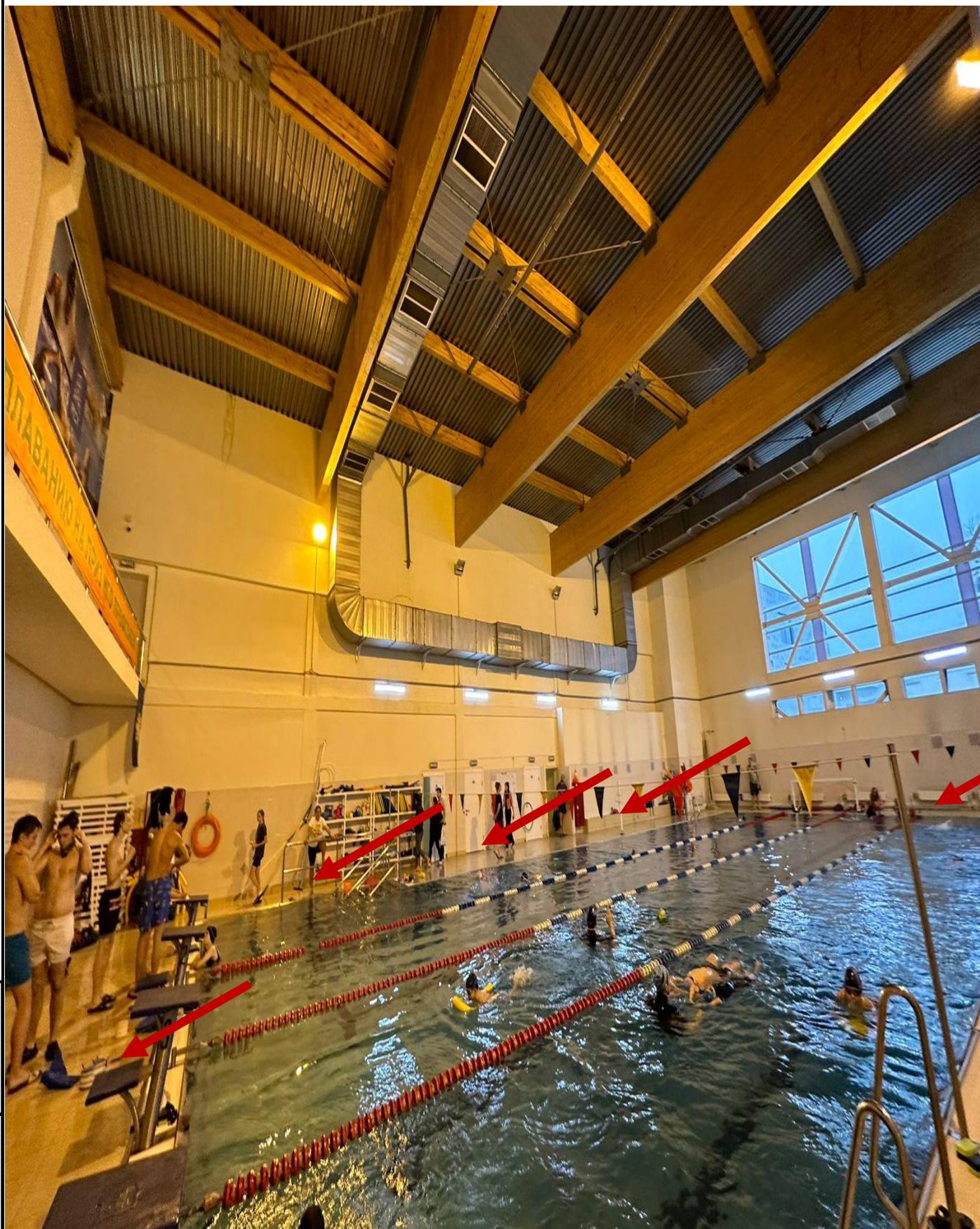
Фото 29. Первый этаж. Протечки канализации
