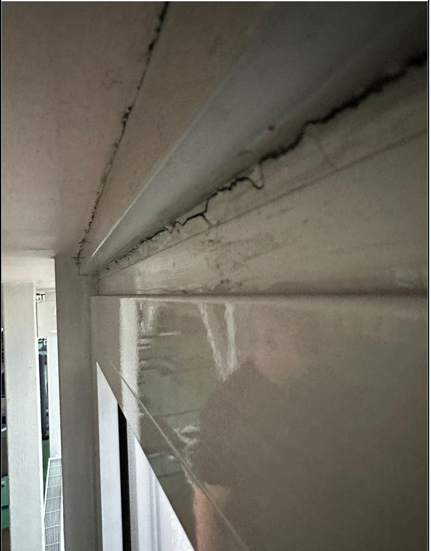
Фото 41. Первый этаж. коридор. Образование сквозных трещин на соединении Рамы ПВХ и металлического откоса. Монтаж окно не соответствует ГОСТ 30971-2012 «Швы монтажные»
