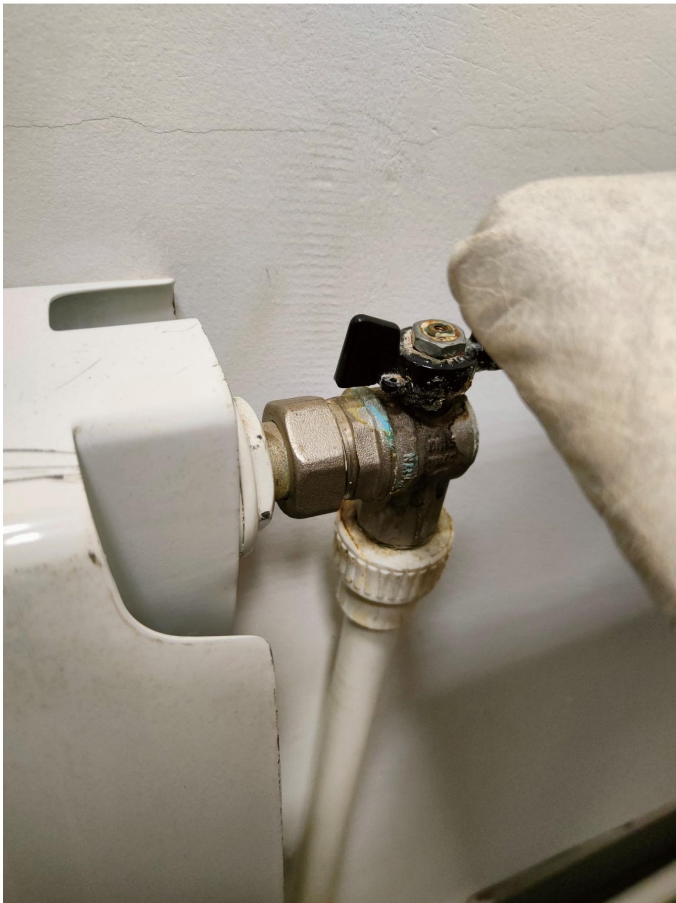
Фото 51. Коррозия запорной арматуры радиаторов отопления.
