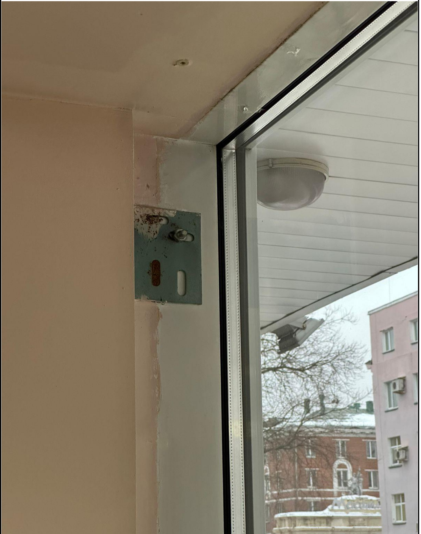
Фото 40. Первый этаж. коридор. Однокамерные стеклопакеты. Нарушены требования СП 50.13330.2020 Тепловая защита зданий и сооружений
