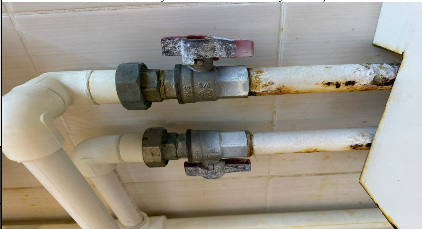
Фото 36. Первый этаж. Зона бассейна. Коррозия металлических элементов труб и запорной арматуры системы отопления. Высокая влажность воздуха более 100%. Система осушения не работает.
