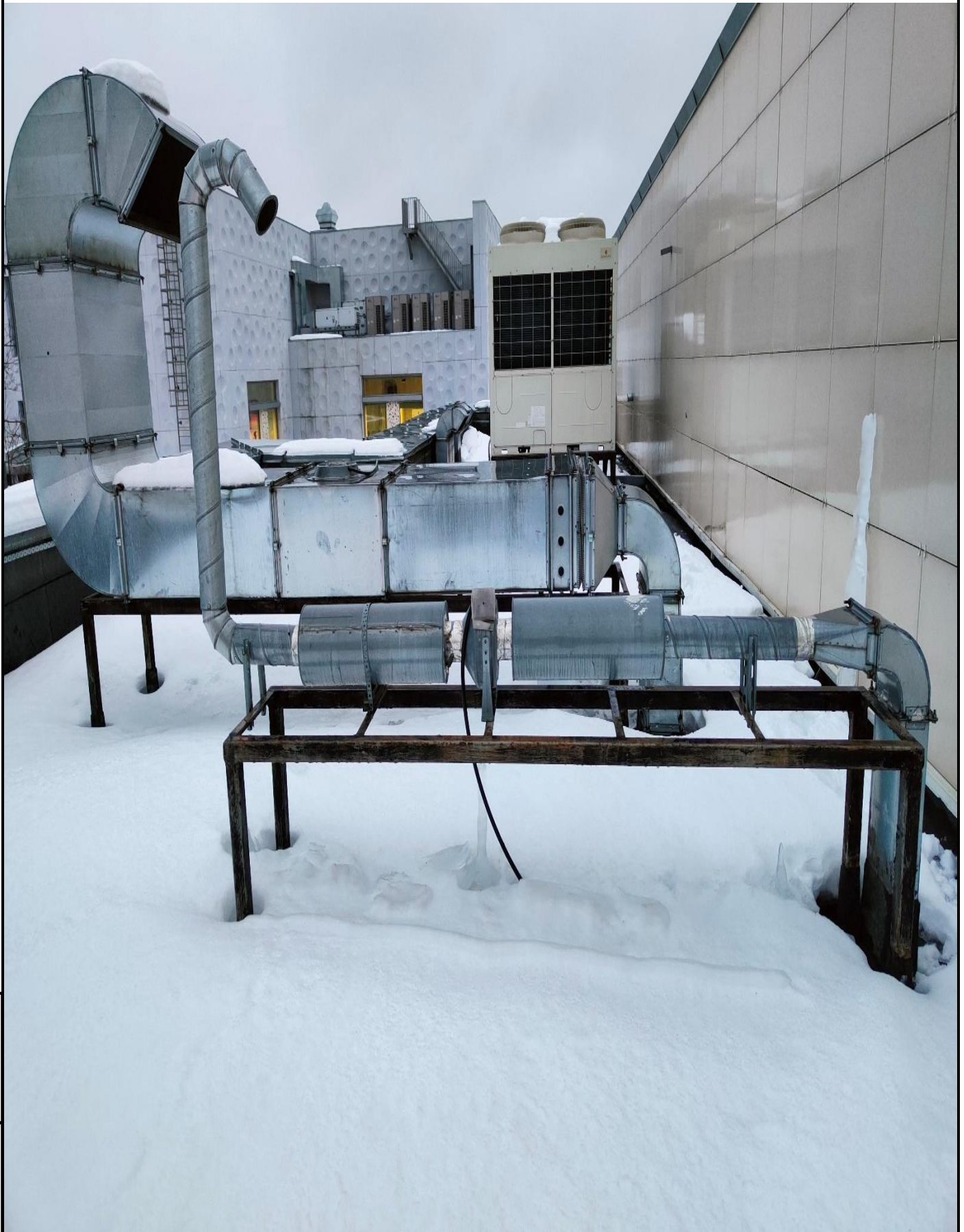
Фото 57. Чиллер на кровле не введён в эксплуатацию, не работает, не выполнено ПНР.
