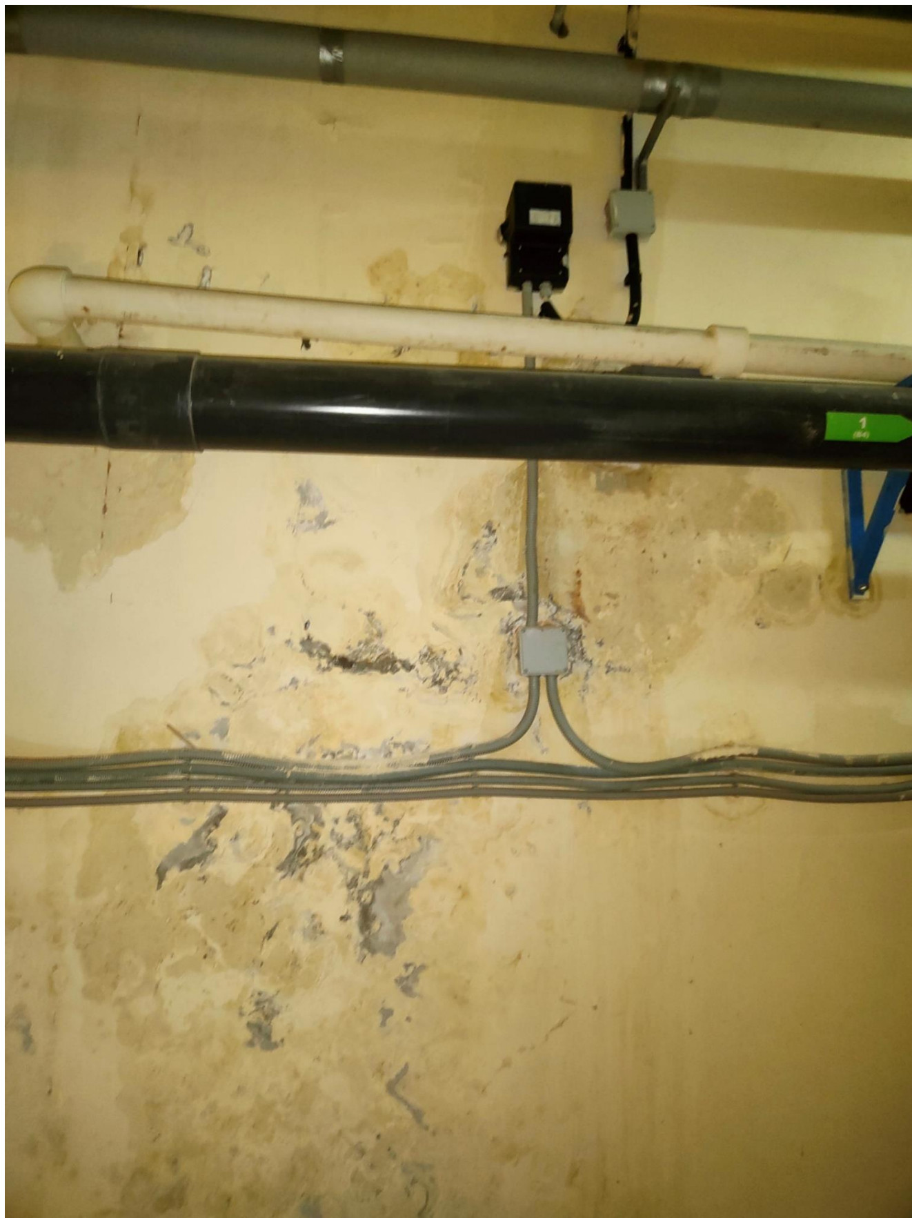
Фото 13. Не герметичные распаянные коробки установлены в мокрых зонах и подвержены заливом водой.
