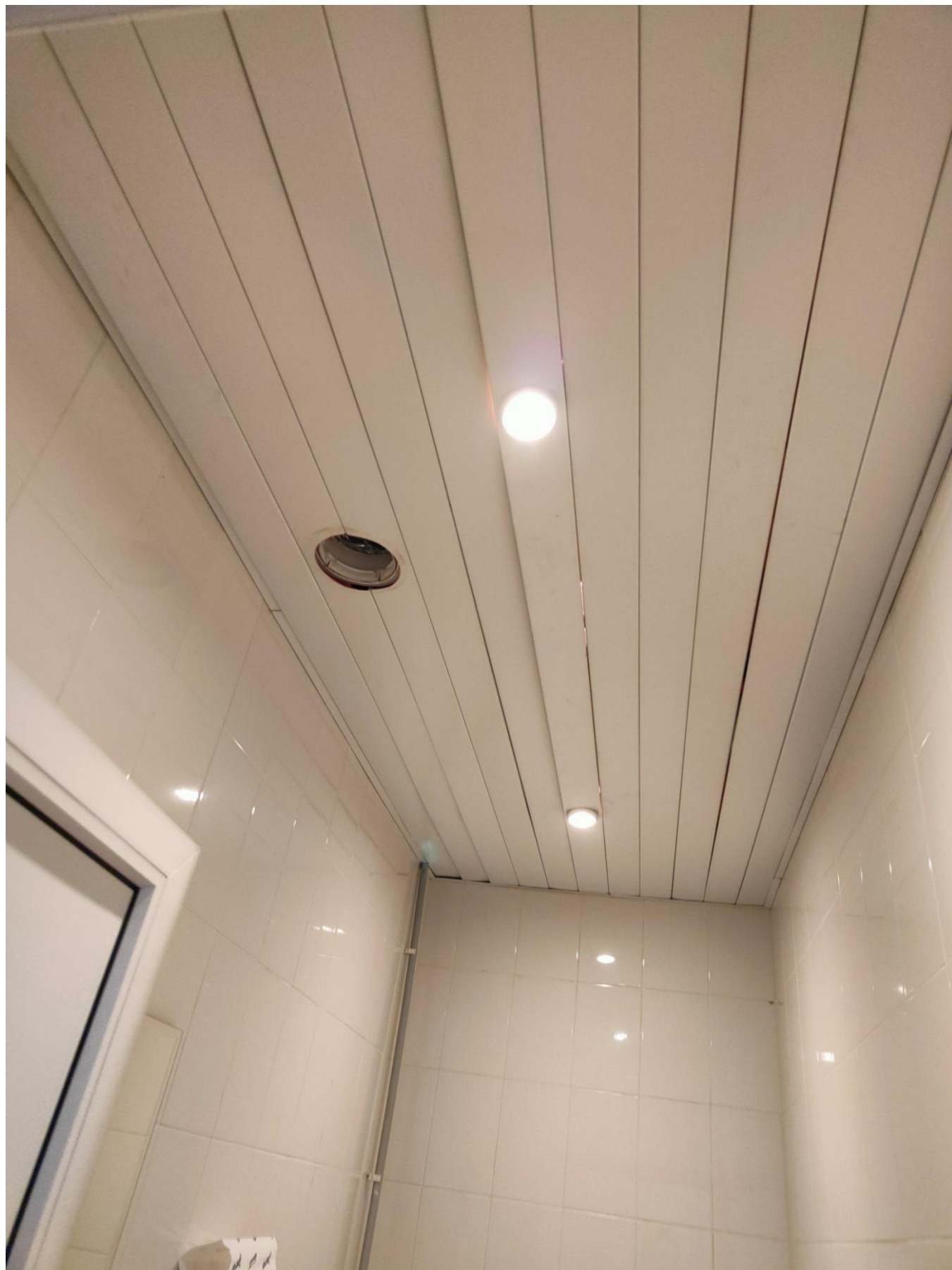
Фото 48. Отсутствие вентиляционных решеток.
