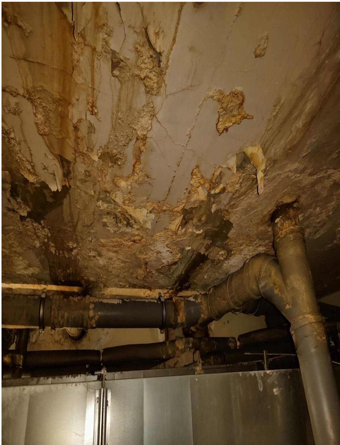
Фото 22. Отсутствие противопожарных муфт и следы коррозии на пластиковых трубопроводах под дренажными трапами.
