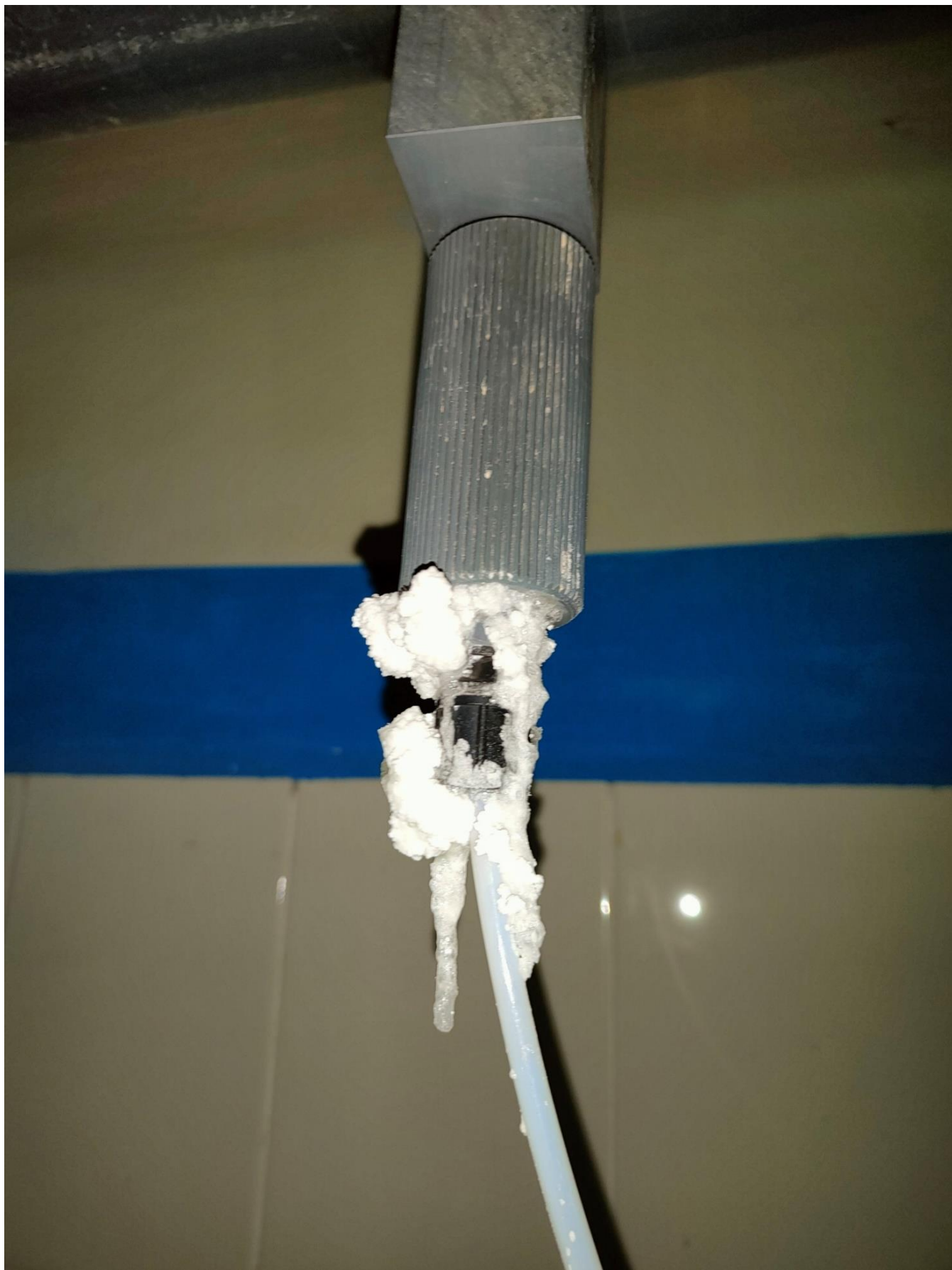
Фото 11. Течи реагента системы водоподготовки.
