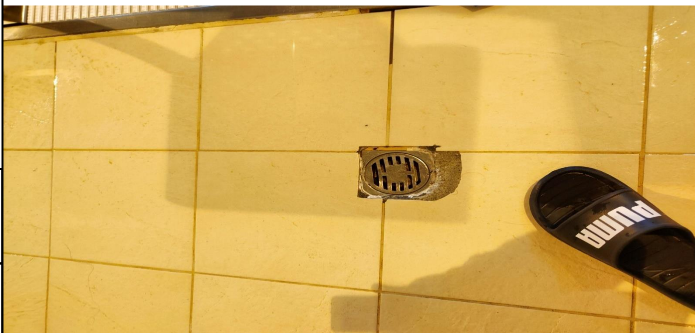
Фото 47. На обходных дорожках чаши бассейна установлены бытовые дренажные трапы на меньшую производительность.
