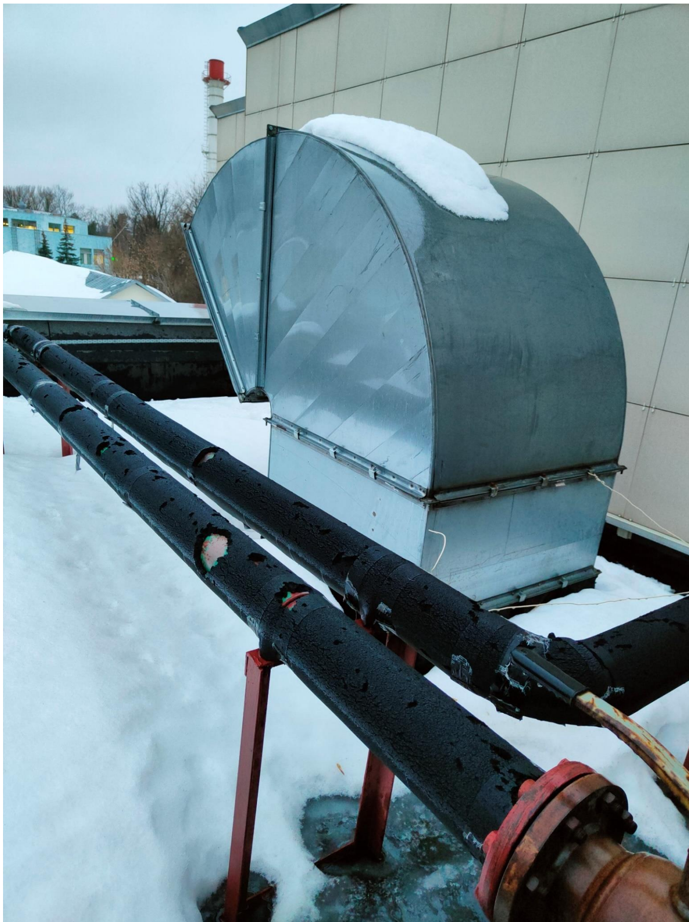
Фото 59. Частичное нарушение изоляции трубопроводов.
