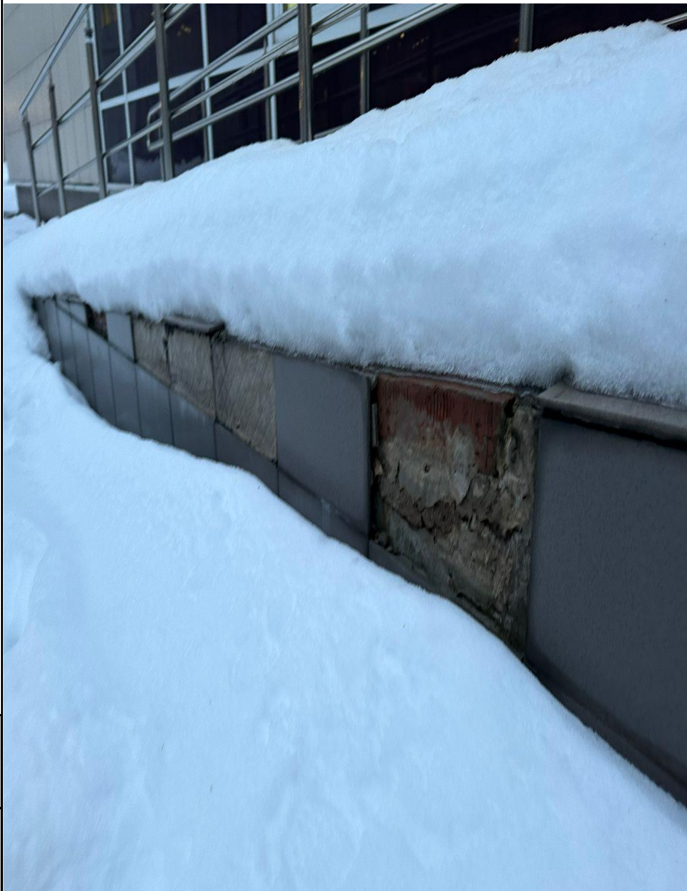
Фото 68. Фасад. Деструкция отделочных материалов входных групп.
