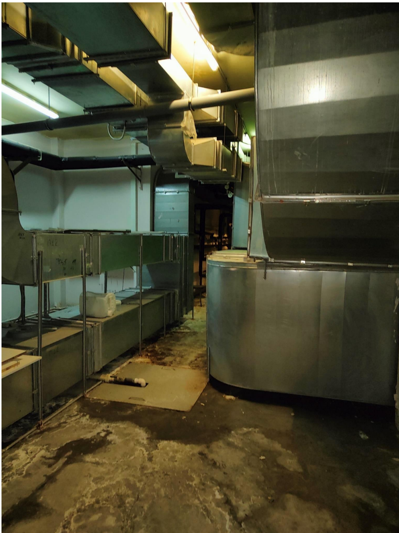
Фото 23. Следы затопления вентиляционной камеры в подвале.
