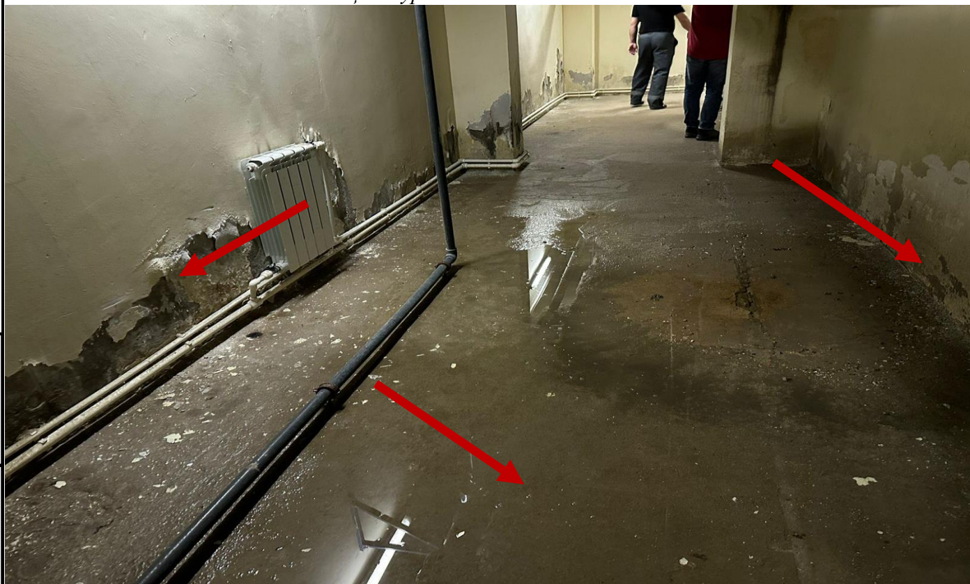
Фото 8. Подвал под чашей бассейна. Следы повсеместного намокания стен. Протечки канализации
