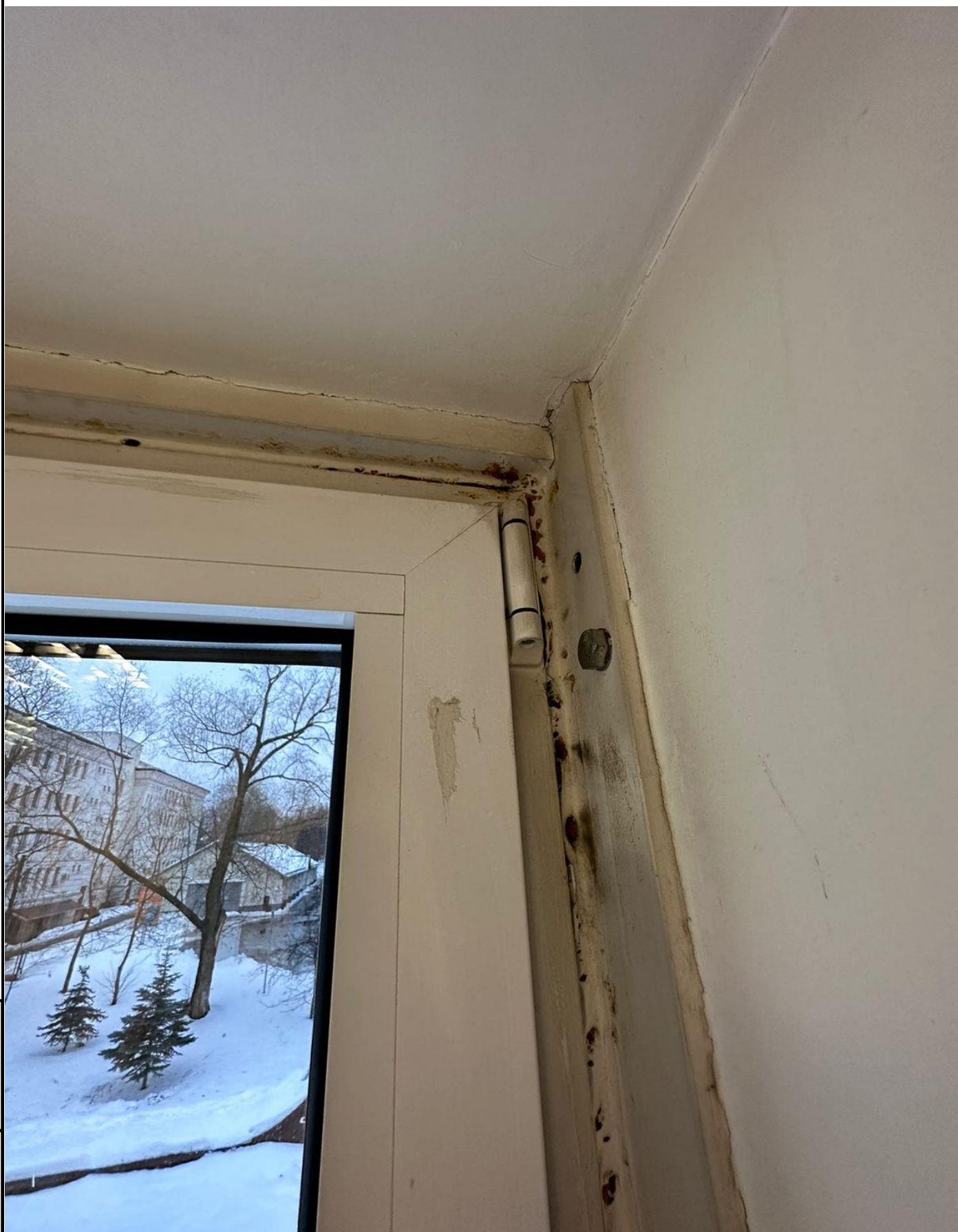
Фото 39. Первый этаж. коридор. Образование грибка(плесени)на соединении Рамы ПВХ и металлического откоса. Монтаж окно не соответствует ГОСТ 30971-2012 «Швы монтажные»
