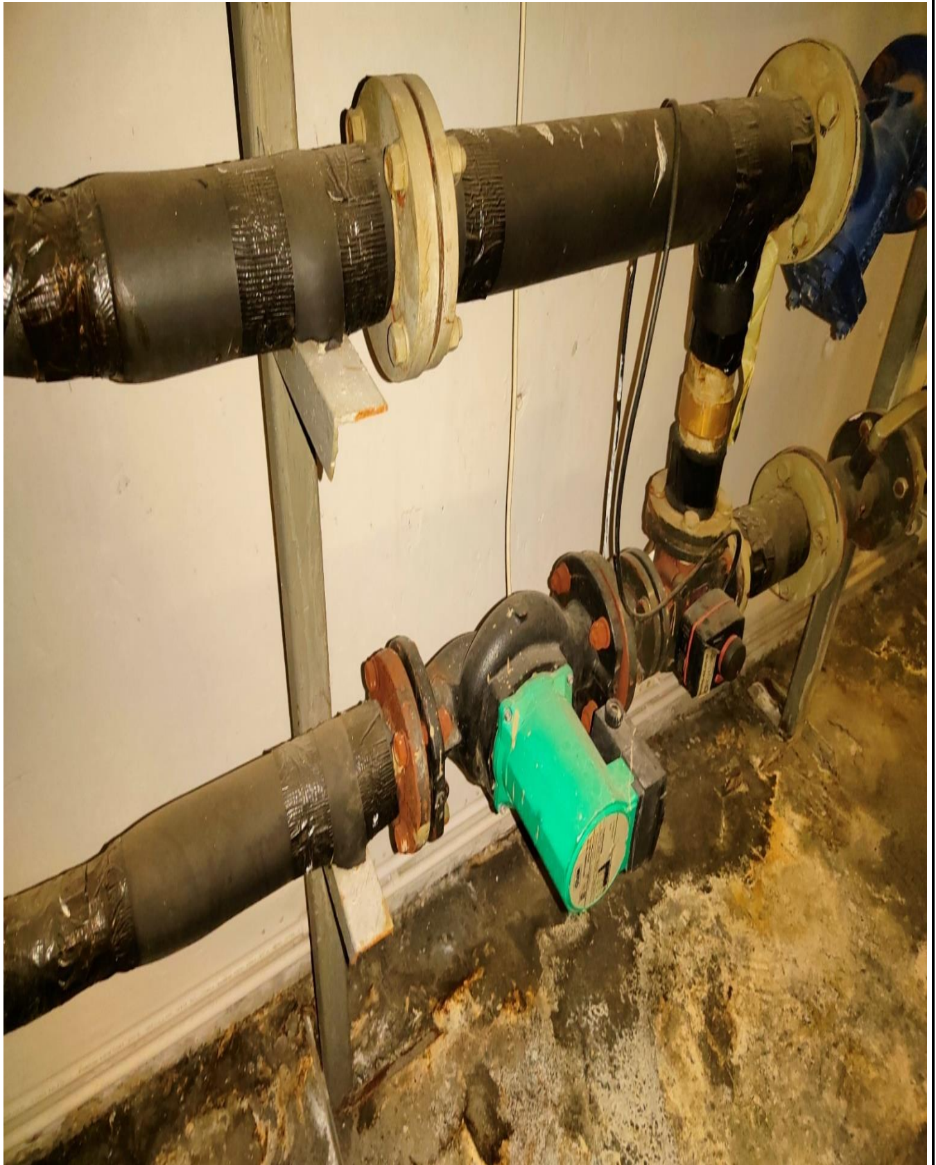
Фото 26. Коррозия фланцев и фланцевых болтов трубопроводов.
