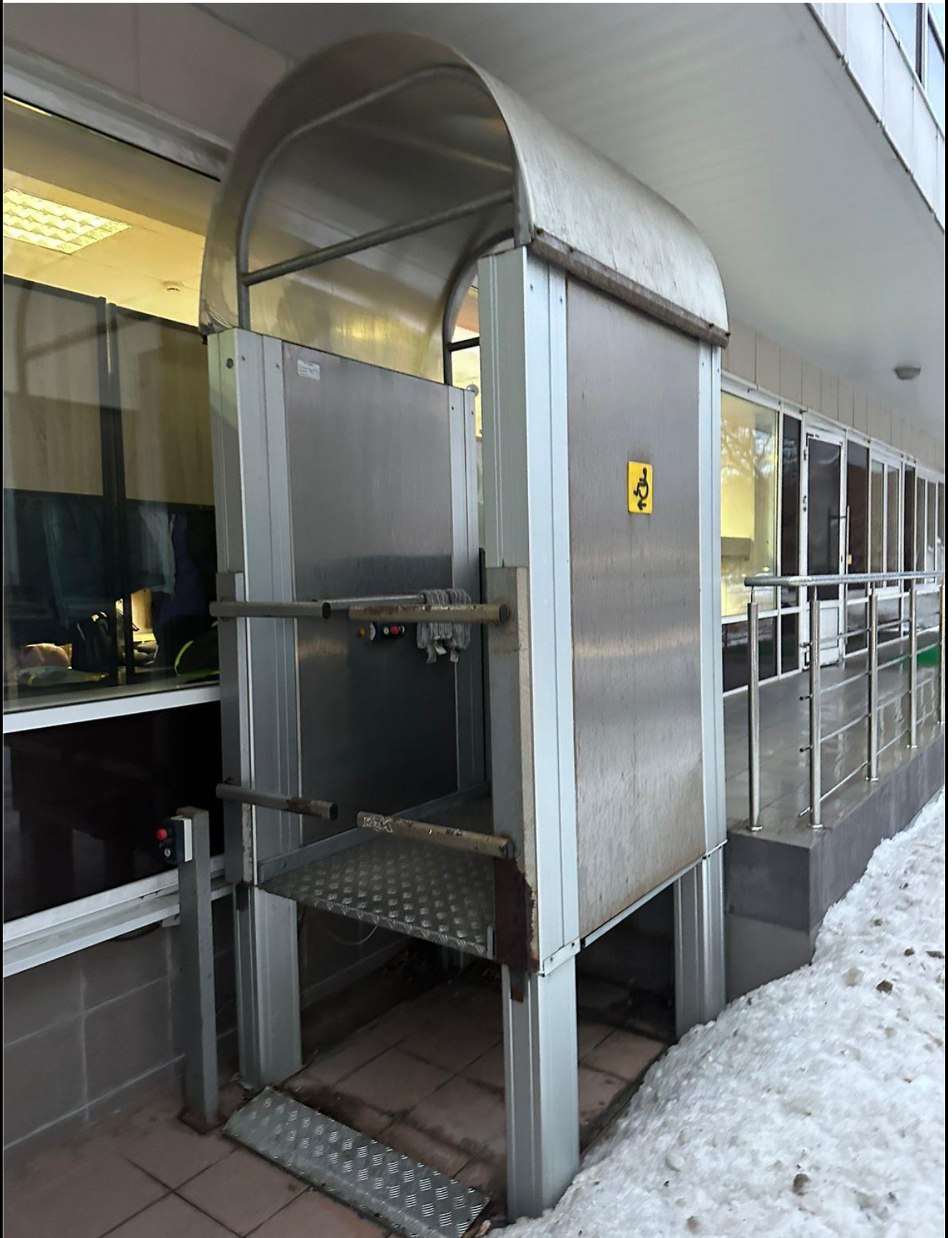
Фото 69. Фасад. Коррозия металлических элементов электроподъёмника для инвалидов
