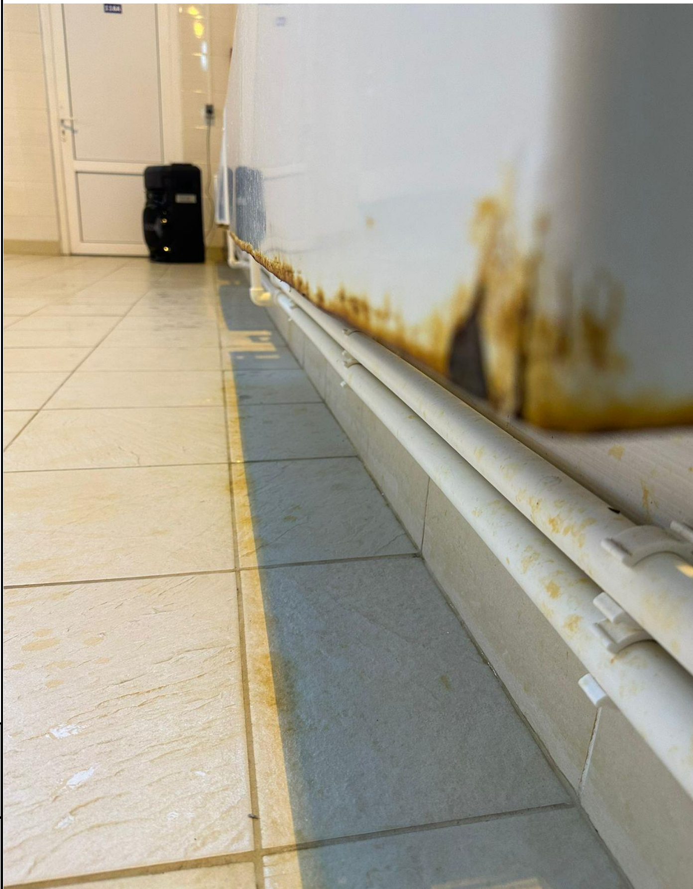
Фото 37. Первый этаж. Зона бассейна. Коррозия металлических кожухов радиаторов системы отопления. Высокая влажность воздуха более 100%. Система осушения не работает.
