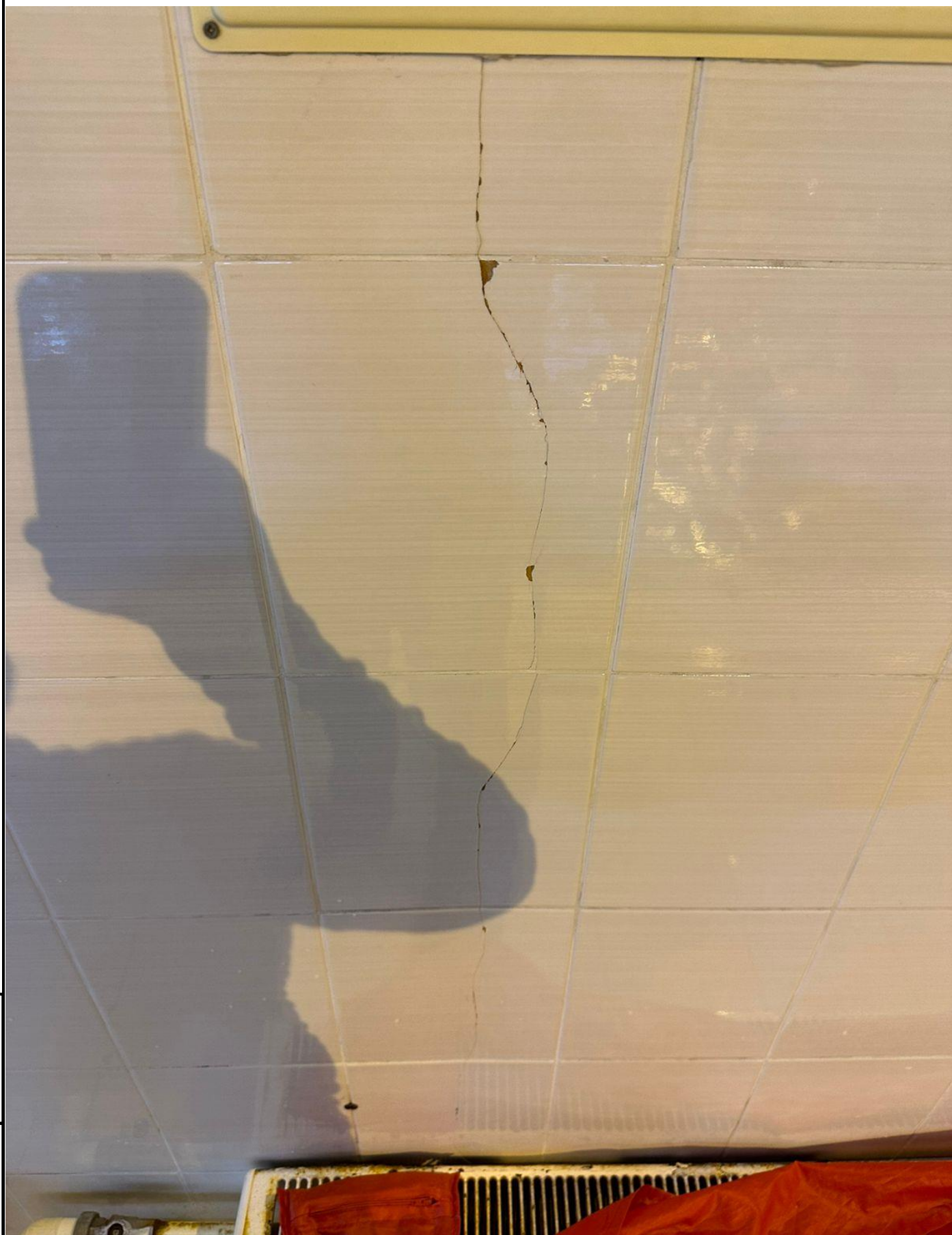
Фото 33. Первый этаж. Зона бассейна., Трещины в местах стыка ГКЛВ
