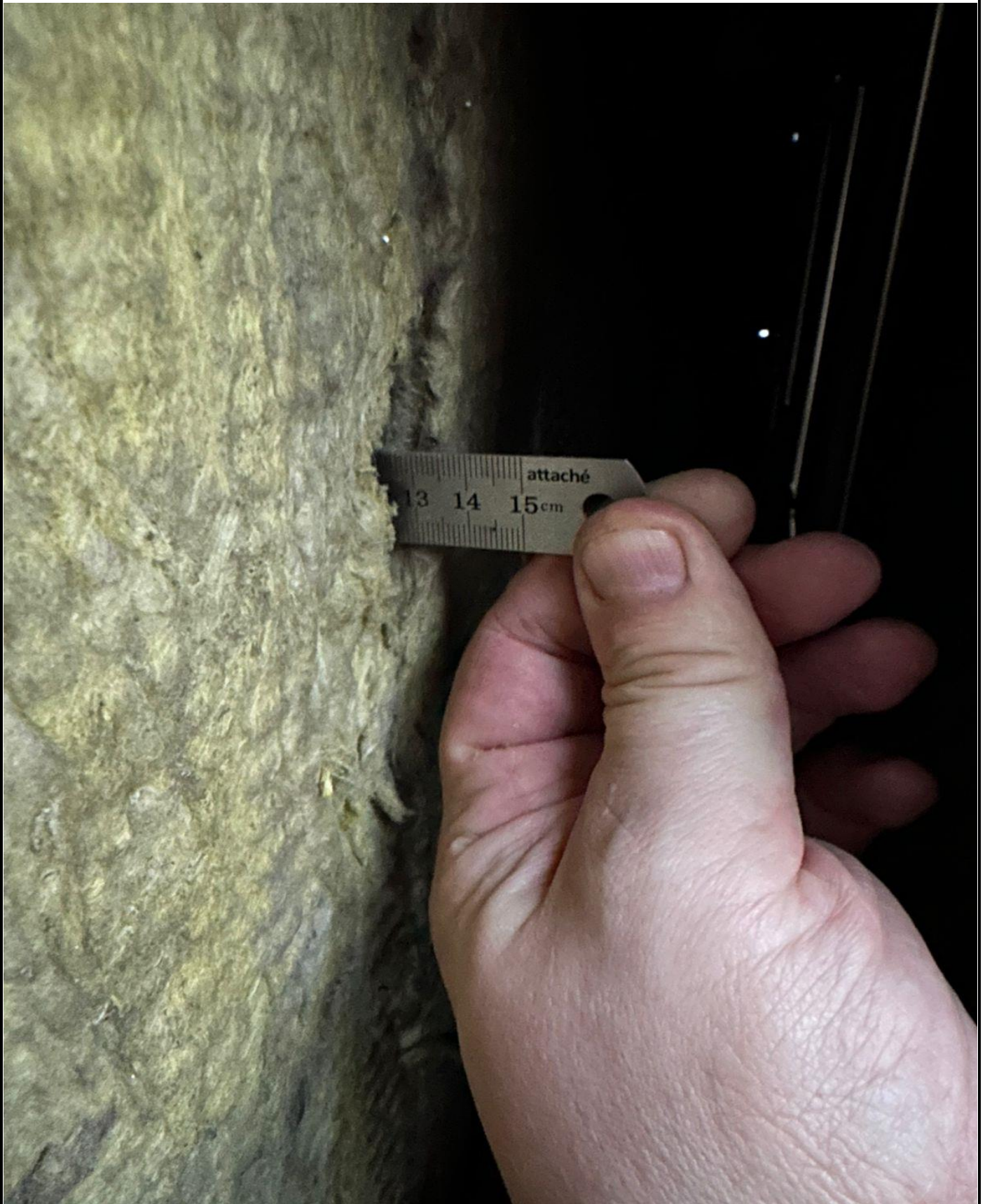
Фото 67. Фасад. Утепление наружных стен не соответствует РД на строительство. Вместо утеплителя 200мм фактически 130мм.
