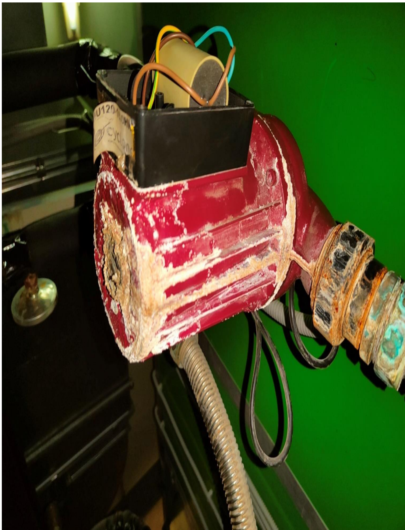
Фото 24. Вышедший из строя циркуляционный насос теплообменника приточной установки.
