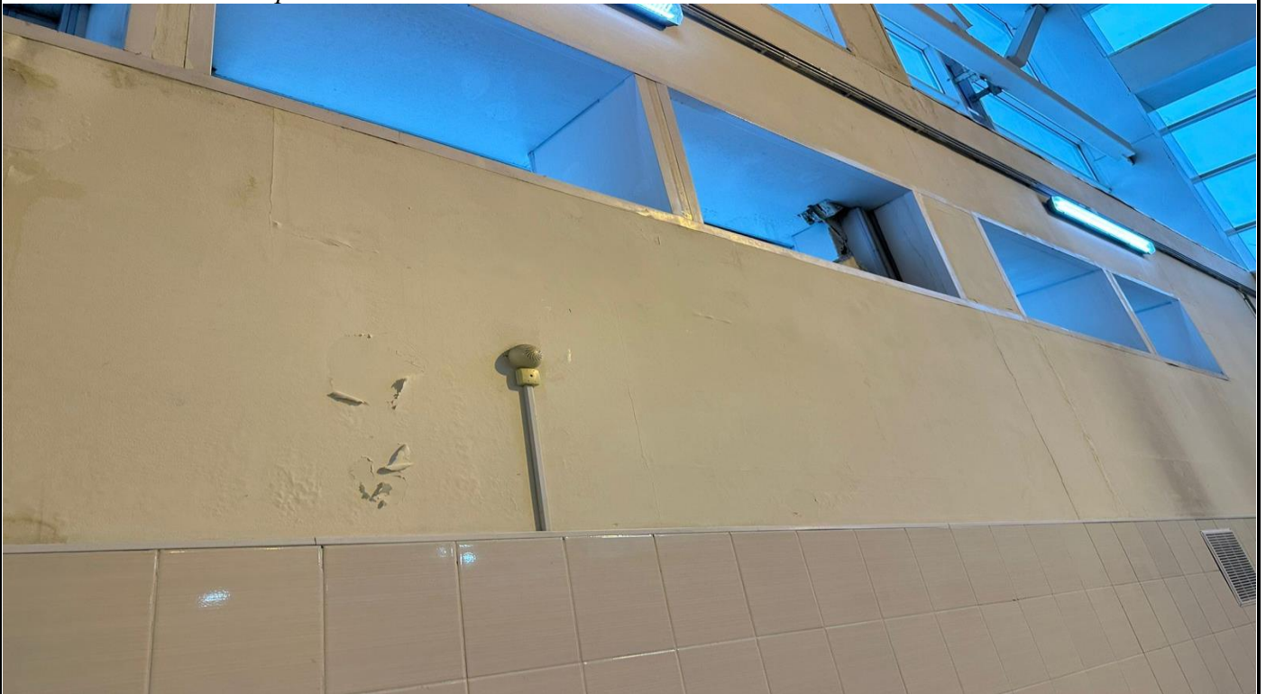
Фото 31. Первый этаж. Зона бассейна. Подтеки конденсата от стеклопакетов
