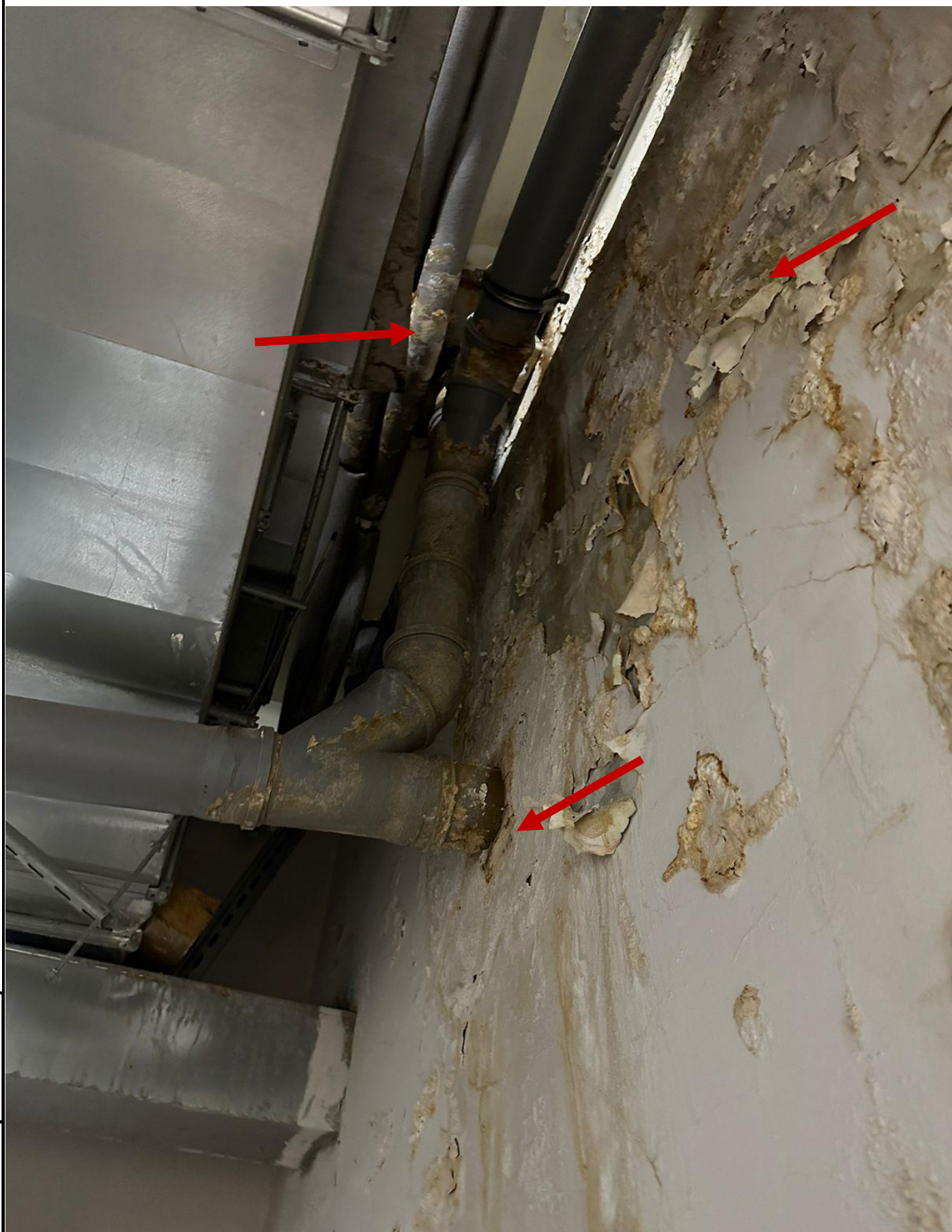
Фото 9. Подвал под чашей бассейна. Следы повсеместного намокания стен. Протечки канализации
