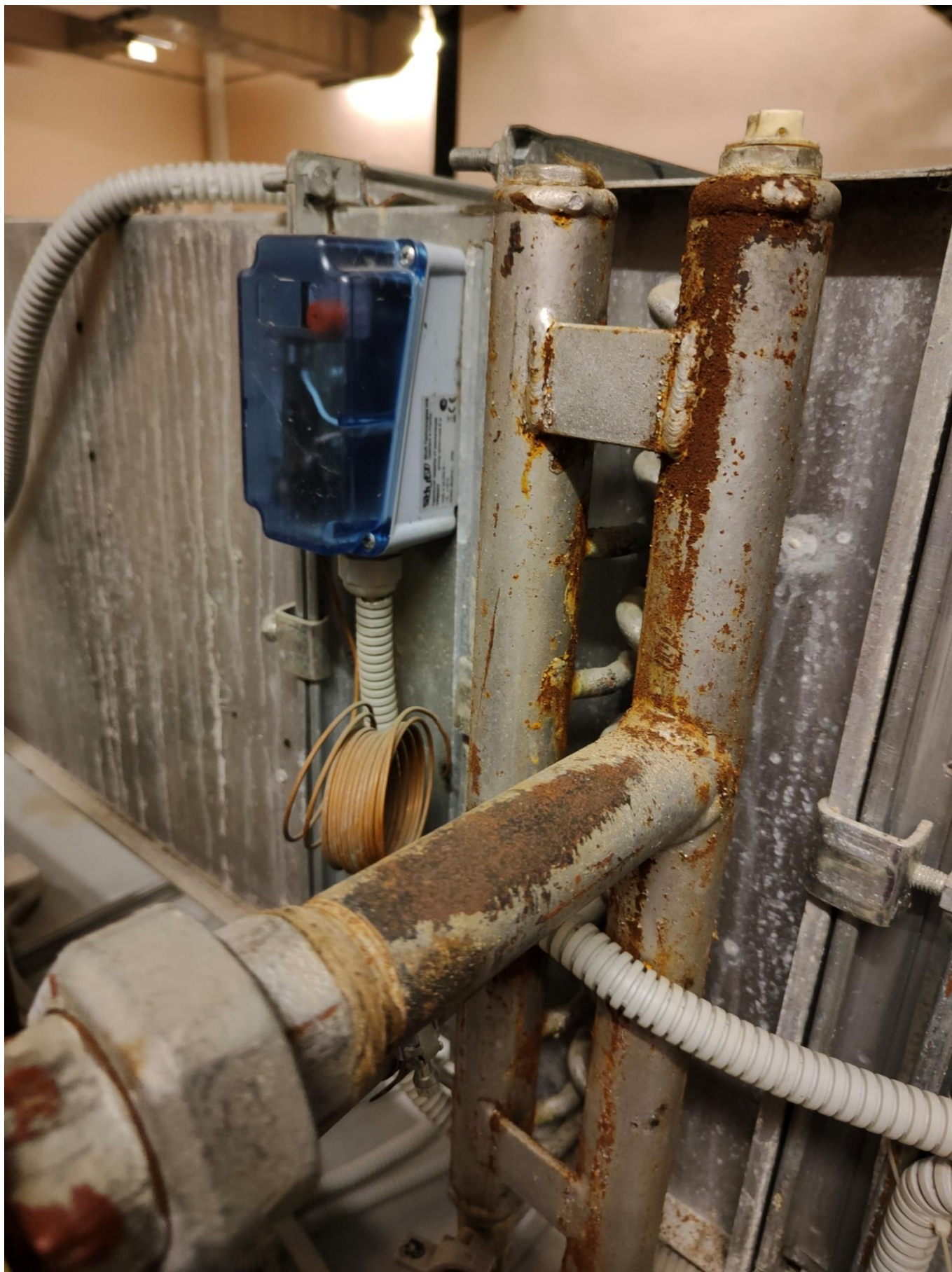
Фото 54. Следы коррозии на теплообменниках калориферов приточных установок.
