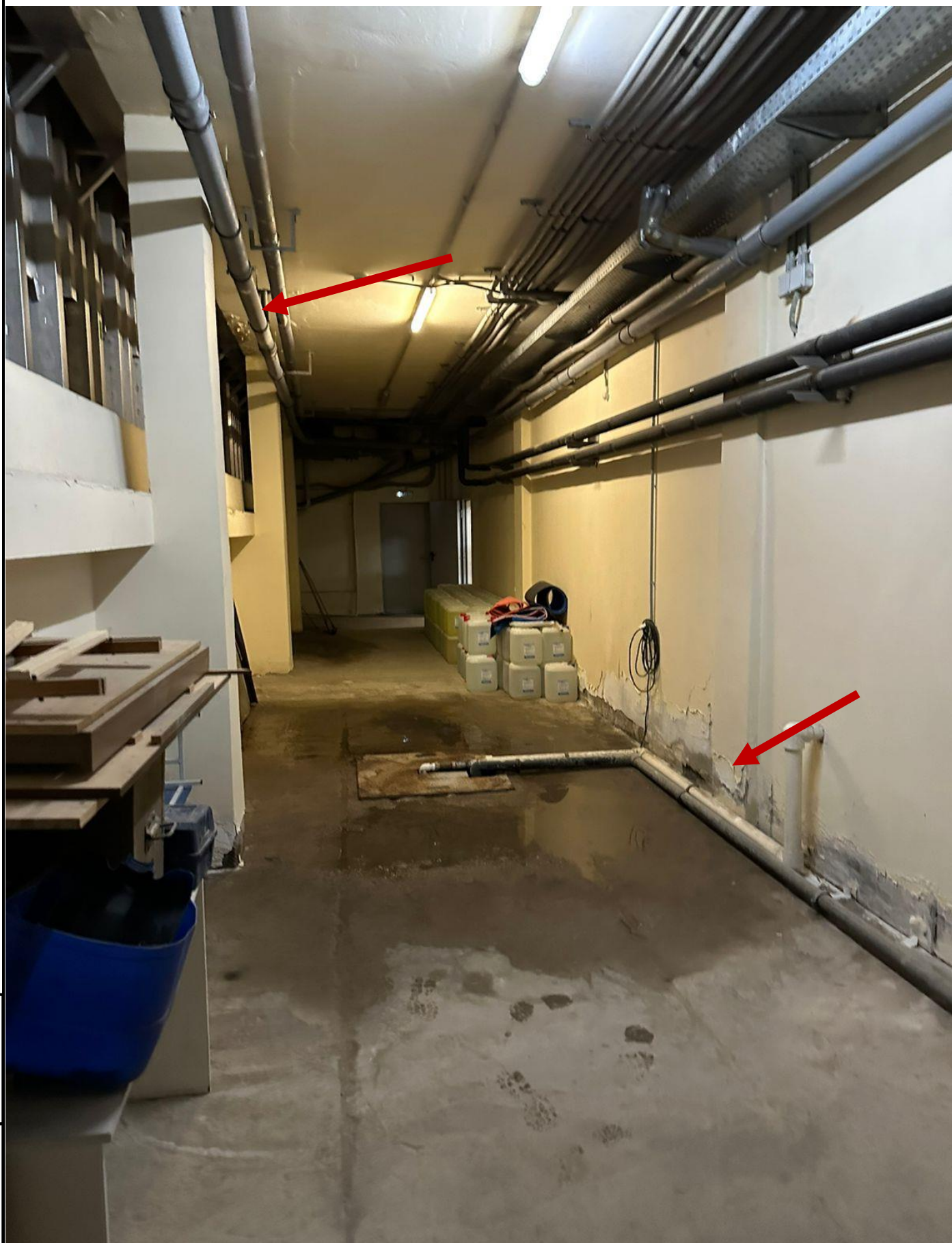
Фото 3. Подвал под чашей бассейна. Следы повсеместного намокания стен. Протечки канализации
