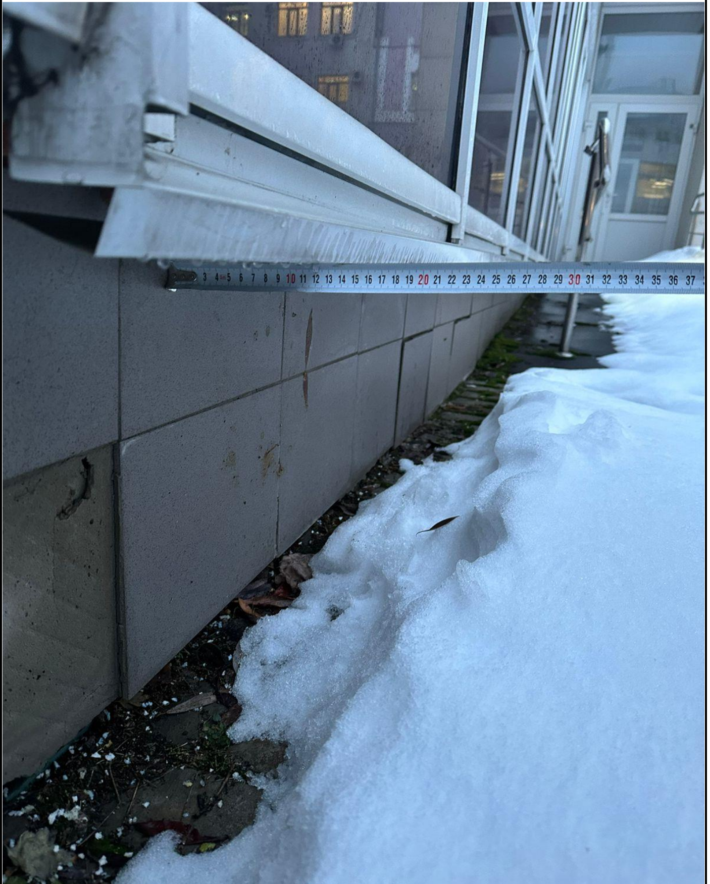
Фото 70. Фасад. Вылет светопрозрачных конструкций за плоскость цоколя на 100мм. Вследствие чего, промерзание откосов 1 этажа.
