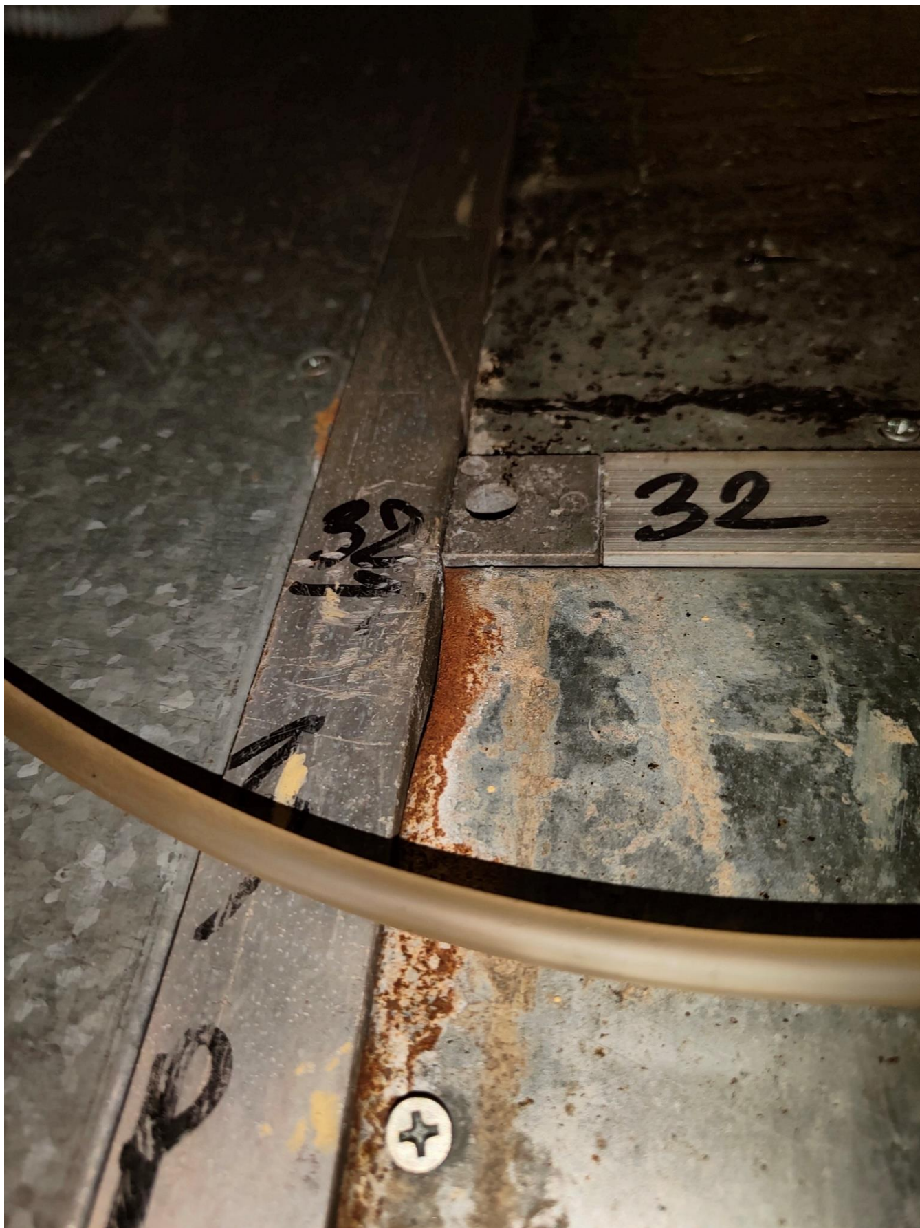
Фото 28. Коррозия корпусов приточных установок.
