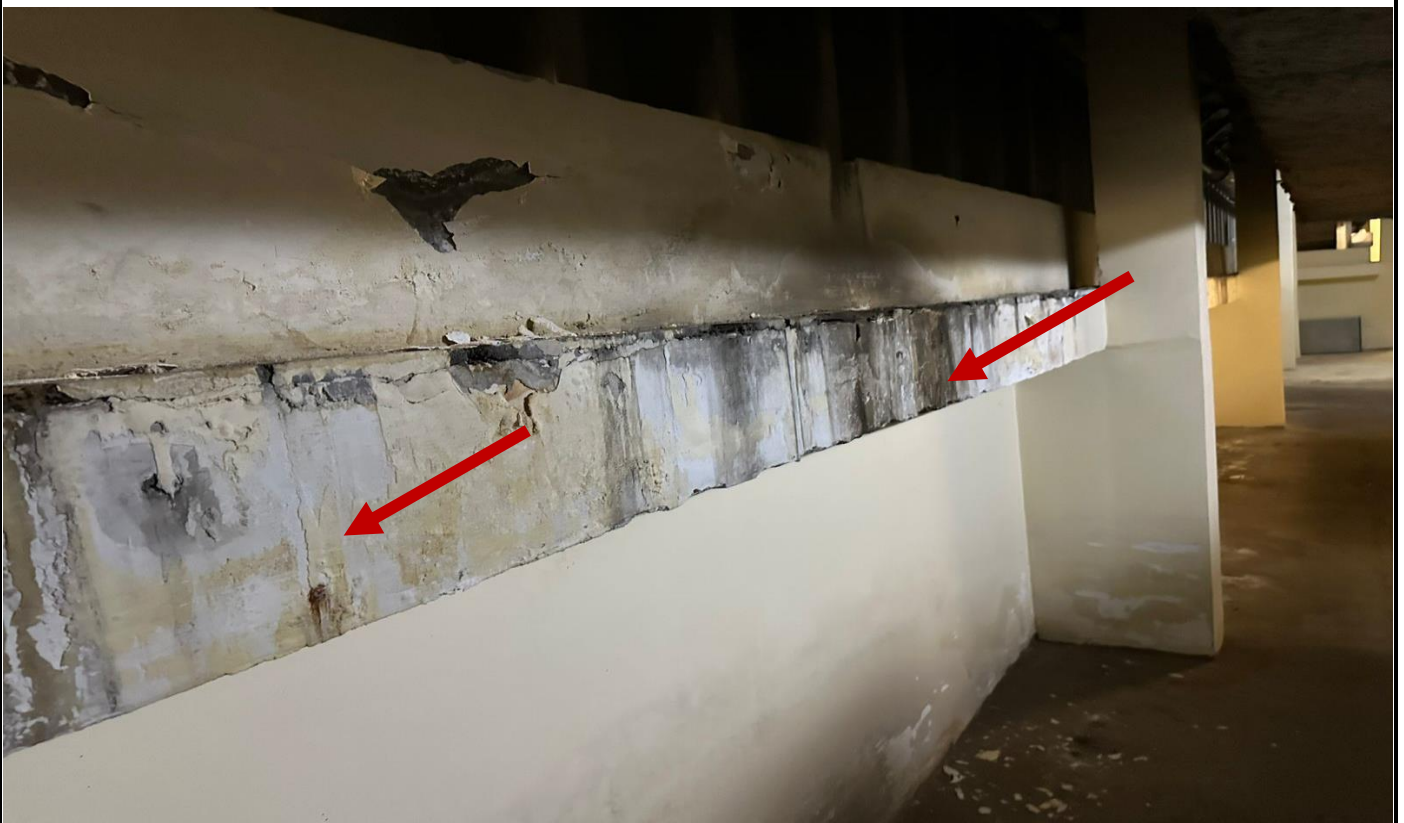
Фото 5. Подвал под чашей бассейна. Следы повсеместного намокания стен. Протечки канализации
