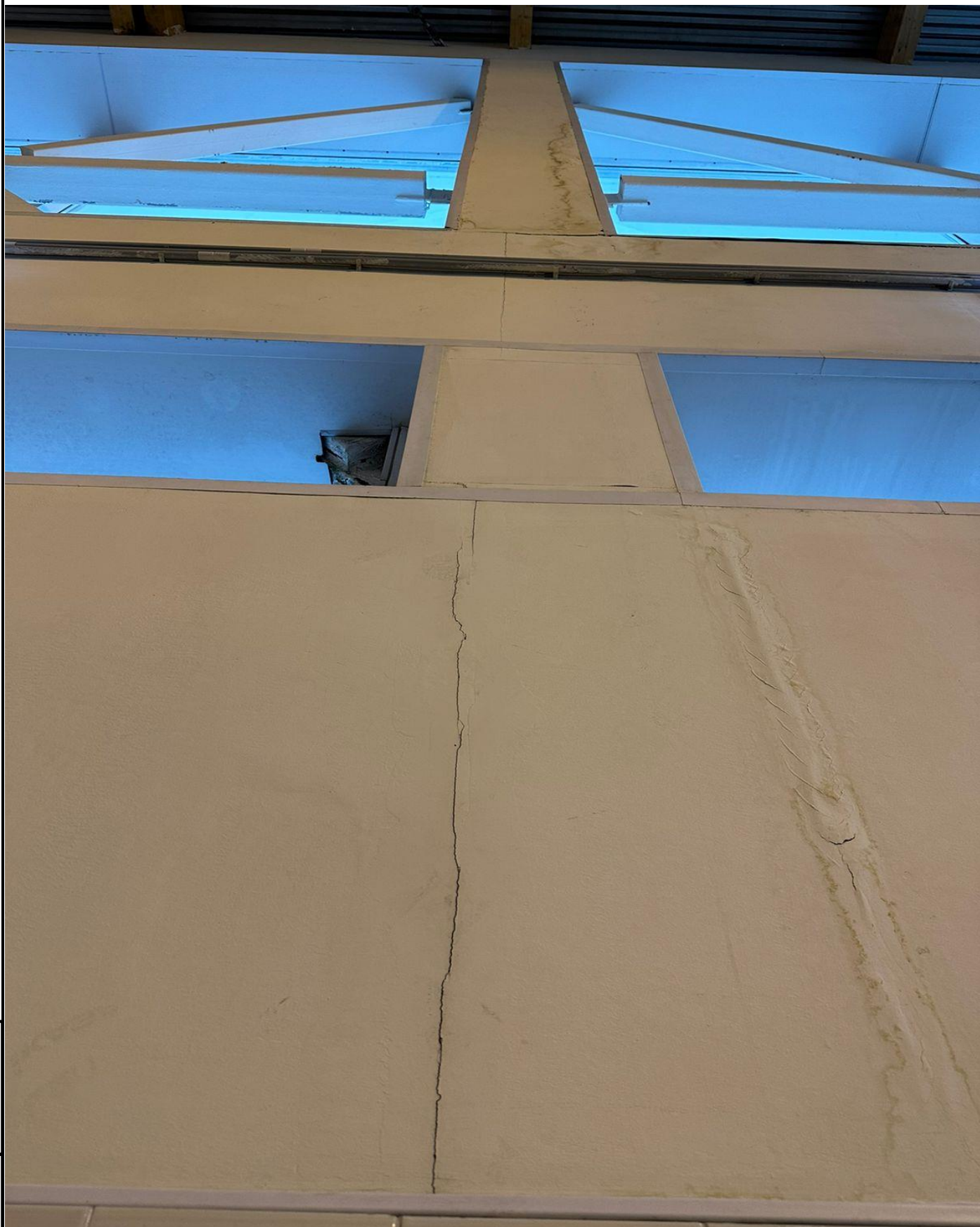
Фото 32. Первый этаж. Зона бассейна. Подтеки конденсата от стеклопакетов, Трещины в местах стыка ГКЛВ
