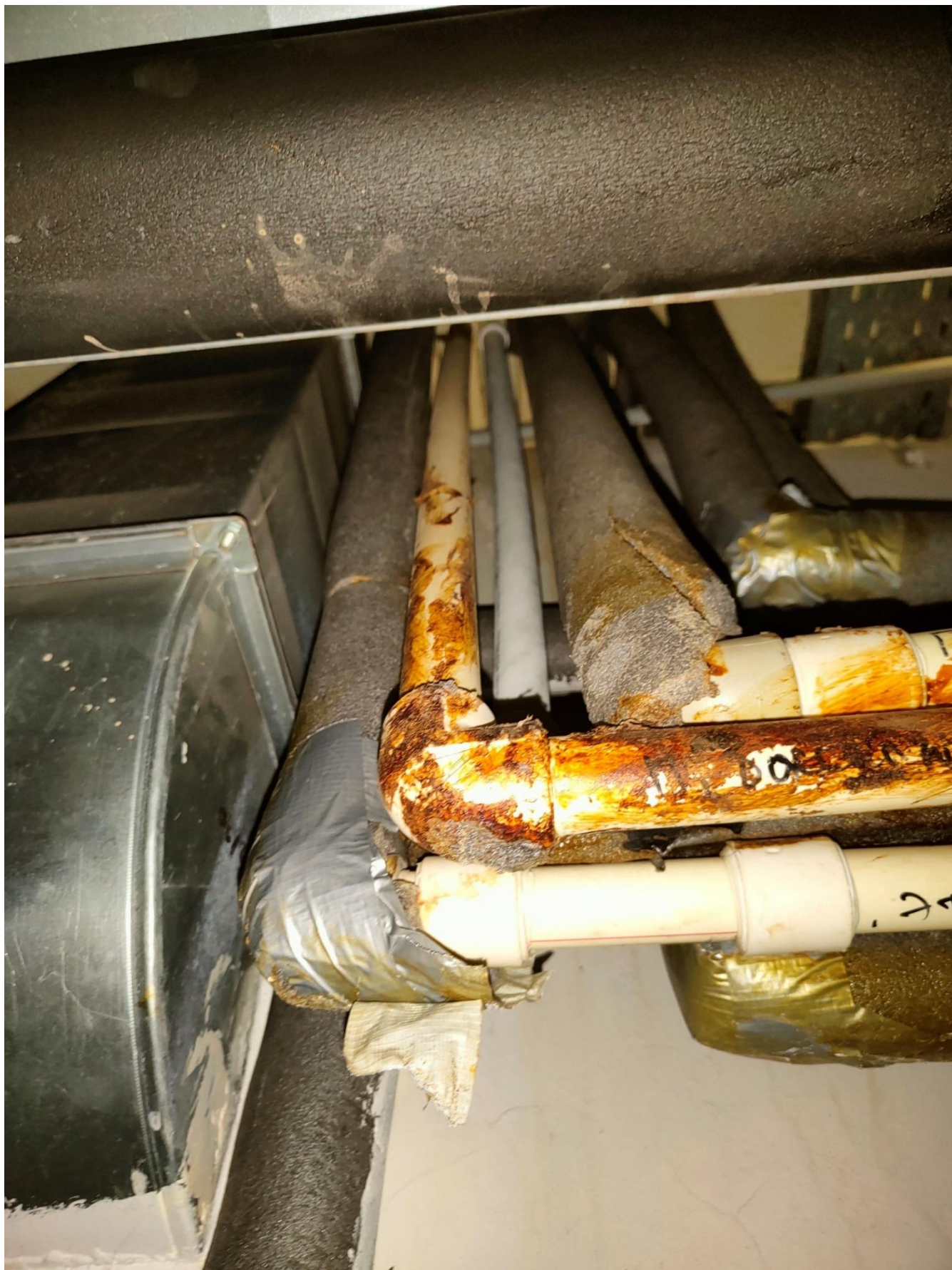
Фото 18. Горизонтальная разводка трубопроводов под потолком подвала имеет следы коррозии, даже на пластиковых трубопроводах.
