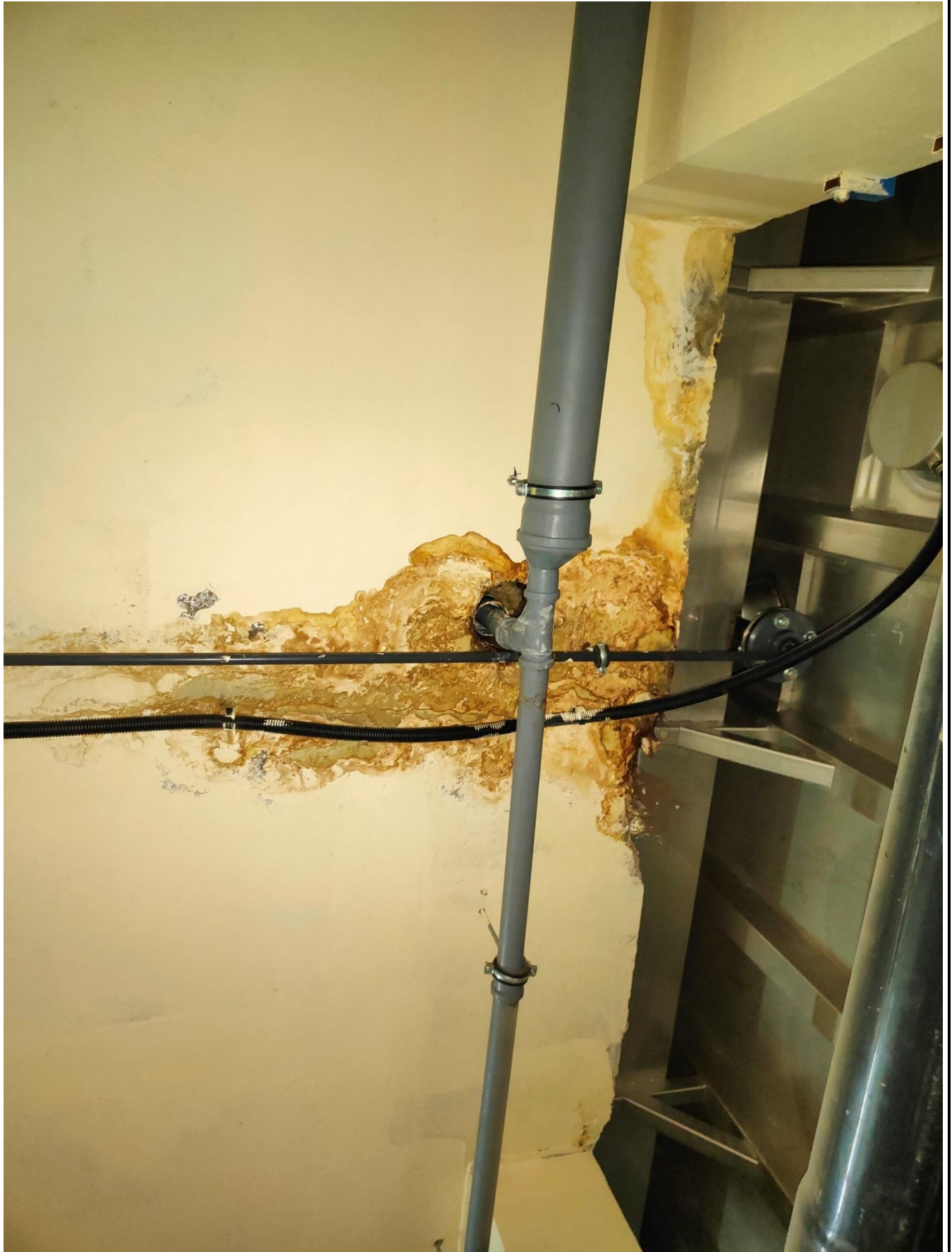
Фото 12. Течи вокруг трапов обходных дорожек чаши бассейна.
