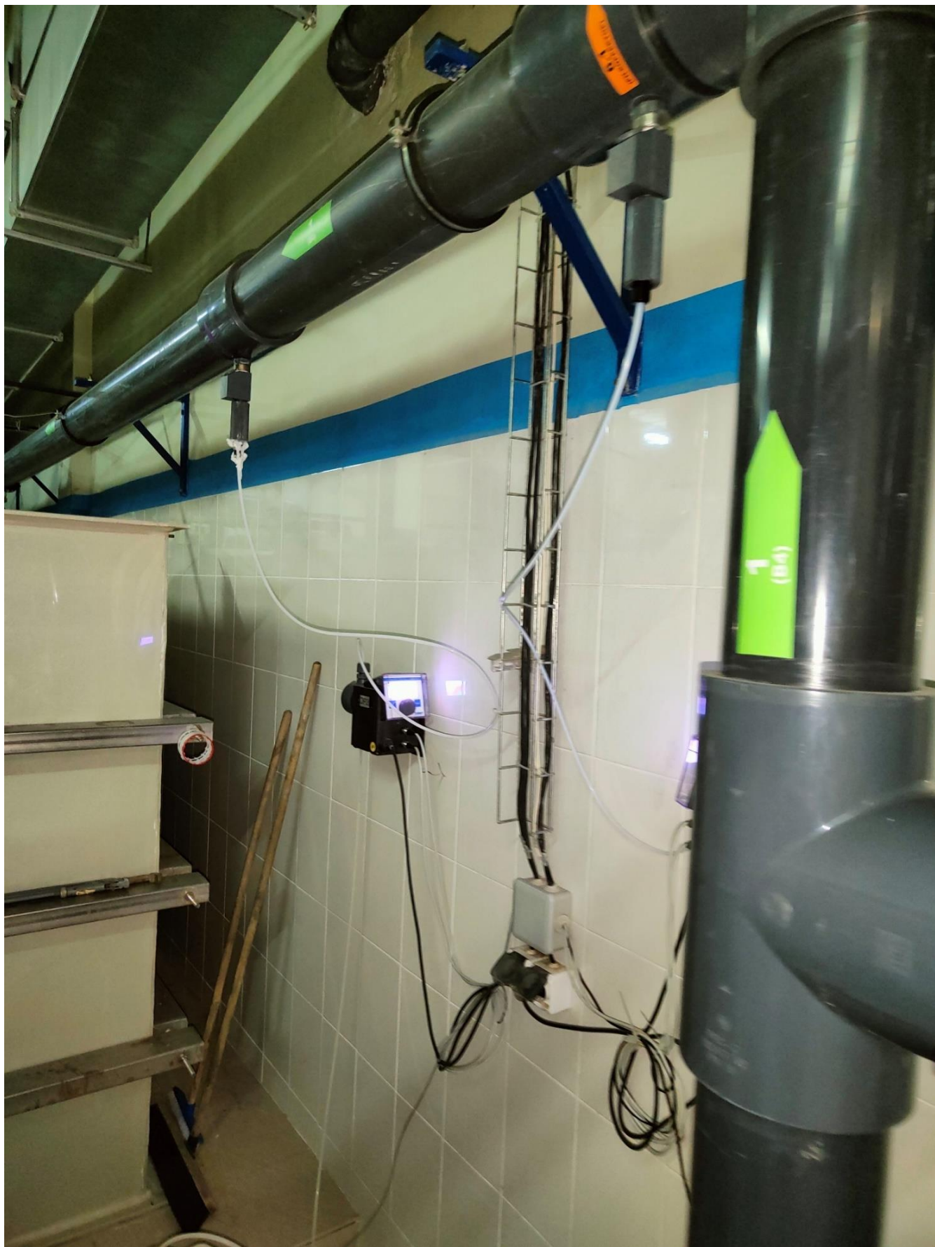
Фото 10. Течи реагента системы водоподготовки.
