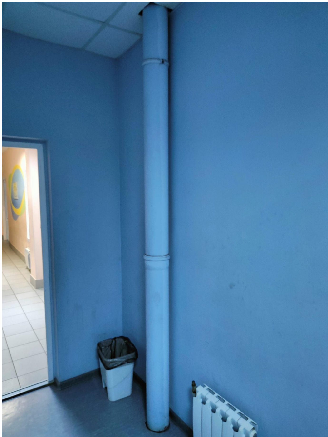
Фото 44. Отсутствие теплоизоляции на стояках ливневой канализации.
