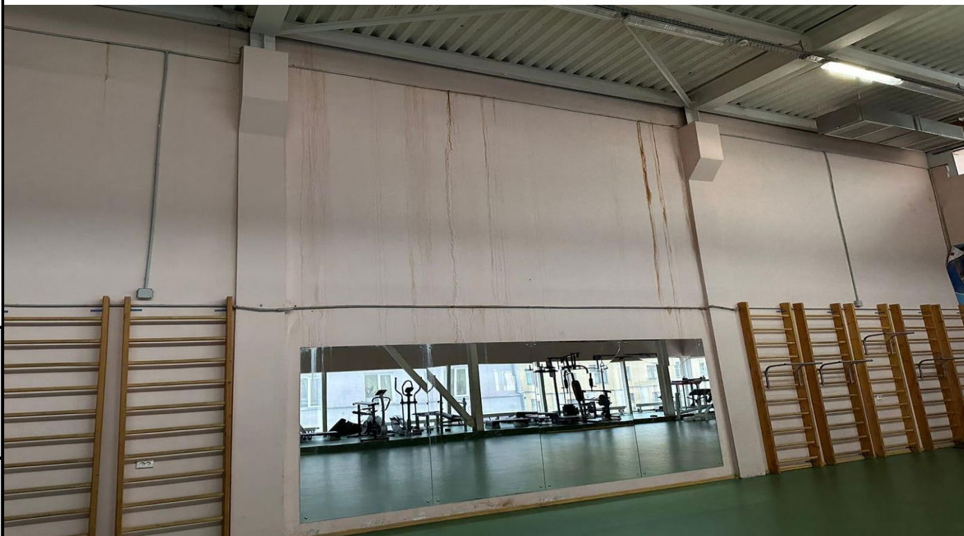
Фото 43. Второй этаж. Спортивный зал. Намокание стены от протечек кровли
