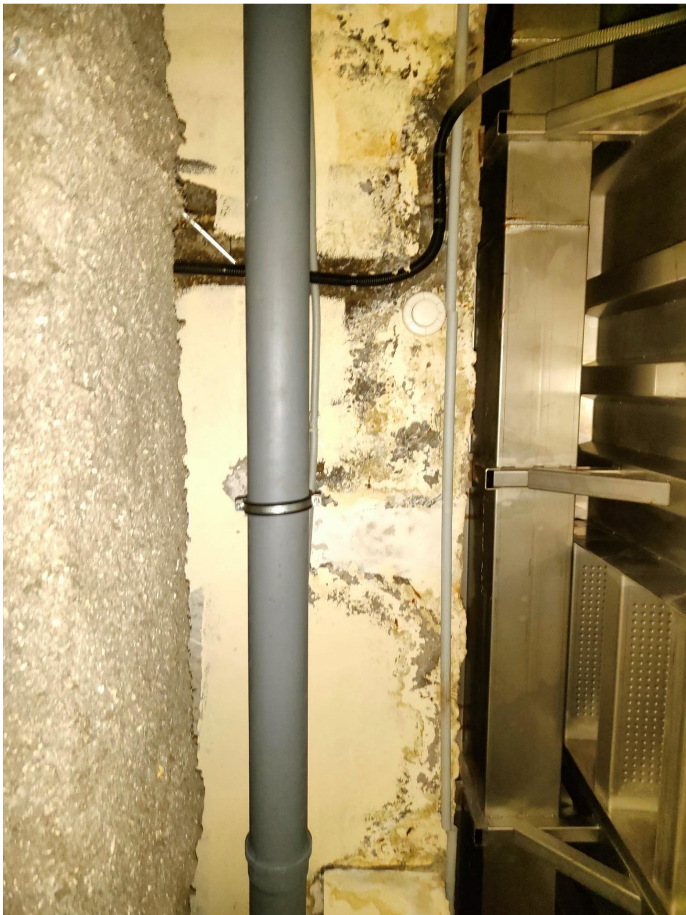
Фото 15. Из-за протечки дренажных трапов залив пожарных извещателей водой.
