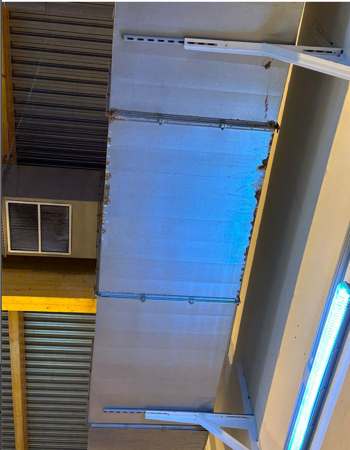
Фото 34. Первый этаж. Зона бассейна. Коррозия воздуховодов. Высокая влажность воздуха более 100%. Система осушения не работает.
