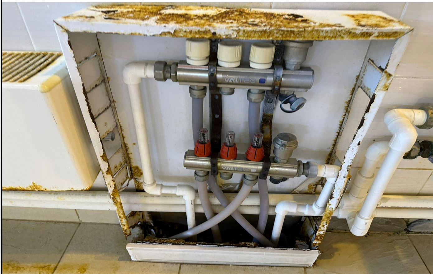
Фото 35. Первый этаж. Зона бассейна. Коррозия шкафов распределительной системы отопления. Высокая влажность воздуха более 100%. Система осушения не работает.
