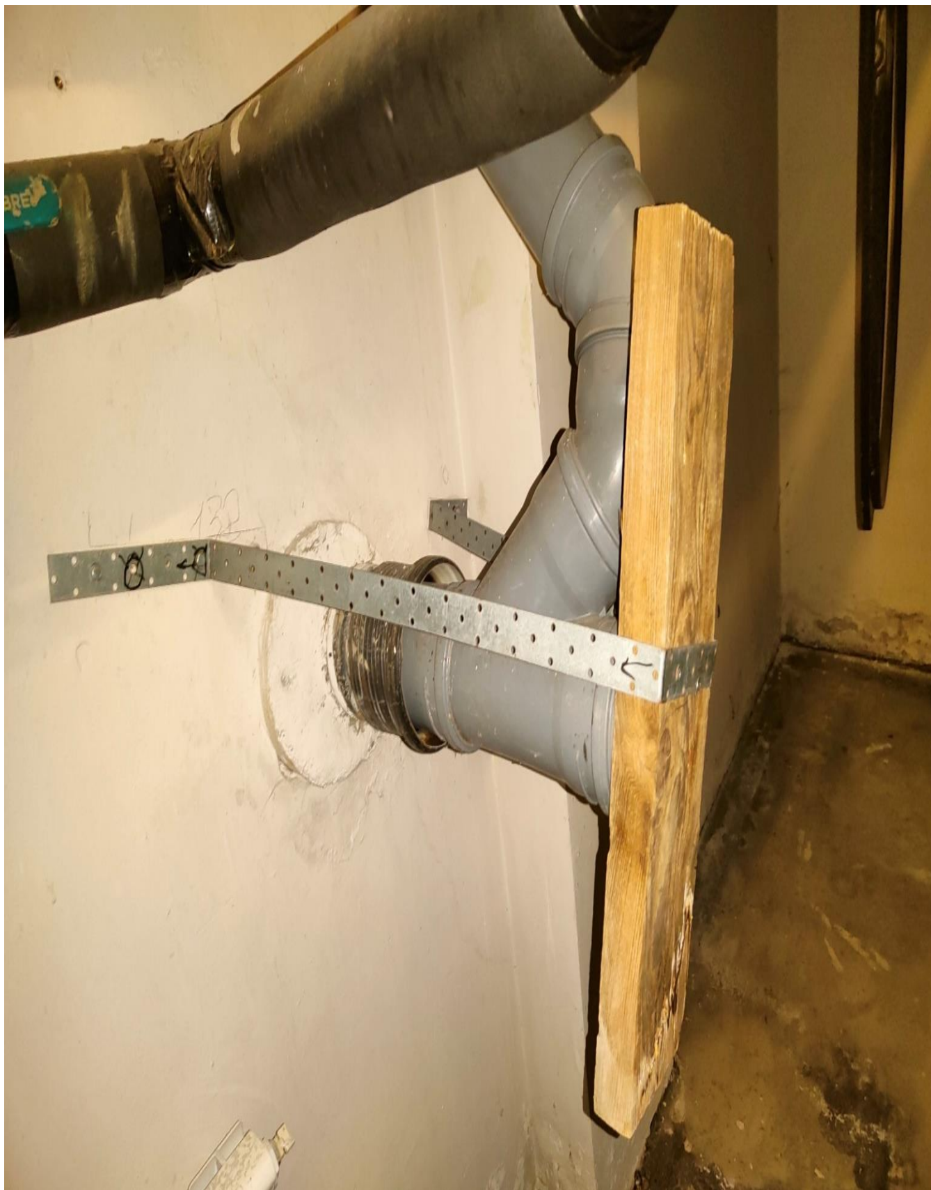
Фото 27. Выдавливание не напорных трубопроводов в месте присоединения к наружным магистралям канализации.
