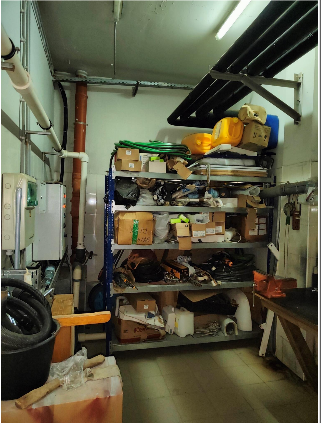
Фото 20. Захламление помещения КНС.
