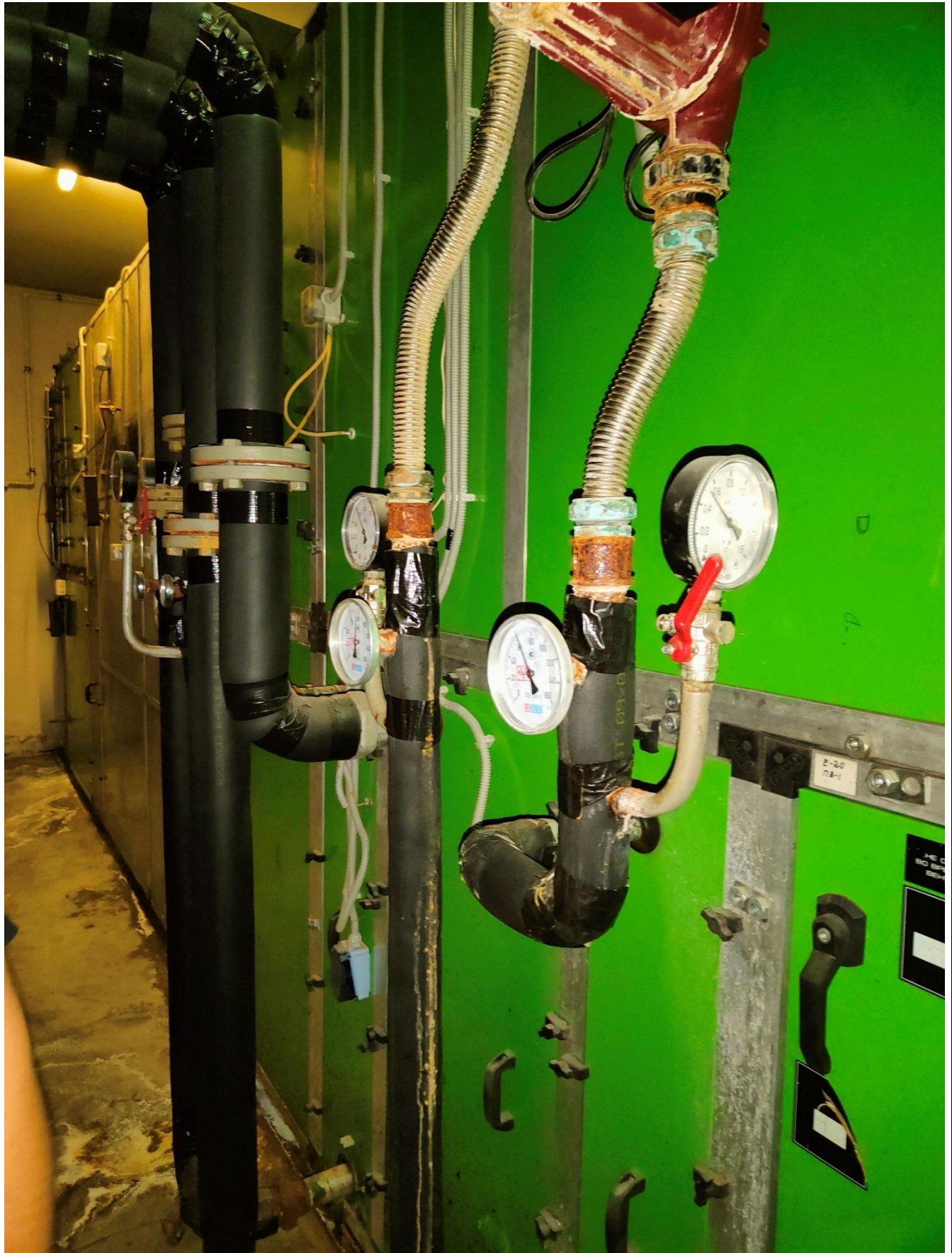
Фото 25. Коррозия соединительных муфт и сварных швов соединений трубопроводов.
