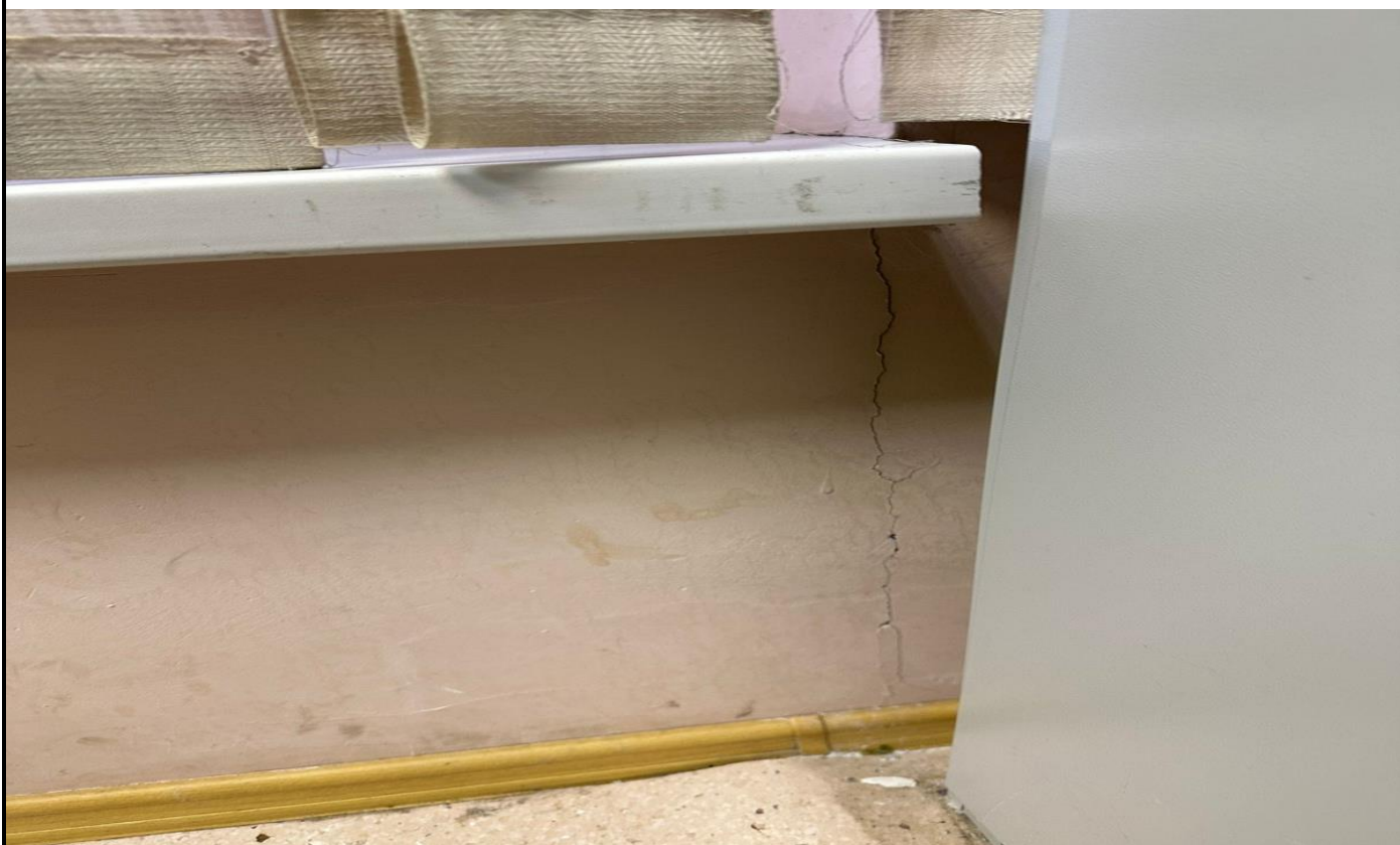
Фото 42. Первый этаж. коридор. Образование сквозных деформационных трещин в зоне сопряжения ГСБ \ монолит
