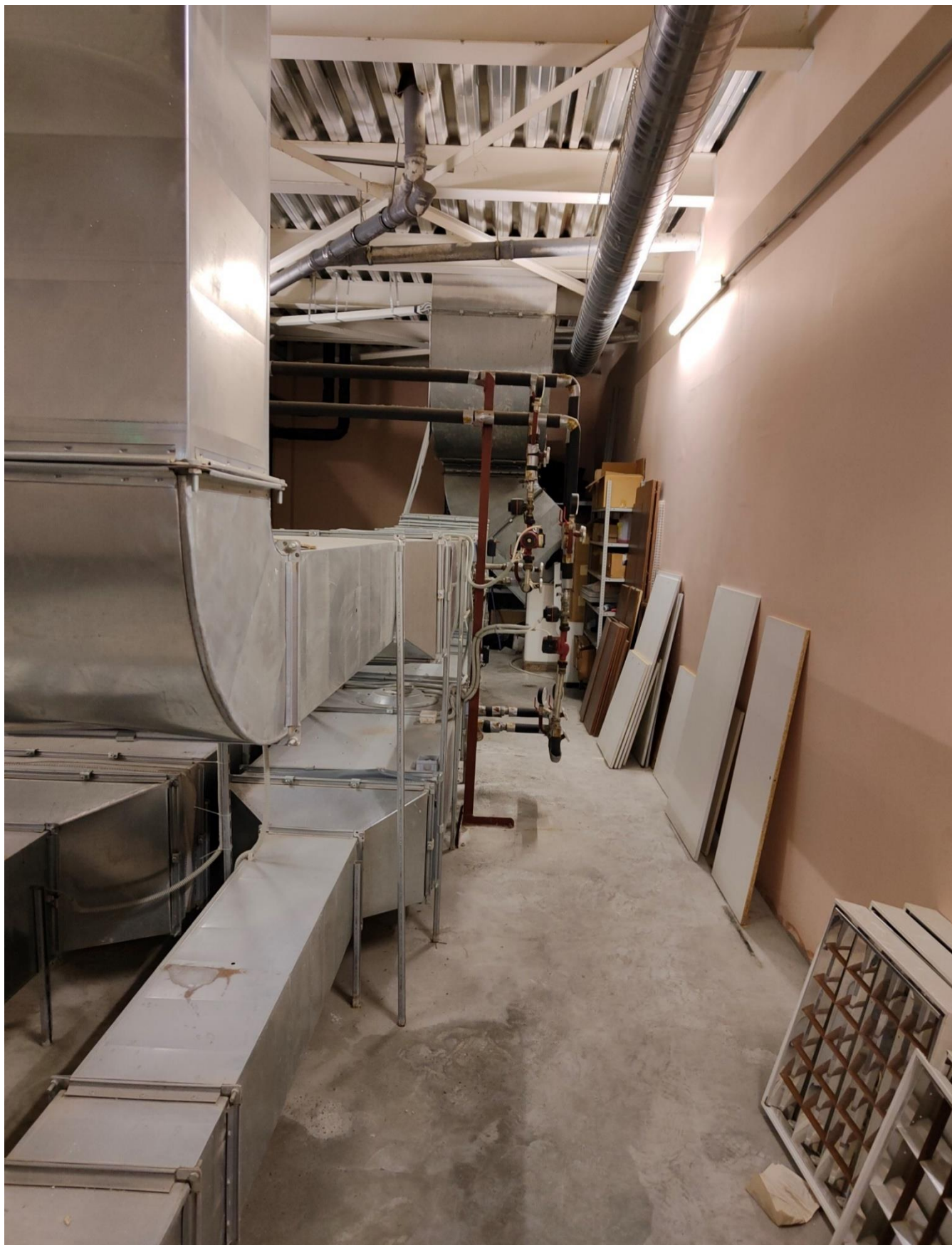
Фото 52. Отсутствие подогрева дренажных воронок и их подключение не напорным трубопроводом.
