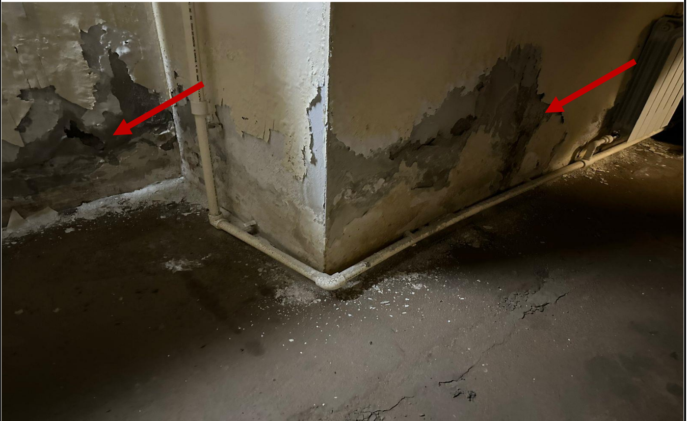
Фото 4. Подвал под чашей бассейна. Следы повсеместного намокания стен. Протечки канализации
