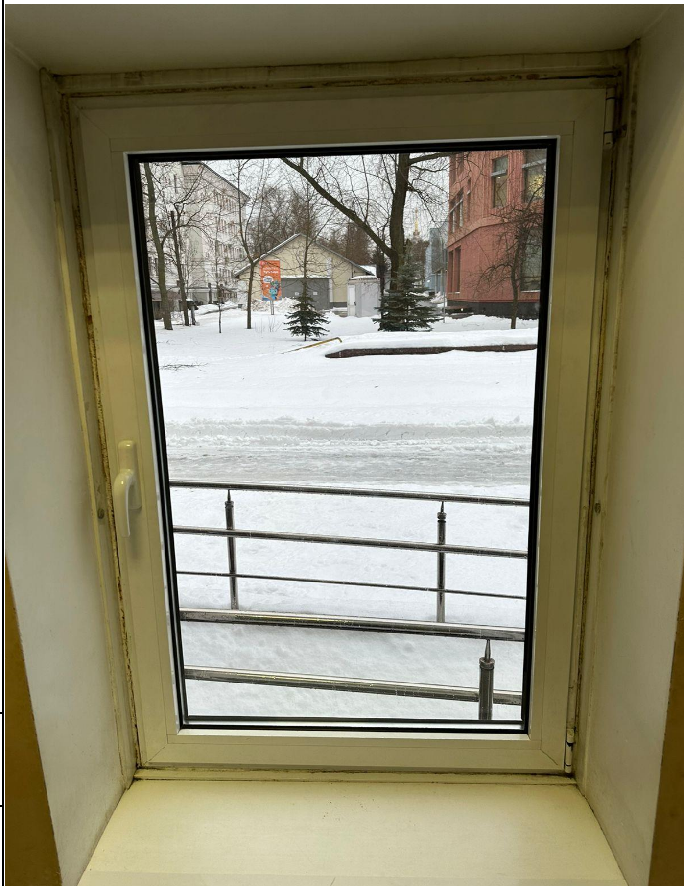
Фото 38. Первый этаж. коридор. Промерзание откосов. Отсутствует утепление откосов.
