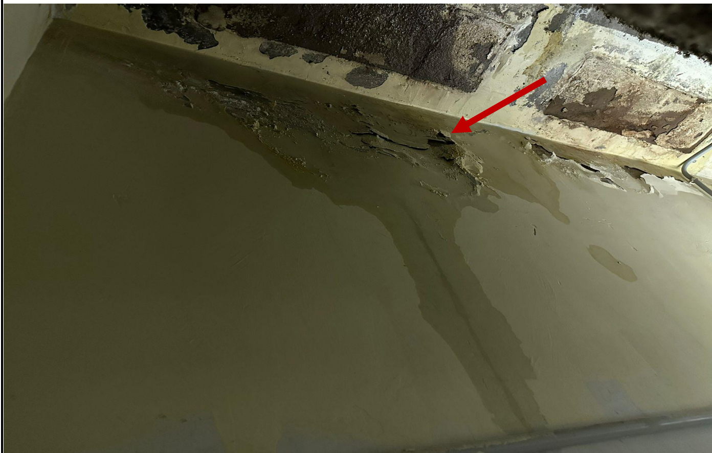
Фото 7. Подвал под чашей бассейна. Следы повсеместного намокания потолка и стен. Протечки канализации в уровне 1го этажа зона бассейна
