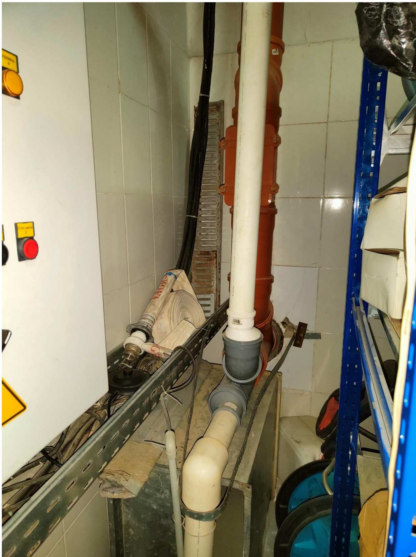
Фото 21. К выводам канализации из здания подключены не напорные вертикальные трубопроводы.
