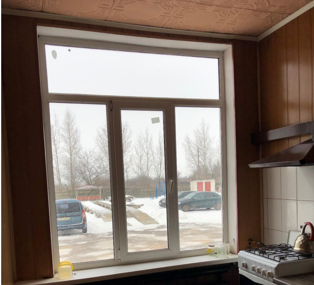
Дефекты: стекла запотевают, стеклопакеты не герметичны
