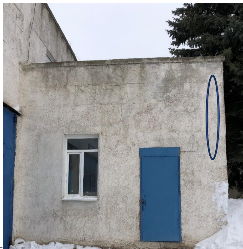
Микротрещины на штукатурке фасада здания
