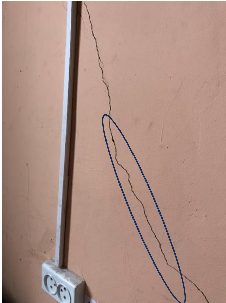
Фото 2.2 трещины на внутренней стене здания в осях 1 А-Б
