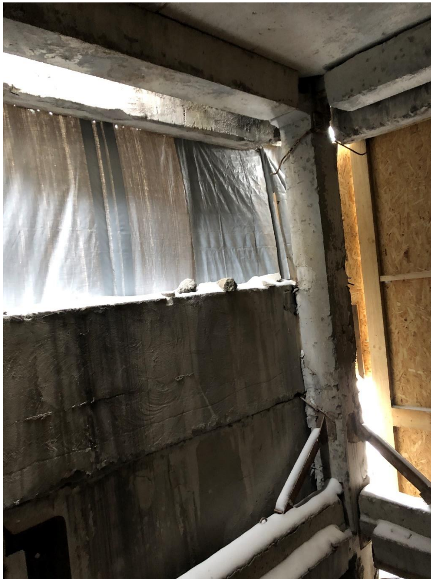
Разрушены стеновые панели
