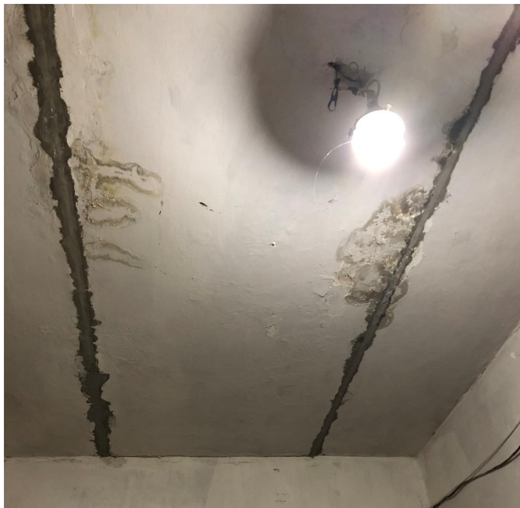
Фото имеются намокания на перекрытиях
