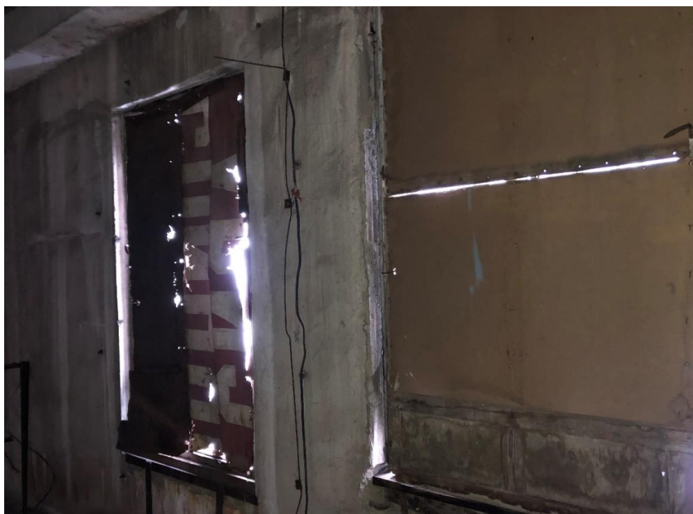
Фото: оконные блоки отсутствуют
