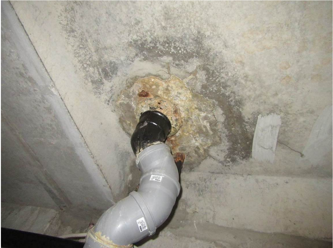
Фото №21. Следы протечек на нижней поверхности подвального перекрытия
