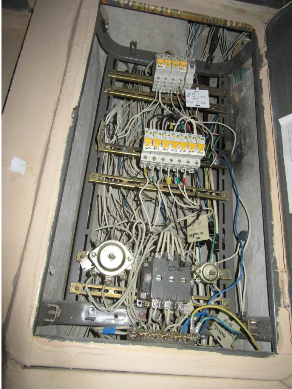
Фото 53. Щиты групповые на этажах.
