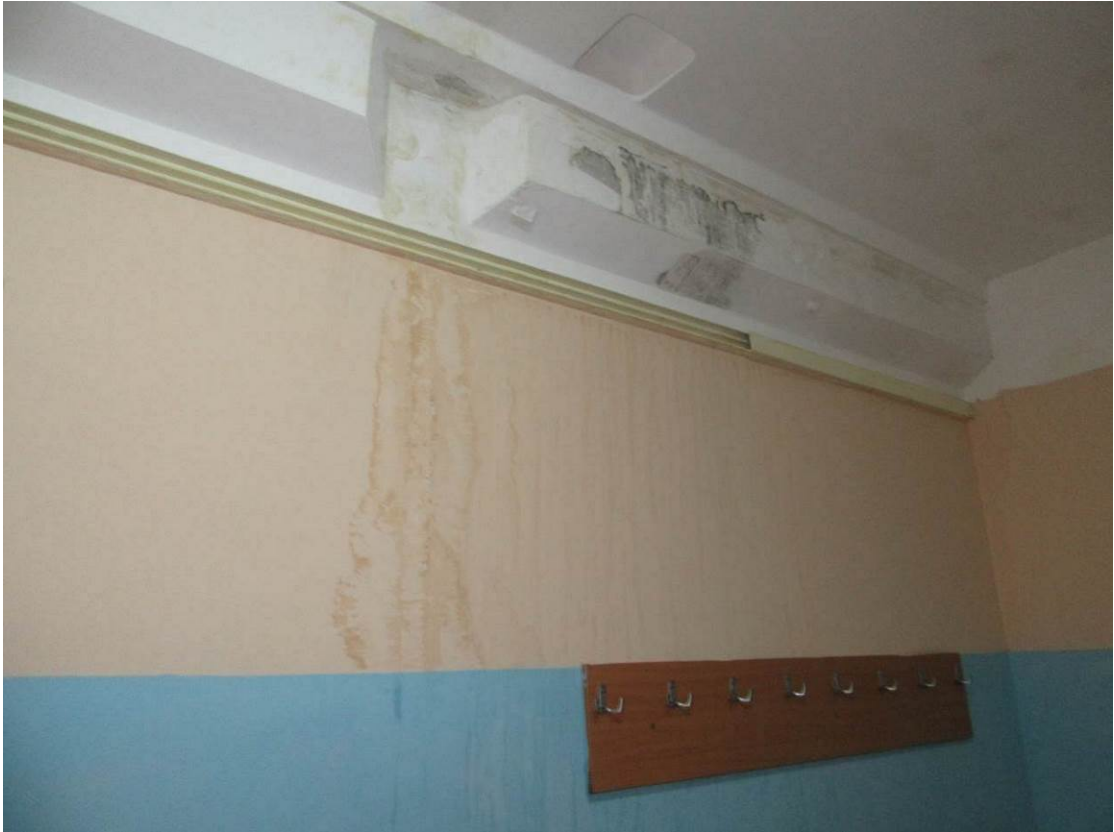
Фото №15. Замачивание и повреждение стен
