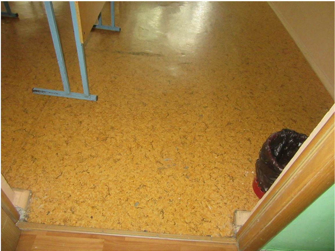
Фото №16. Повреждения линолеумного покрытия пола
