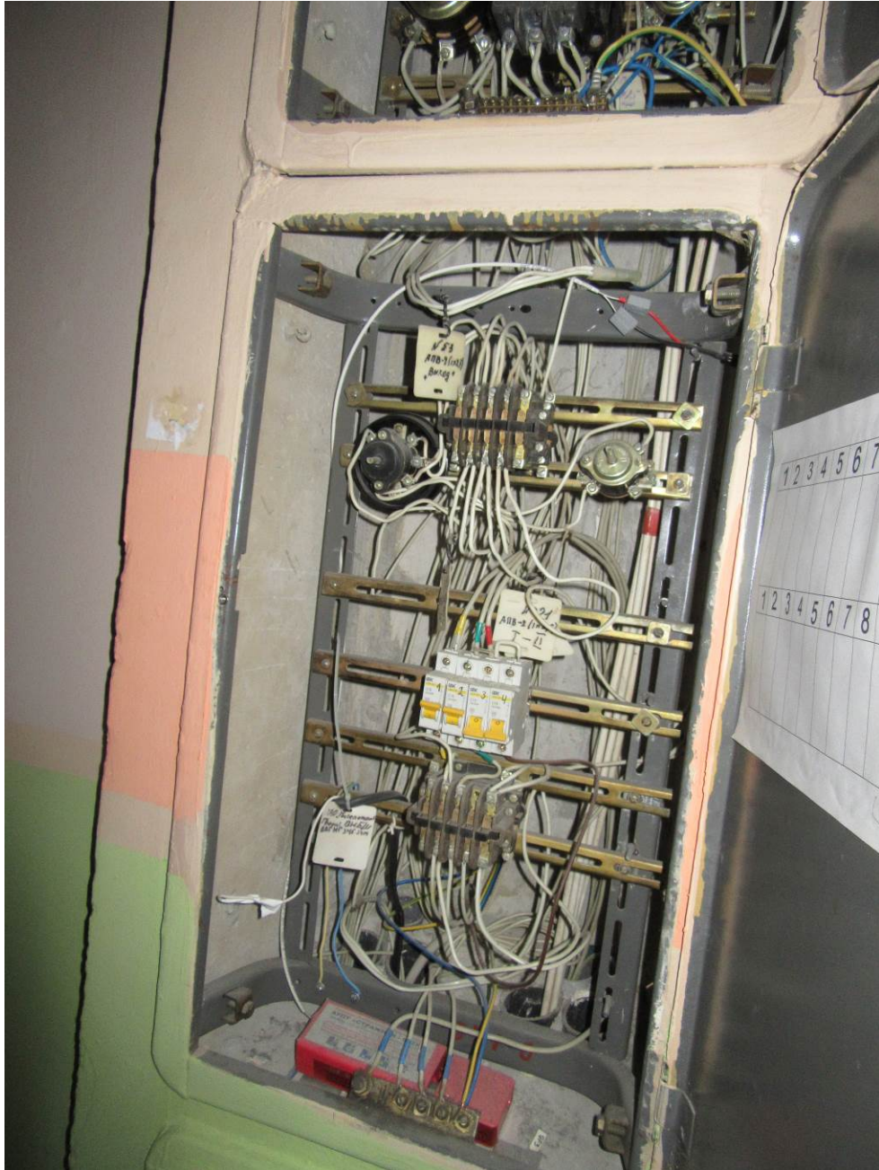
Фото 52. Щиты групповые на этажах.
