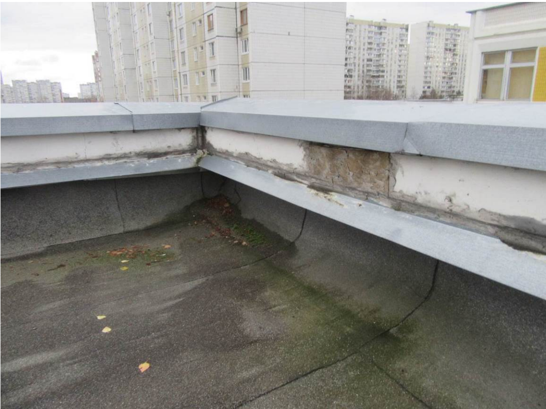
Фото №32. Деформация металлического окрытия парапета. Замачивание стены парапета
