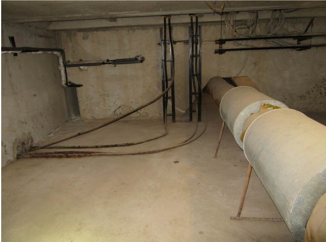
Фото 54. Подвал. Ввод «питающих» кабелей от ТП в здание. Распределительные сети от ВРУ до стояков Щитов, токоприемников, открыто по подвалу на металлических направляющих (лотках).
