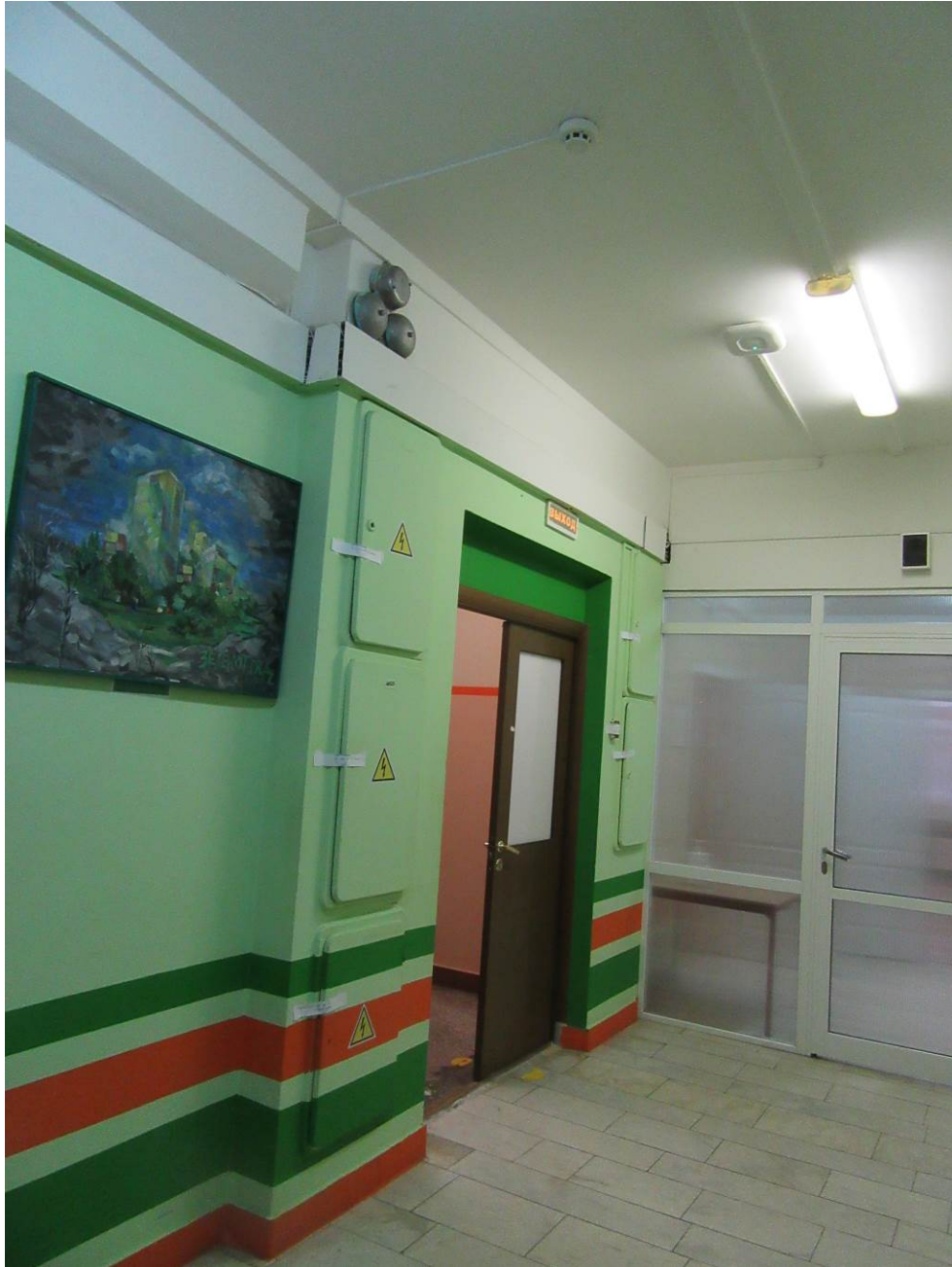
Фото 51. Щиты групповые, щиты слаботочные на этажах.
