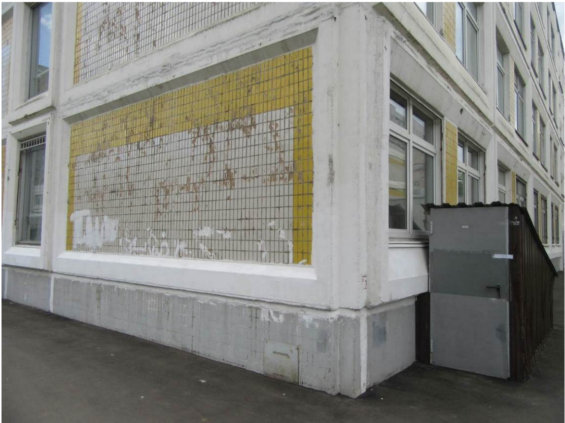
Фото №6. Повреждение панелей наружных стен
