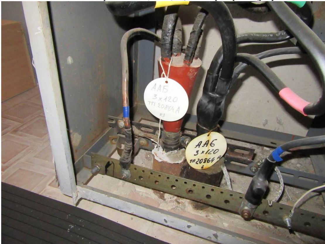
Фото 49. Вводная панель ВРУ, ввод «питающих» кабелей.
