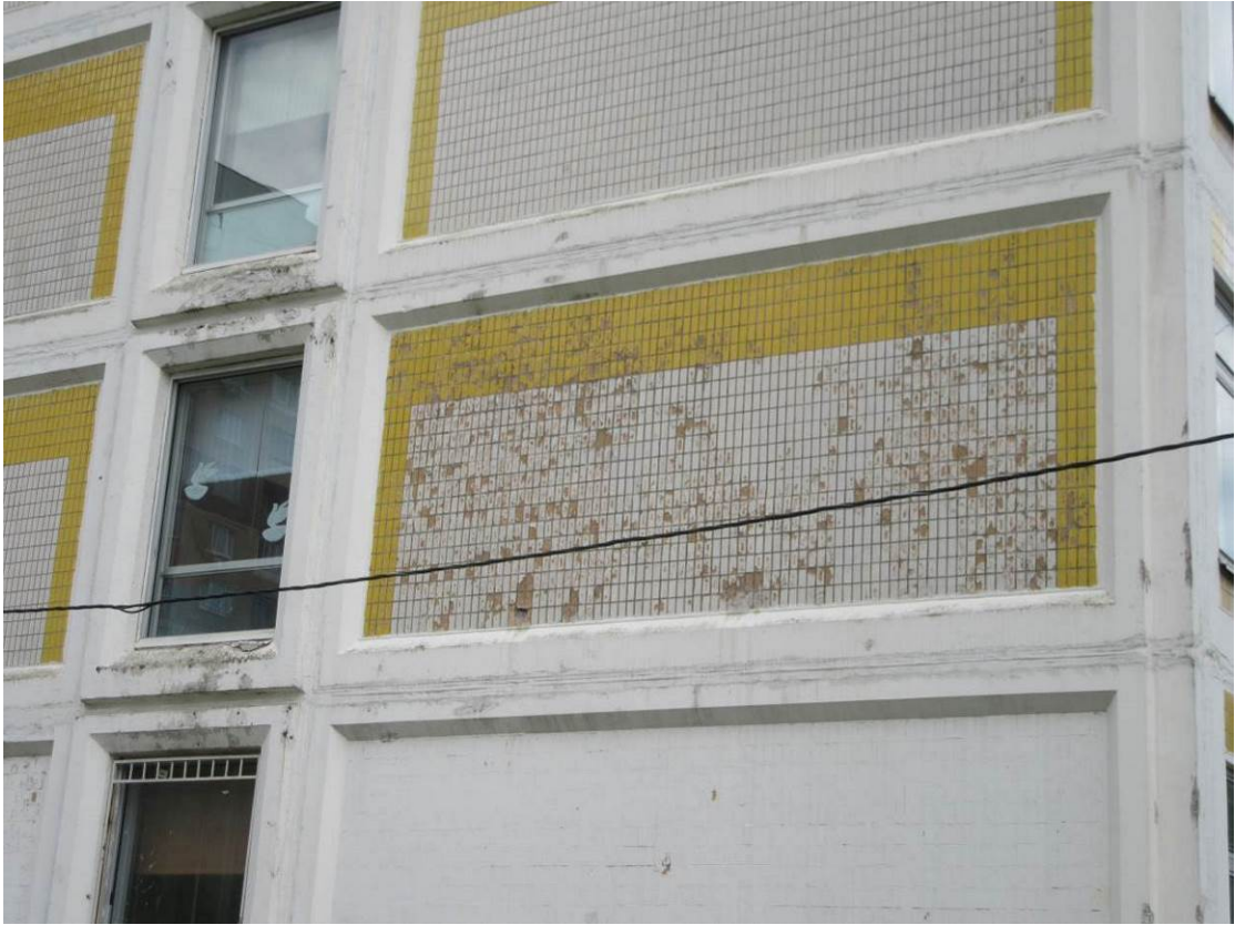
Фото №3. Повреждение панелей наружных стен
