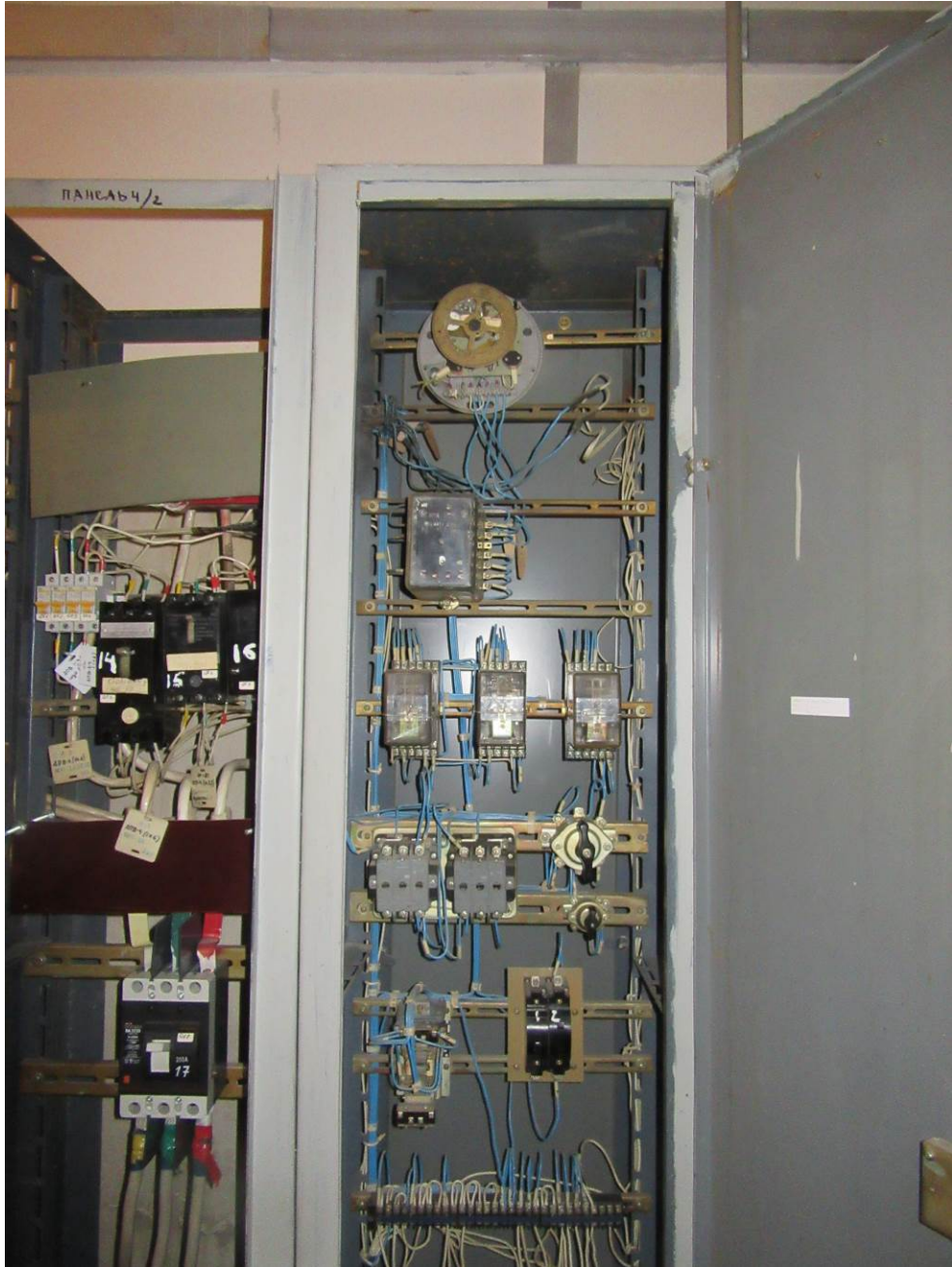
Фото 50. ВРУ, панель распределительная, панель автоматикеи.
