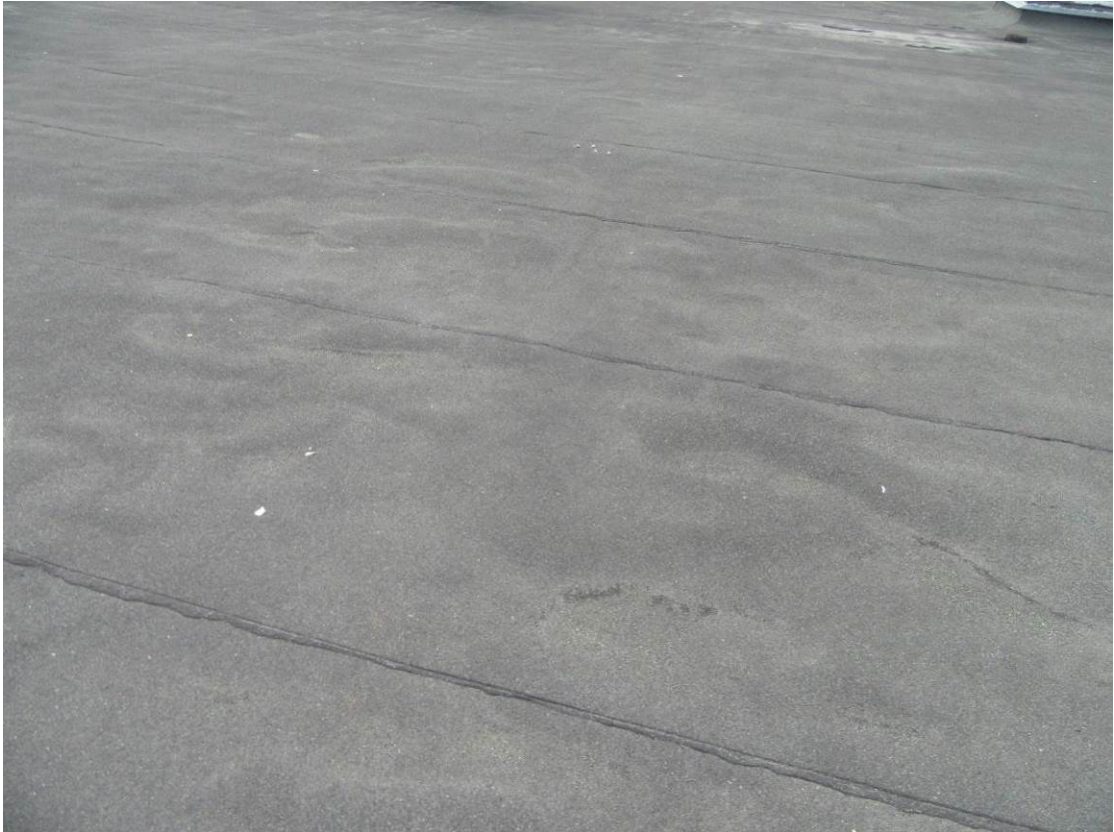
Фото №31. Вздутия кровельного покрытия
