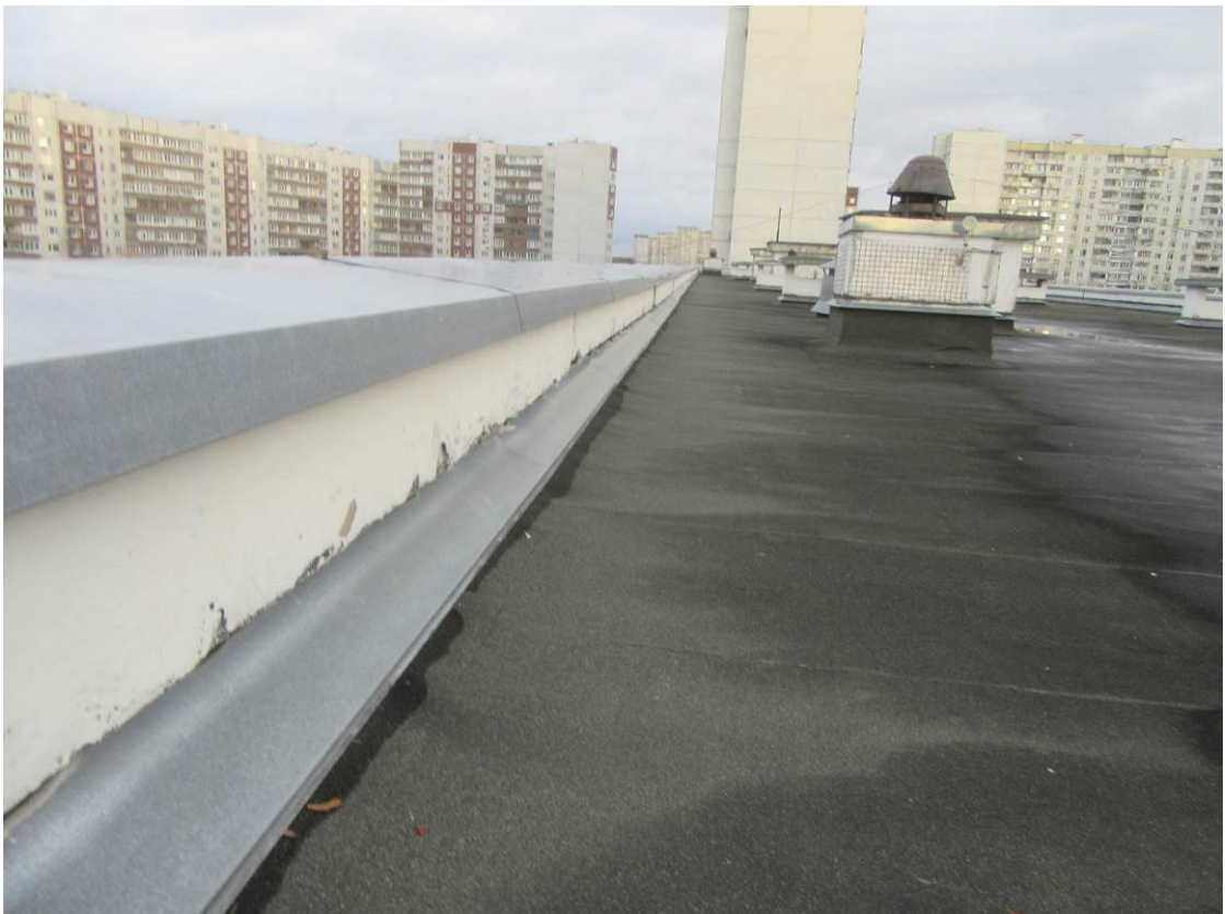
Фото №34. Вздутия кровельного покрытия
