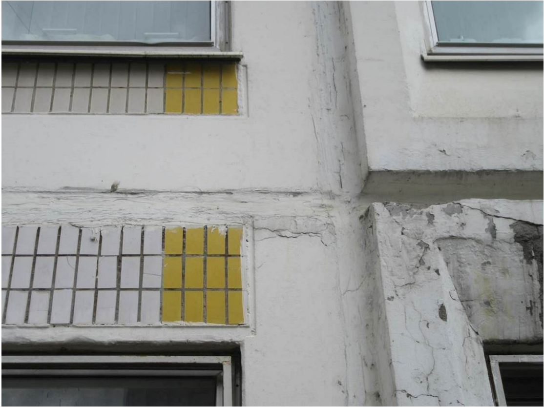
Фото №5. Трещины и отслоение герметика межпанельных стыков
