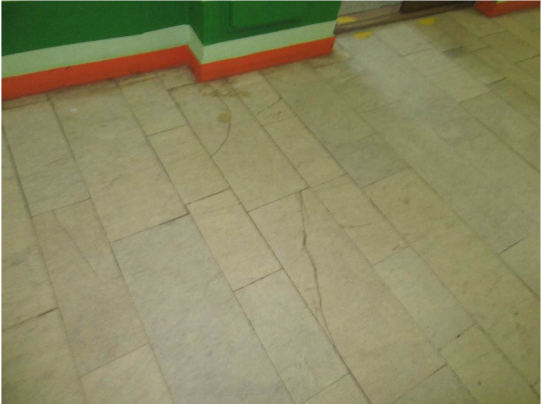
Фото №17. Повреждения мраморного покрытия пола
