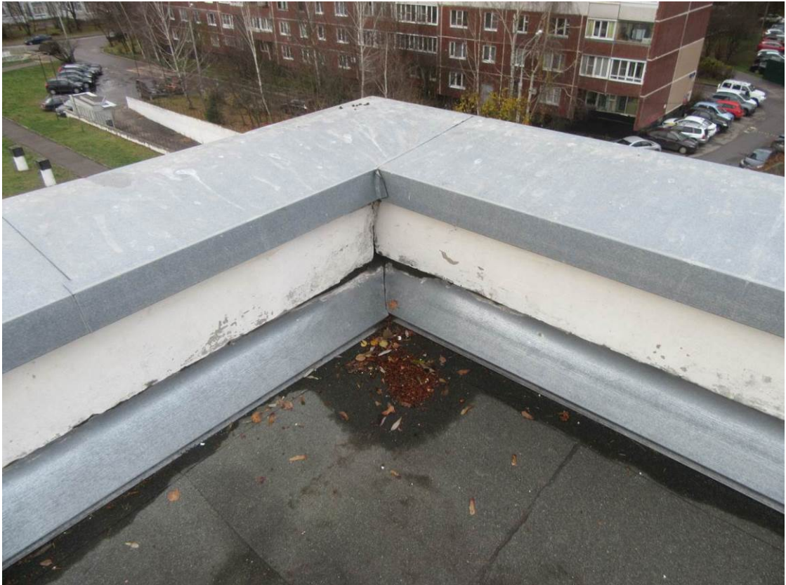
Фото №33. Деформация металлического окрытия парапета
