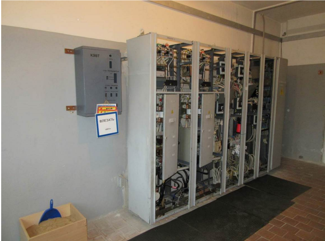
Фото 48. Помещение электрощитовой, ВРУ; Щит лабораторный (разукомплектован).
