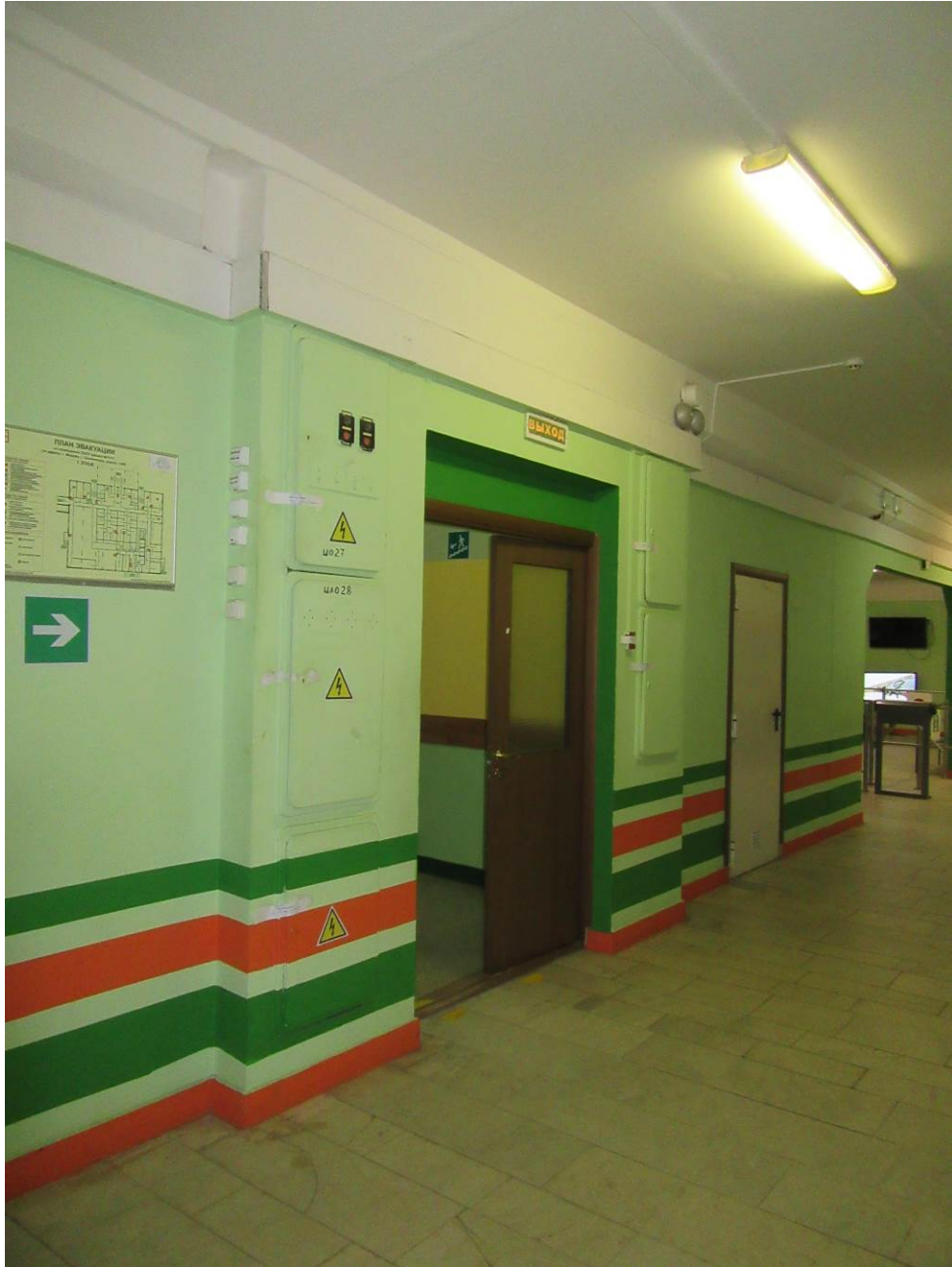
Фото 47. Щиты групповые, щиты слаботочные на этажах.
