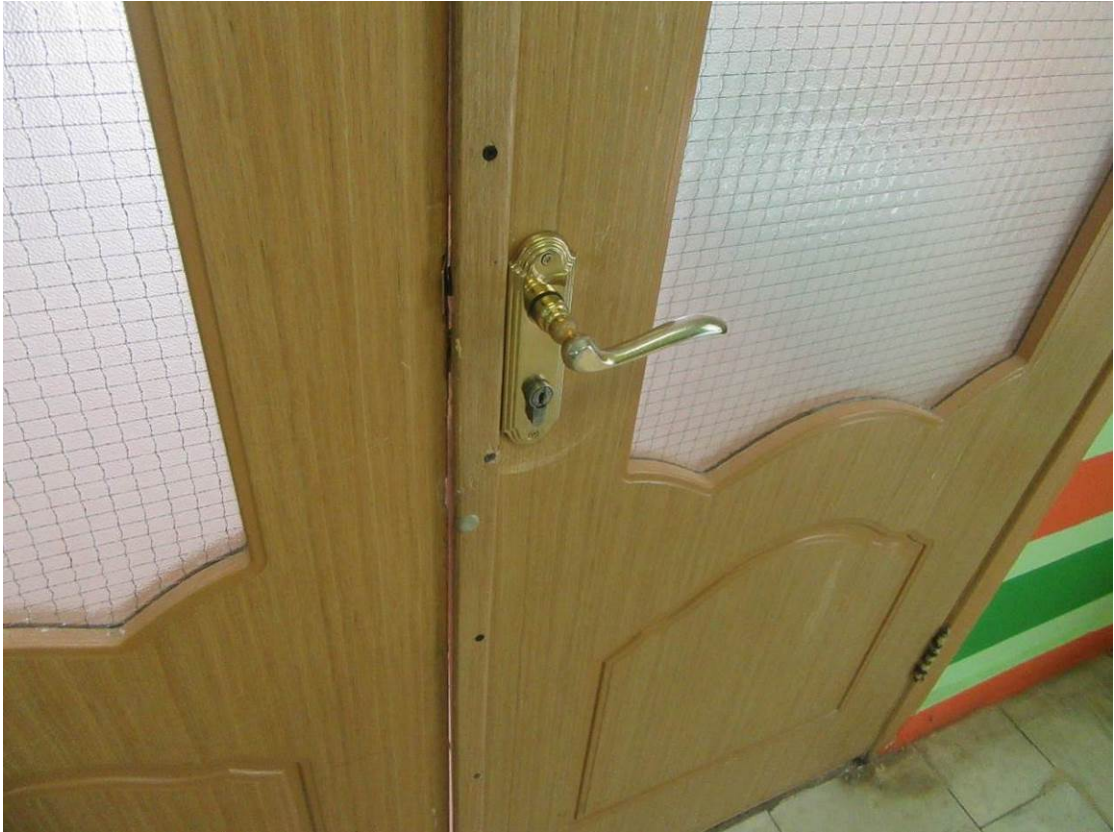
Фото №19. Повреждения деревянных дверей
