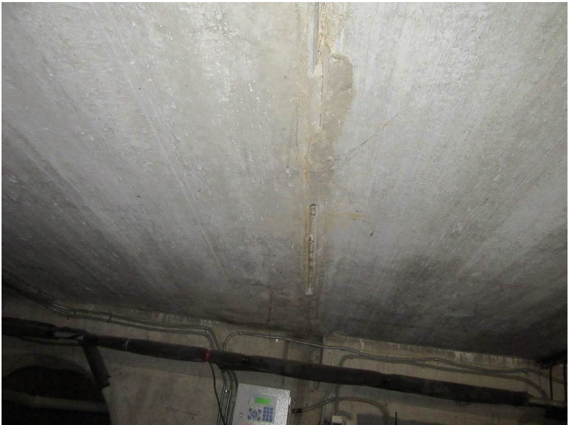
Фото №20. Разрушение растворной заделки между настилами подвального перекрытия
