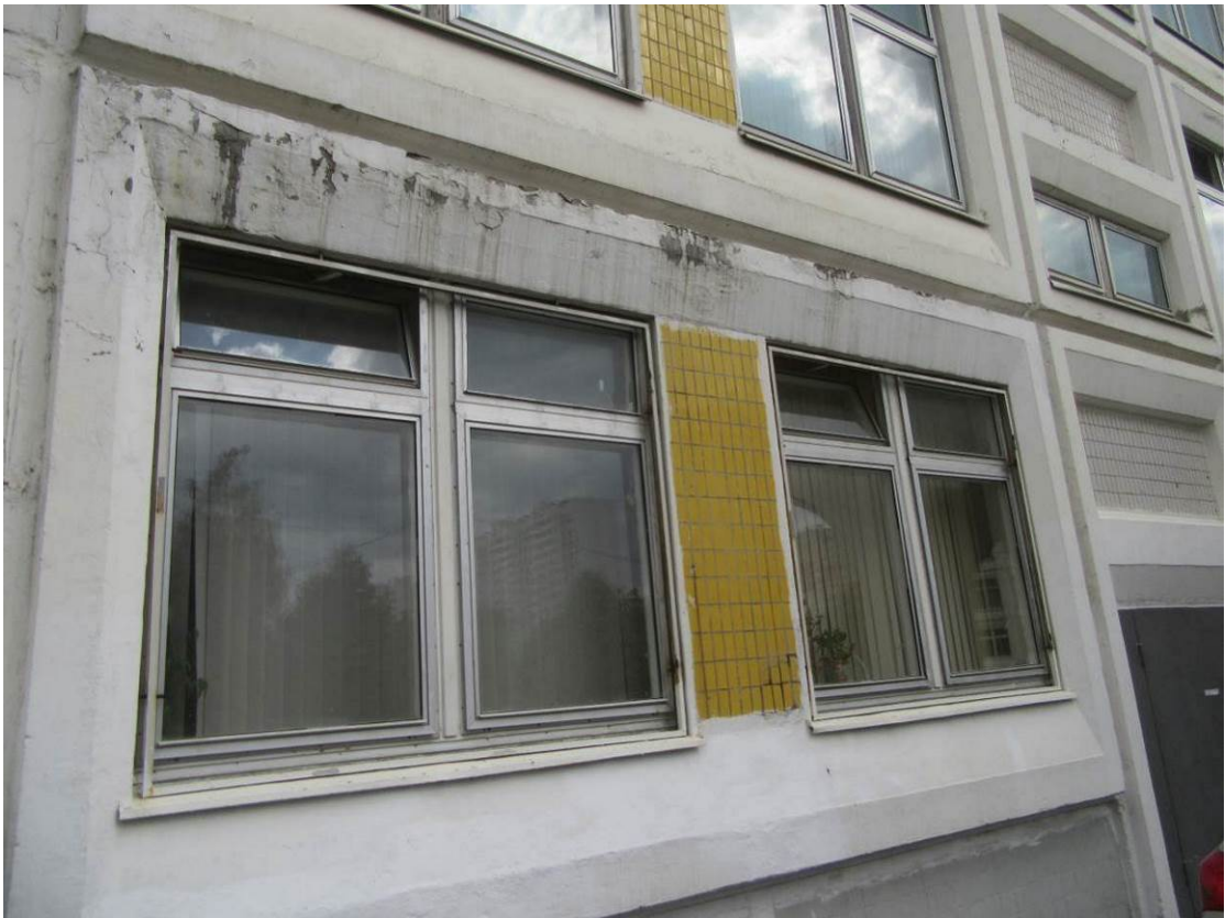
Фото №4. Повреждение панелей наружных стен
