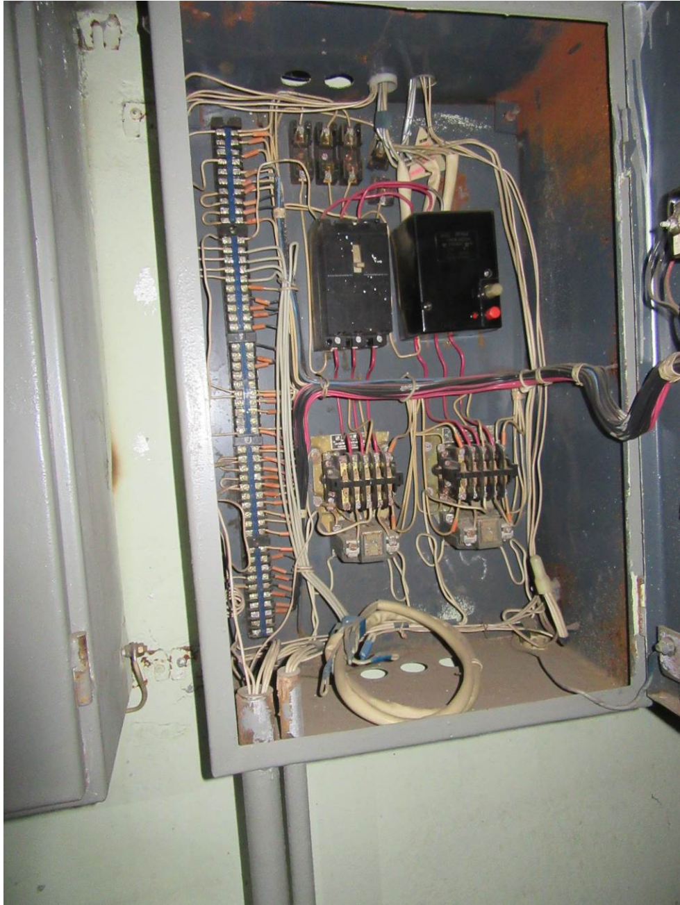
Фото 55. Подвал. Щиты управления.
