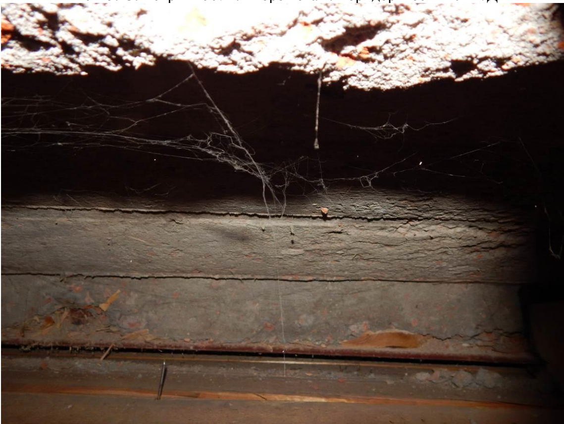
Рис П5.24. Вскрытие №2. Второй этаж. Коридор в осях 10-11/Д. Поверхностная коррозия стальных балок
