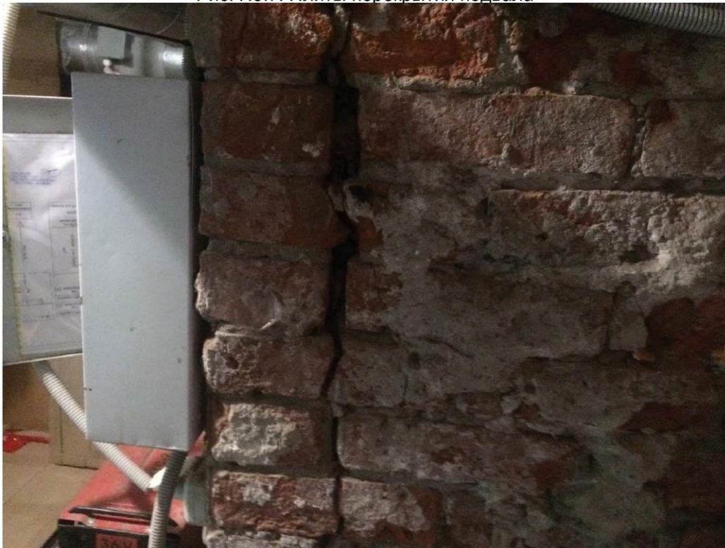
Рис П5.8. Трещина в осях 14-Г/Д, раскрытием до 25мм, образованная в из-за недостаточной площади опирания перемычки.
