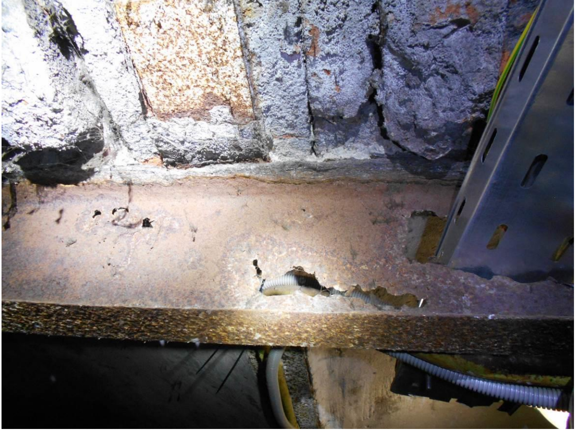
Рис П5.11. Механическое и коррозионное повреждение перемычки в осях 14/Г-Д.
