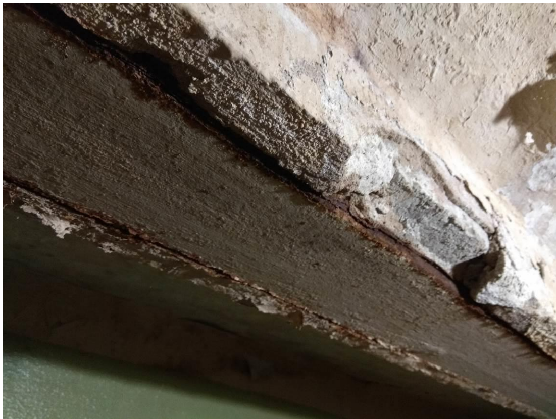
Рис П5.16. Поверхностная коррозия стальных балок сводчатого перекрытия над подвалом Отсутствие огнезащитного покрытия
