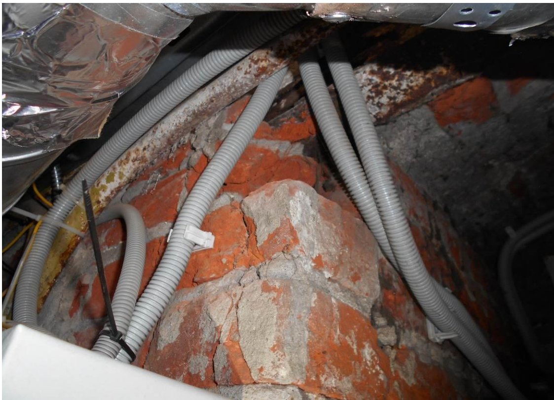
Рис П5.9. Трещина в осях 14-Г/Д, раскрытием до 25мм, смятие кирпичной кладки вследствие недостаточной площади опирания перемычки.
