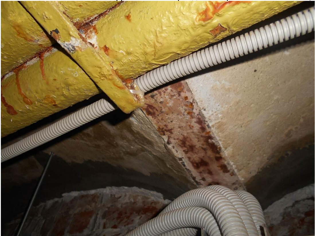
Рис П5.12. Состояние кирпичных сводов и стальных балок перекрытия подвала. Поверхностная коррозия нижних полок стальных балок. Отсутствие огнезащитного покрытия
