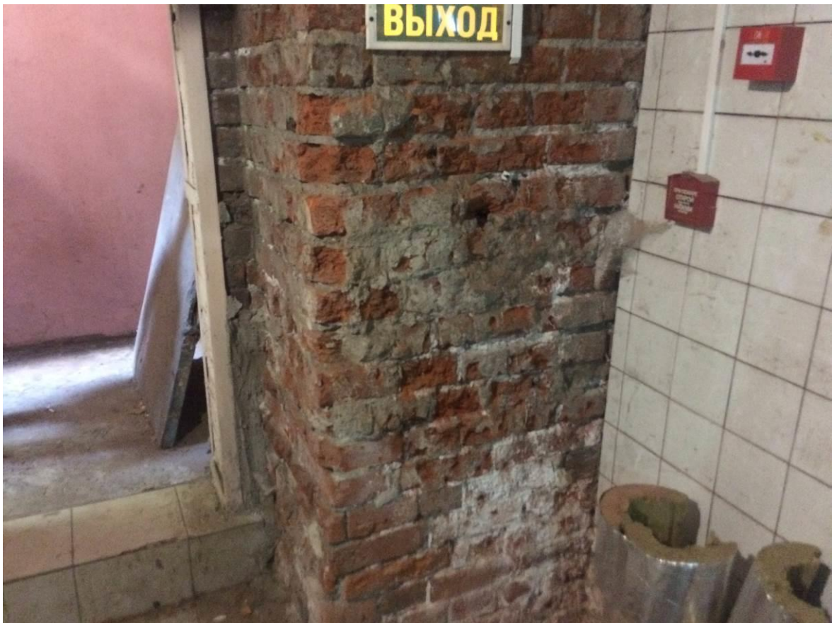
Рис. П5.6 Стена подвала. Разрушение кирпичной кладки с образованием лещадок
