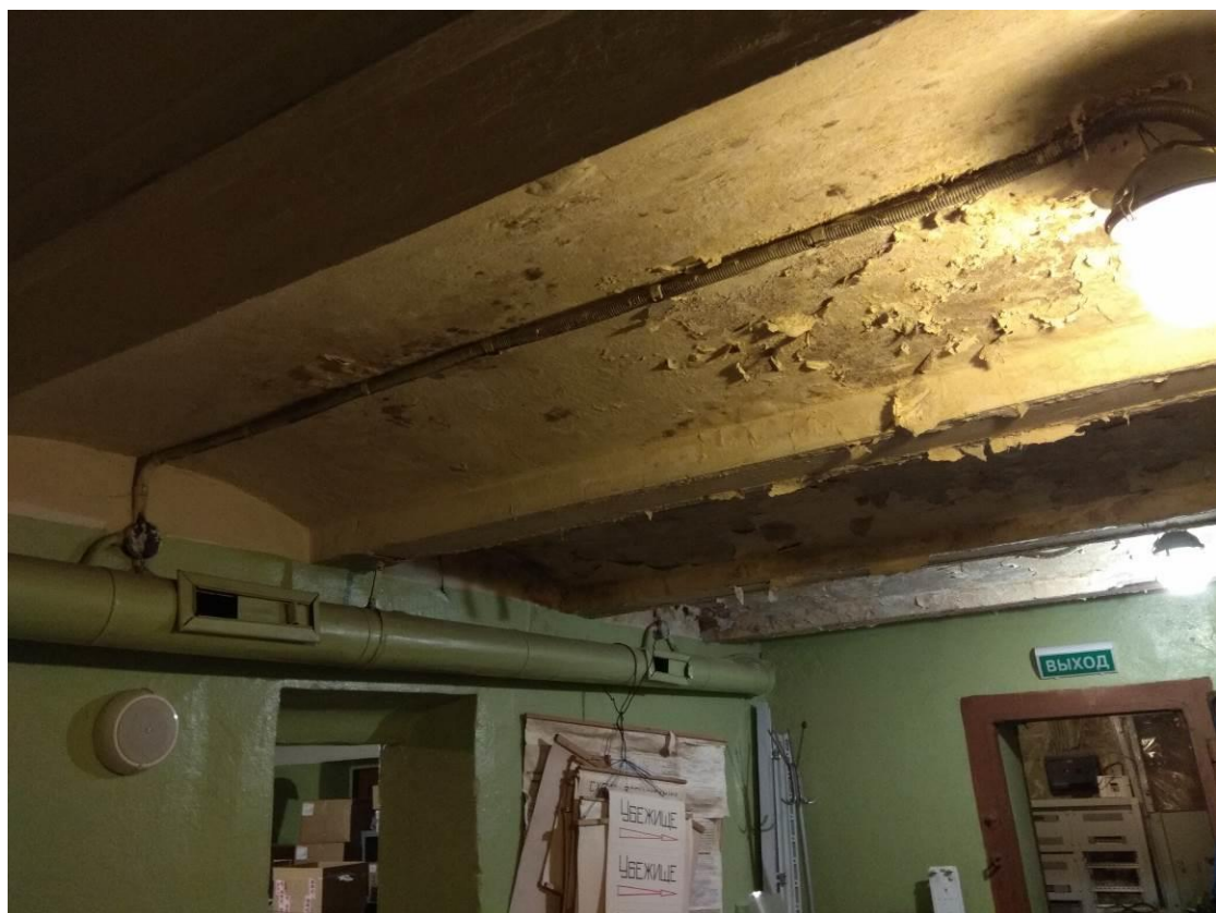
Рис П5.15. Перекрытие над подвалом в осях 3-5/Ж-К. Шелушение отделочного слоя сводов
