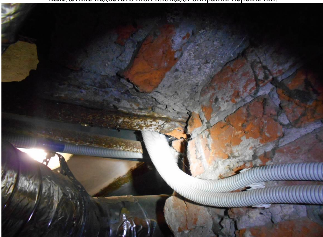
Рис П5.10. Трещина в осях 14-Г/Д, раскрытием до 25мм, смятие и разрушение кирпичной кладки вследствие недостаточной площади опирания перемычки.
