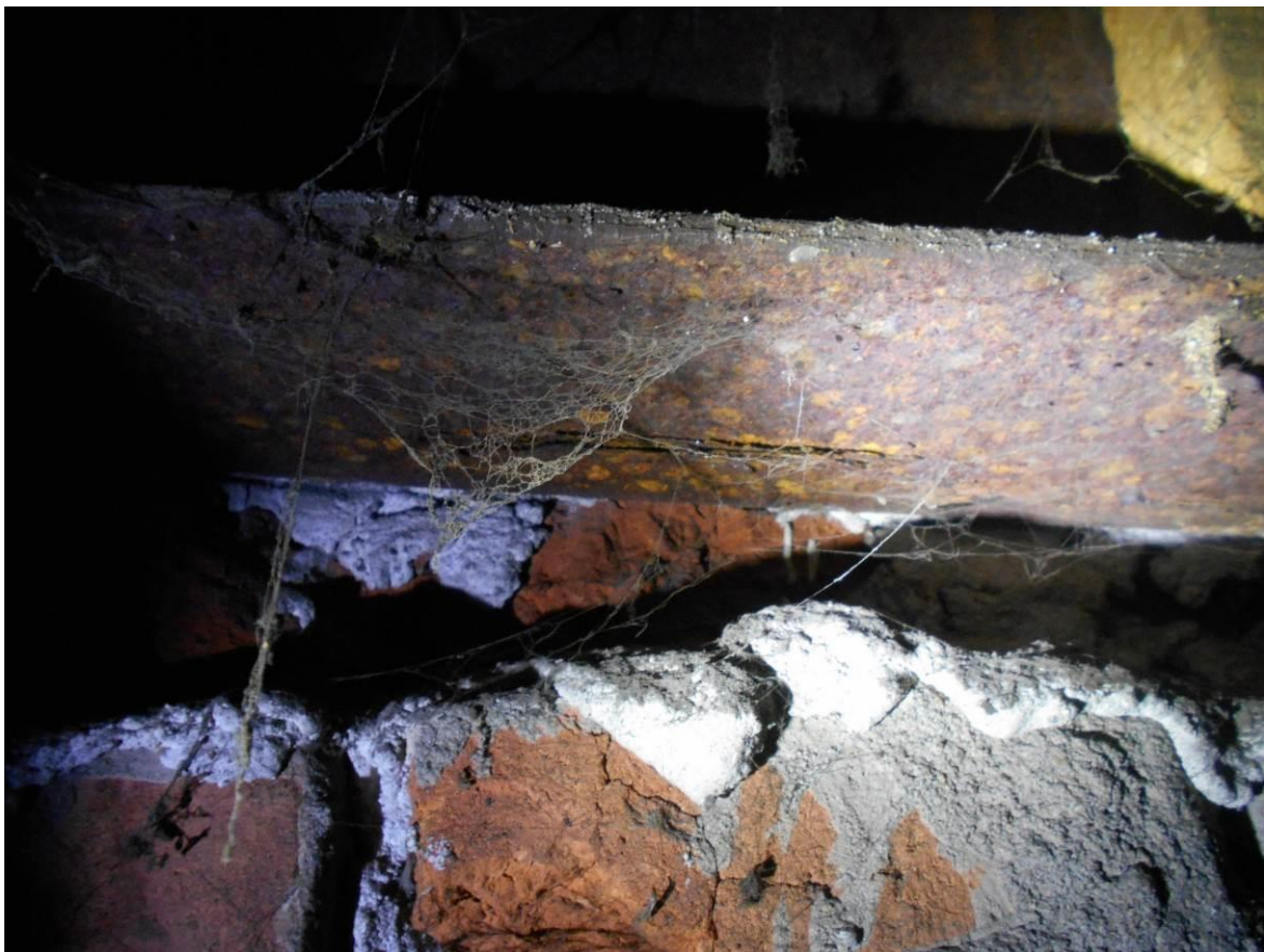
Рис П5.14. Перекрытие подвала в осях 3-4/Г-Е. Слоистая коррозия стальных балок
