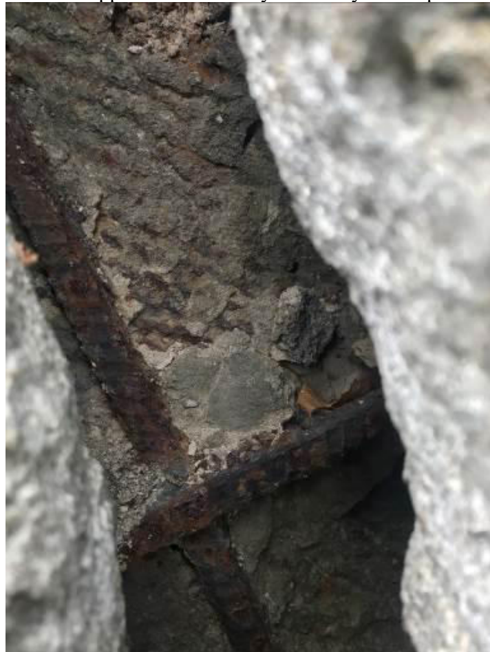
Рис. 2. Коррозия арматуры с утратой сечения, вследствие расслоения.
