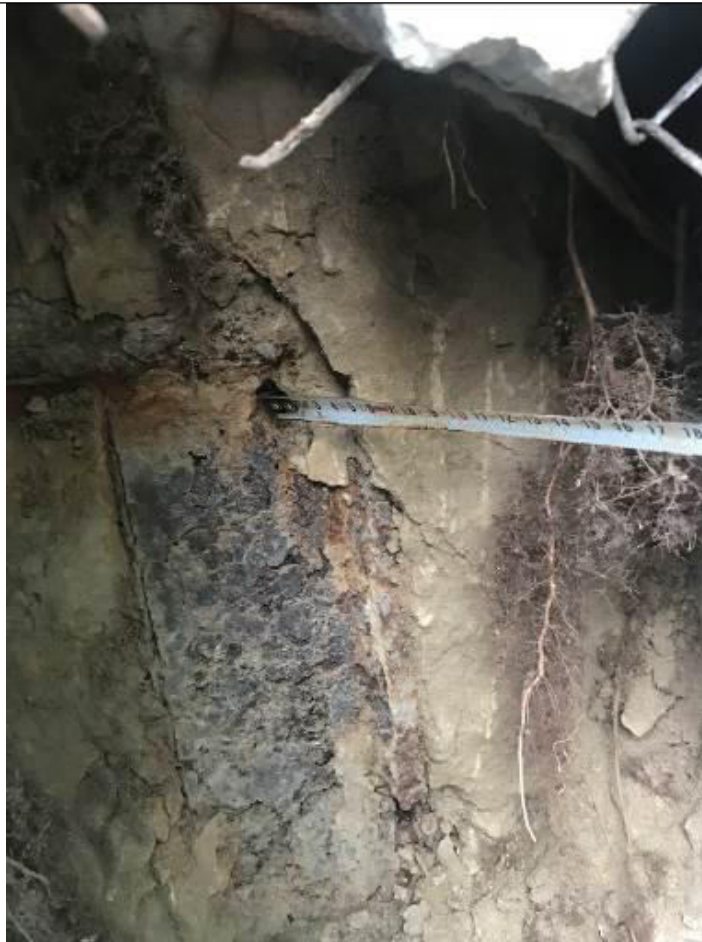
Рис. 1. Коррозия стальных уголков купола с расслоением металла.
