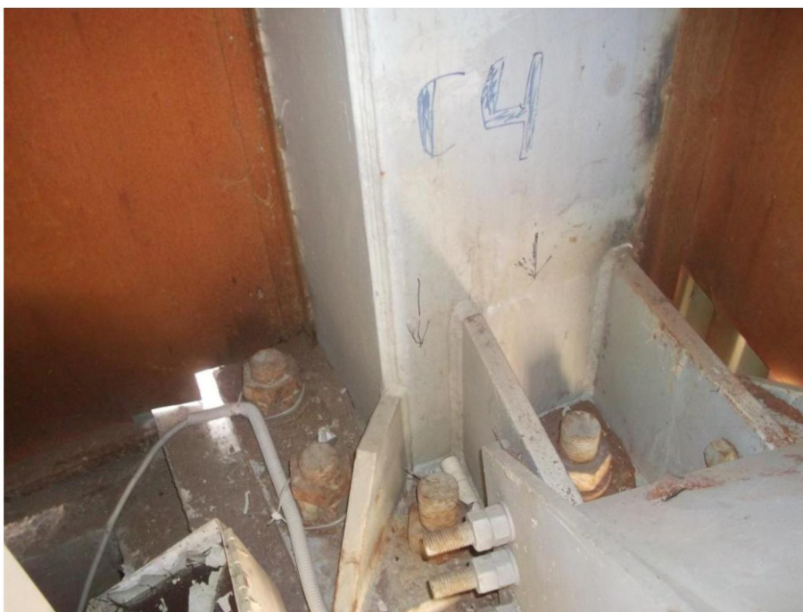
Фото 6. Фундаментный узел в осях А/1. Отсутствие контргаяк на фундаментных анкерах
