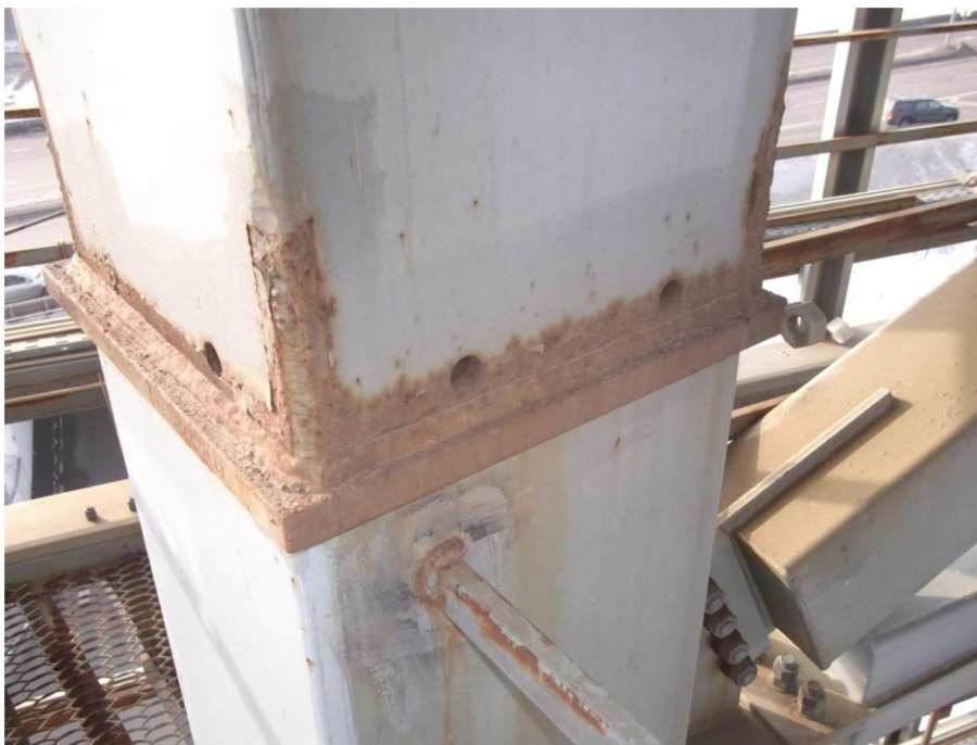
Фото 11. Укрупнительный стык в осях А /1 на отметке +24,000. Неравномерность катетов сварных швов, подрезы на гранях опор, шлаковые включения. Сквозные монтажные отверстия
