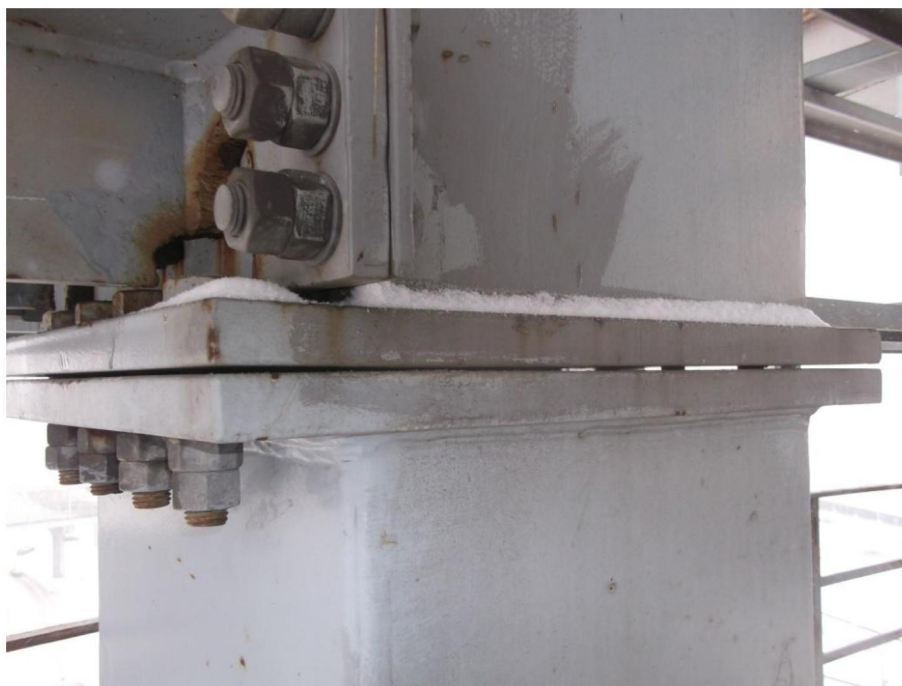
Фото 14. Узел укрупнительного стыка опоры в осях A/1 на отметке +36,000. Зазор 4мм.
