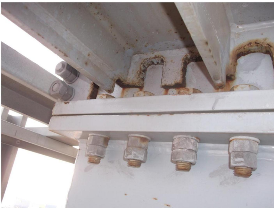
Фото 12. Укрупнительный стык в осях В/1 на отметке +36,000. Подрезы в опорных консолях навесных плоских каркасов под рекламные конструкции
