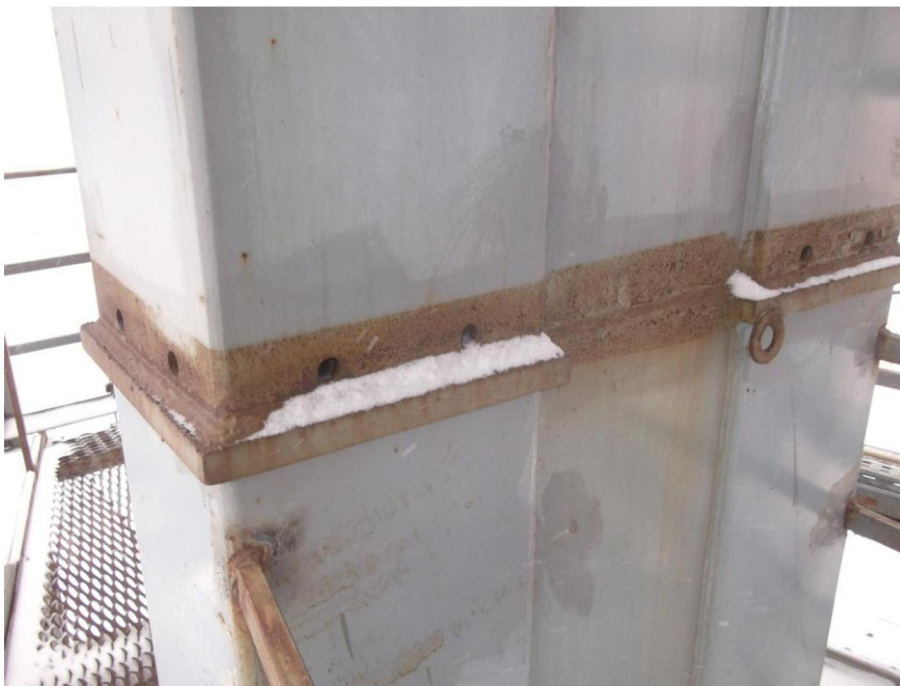
Фото 5. Локальные участки поверхностной коррозии на элементах несущего каркаса сооружения
