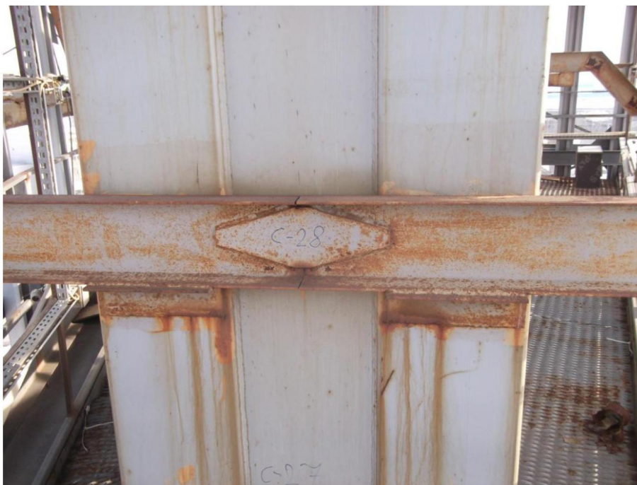
Фото 16. Консоли для опирания фермы Ф1 под рекламные конструкции в осях А +1,50/2 на отметке +26,450. Отслоение лакокрасочного покрытия и поверхностная коррозия, неравномерность по длине катетов сварных швов и шлаковые включения
