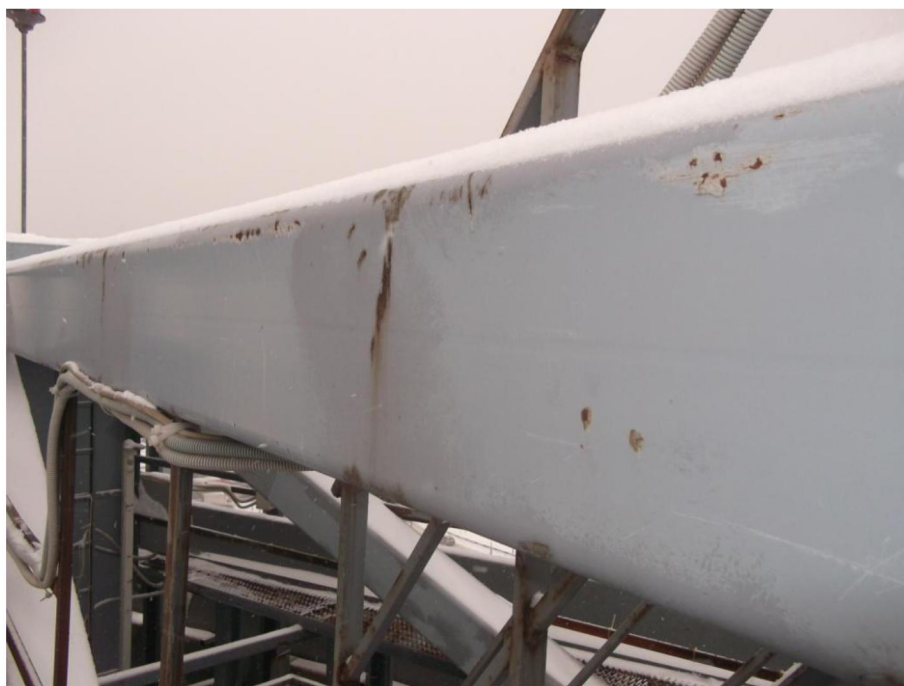
Фото 4. Сколы лакокрасочного покрытия
