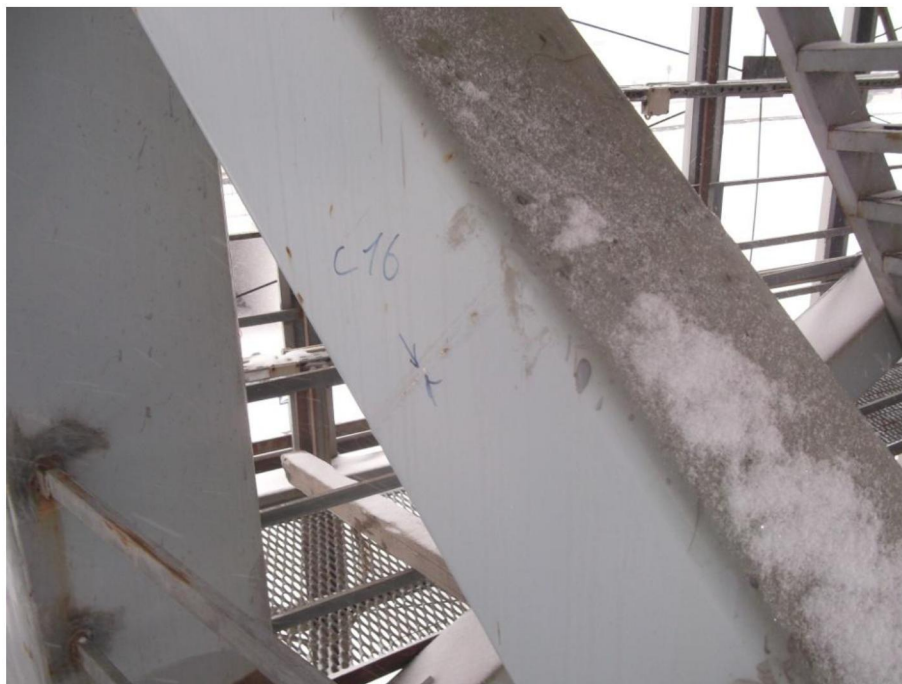
Фото 17. Непроектное сварное стыковое соединение в раскосе в осях А-В/1
