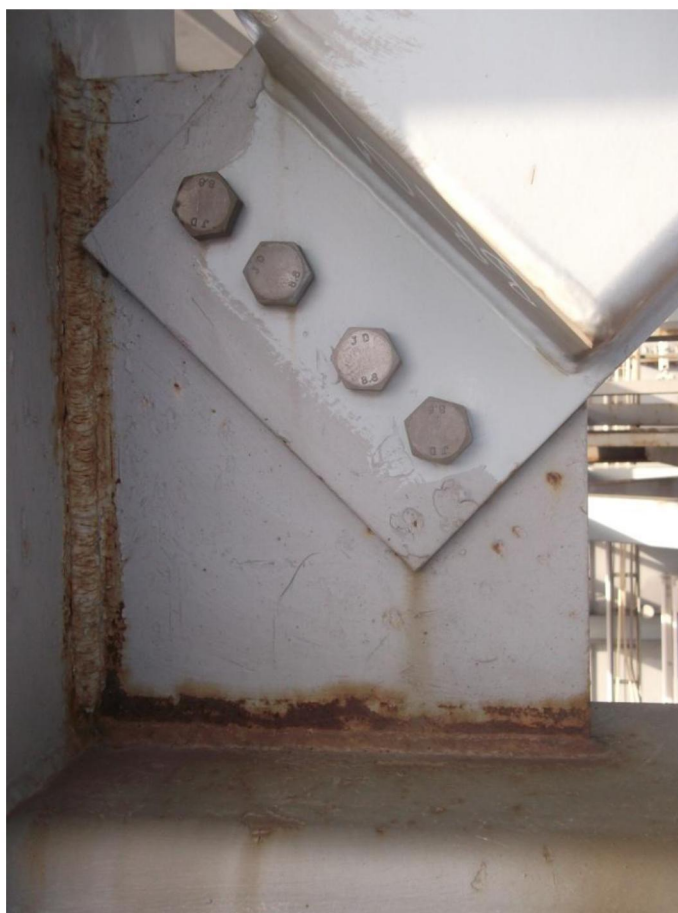
Фото 10. Узел крепления раскоса в осях А-В/1 к опоре и распорке в осях А/1 на отметке +35,000. Повреждение лакокрасочного покрытия и поверхностная коррозия, неравномерность по длине катета сварного шва
