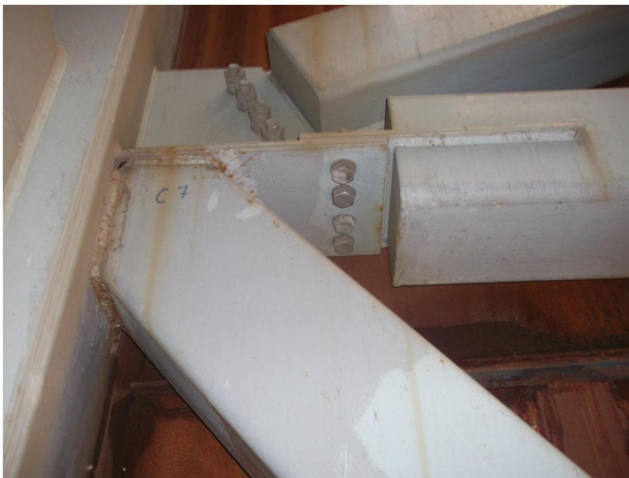
Фото 9. Узел примыкания раскоса в осях 1-2/А к опоре в осях А/1 на отметке +5,160. Неравномерность по длине катетов сварных швов и шлаковые включения
