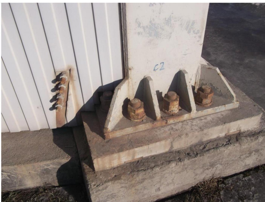
Фото 8. Фундаментный узел в осях A/2 . Поверхностная коррозия на опорной пластине, анкерах, шайбах, гайках и контргайках. Отслоение лакокрасочного покрытия на опорной пластине
