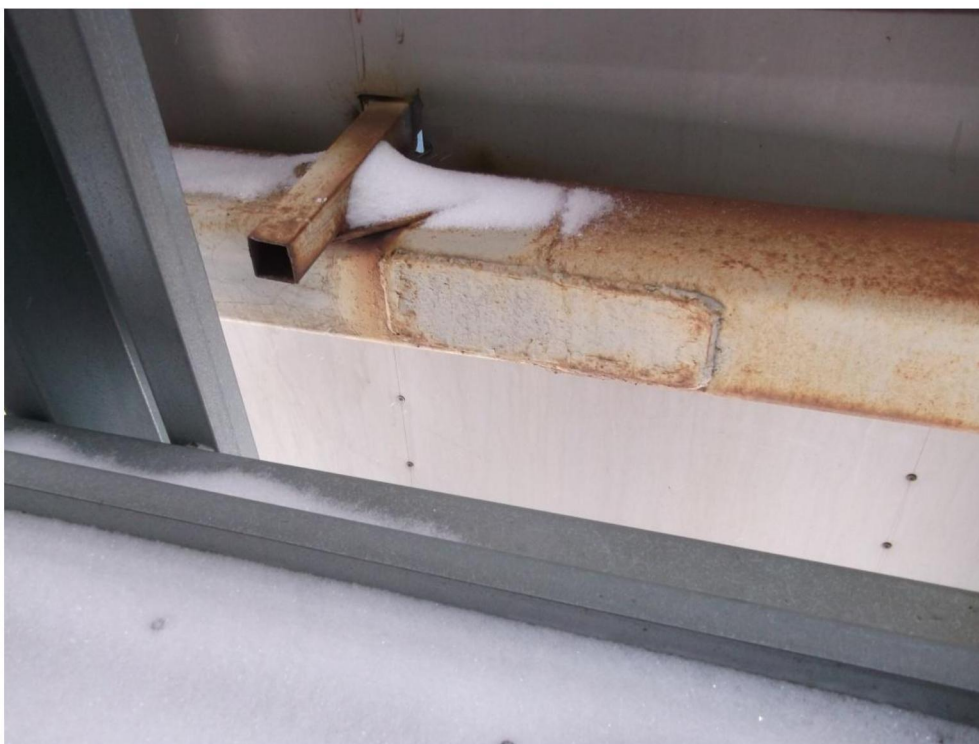
Фото 4. Непроектное сварное стыковое соединение несущей конструкции рекламной вывески «МЕГА»
