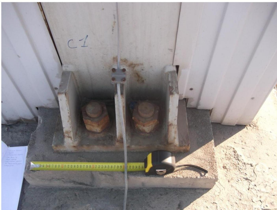
Фото 7. Фундаментный узел в осях A_{+1,50}/2 . Поверхностная коррозия на опорной пластине, анкерах, шайбах, гайках и контргайках. Сколы бетонной подливки на фундаментной тумбе
