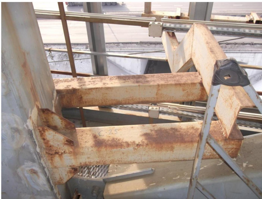
Фото 15. Консоли для опирания фермы Ф1 под рекламные конструкции в осях А/1 на отметке +26,890. Отслоение лакокрасочного покрытия и поверхностная коррозия, неравномерность по длине катетов сварных швов и шлаковые включения
