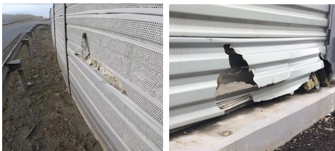
Рисунок 5.1.9 – Нарушение целостности конструкций
