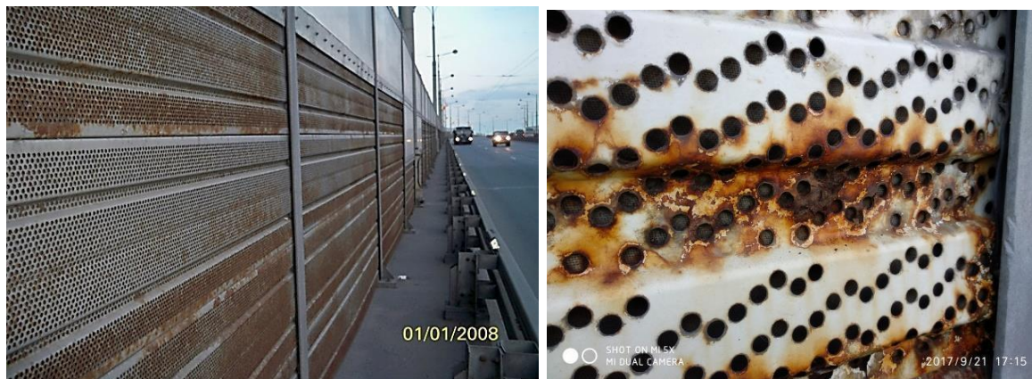
Рисунок 5.1.7 – Глубокая коррозия металла
