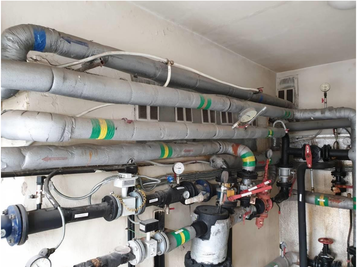
Фото 24. Приборы учёта ГВС, отопления.
