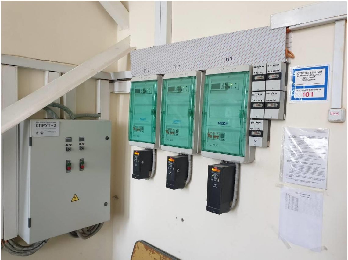
Фото 33. Узел управления системой вентиляции.
