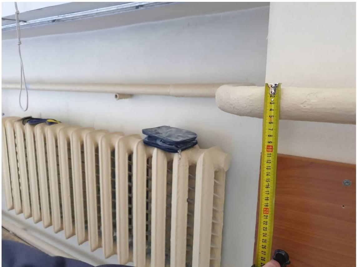
Фото 26. Отопление, магистральный трубопровод подачи в зале с верхней разводкой.
