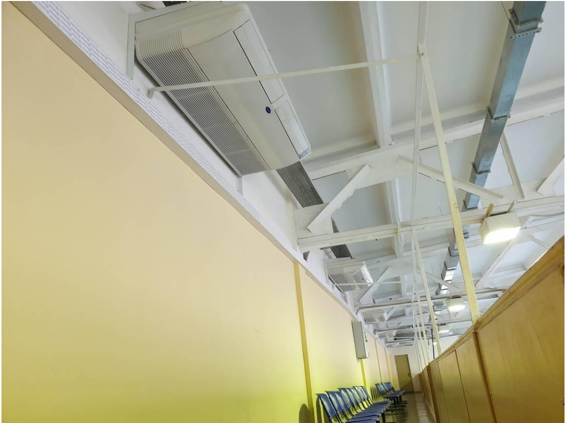
Фото 31. Кондиционеры на балконе.
