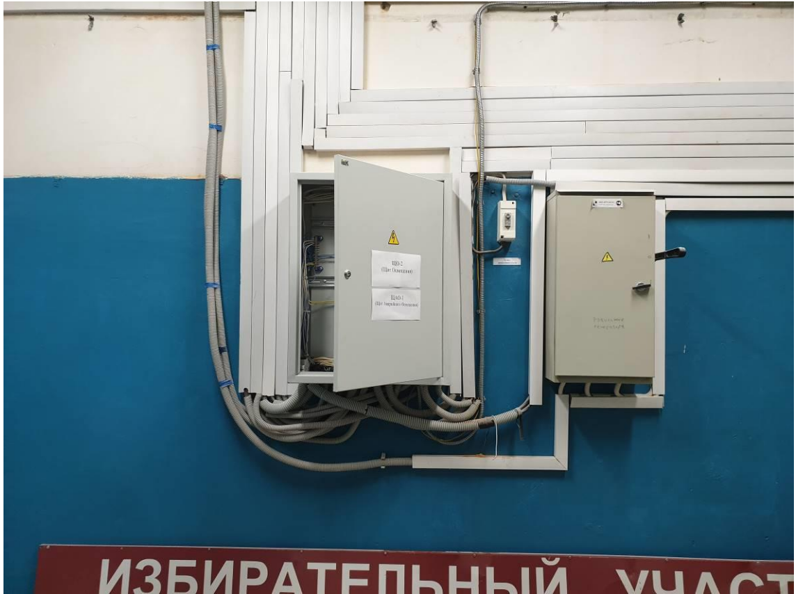
Фото 37. Распределительные щиты в электрощитовой.
