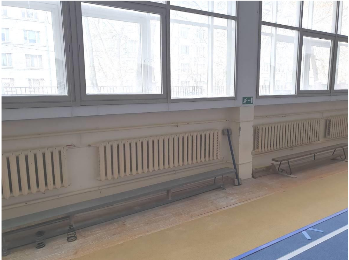
Фото 25. Вид на радиаторы отопления в зале.
