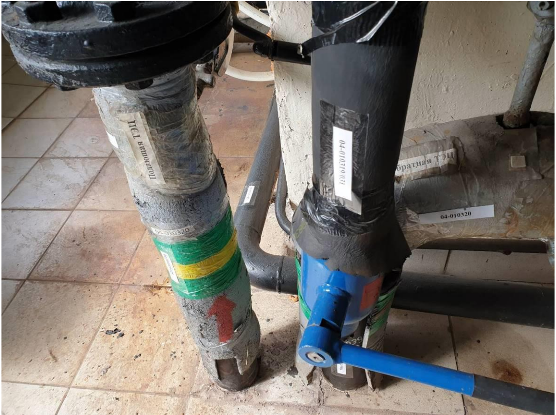
Фото 21. Ввод отопления в бойлерной.
