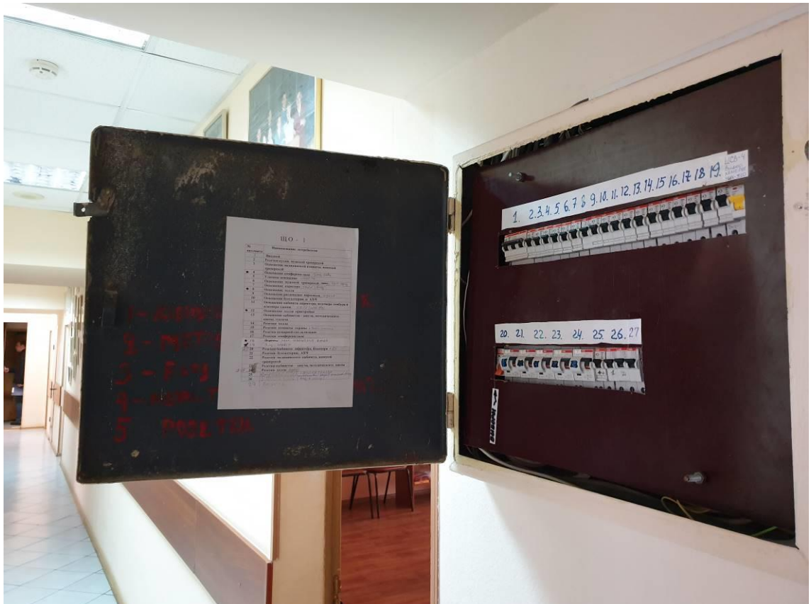
Фото 38. Щит освещения и силовой группы в административной части.
