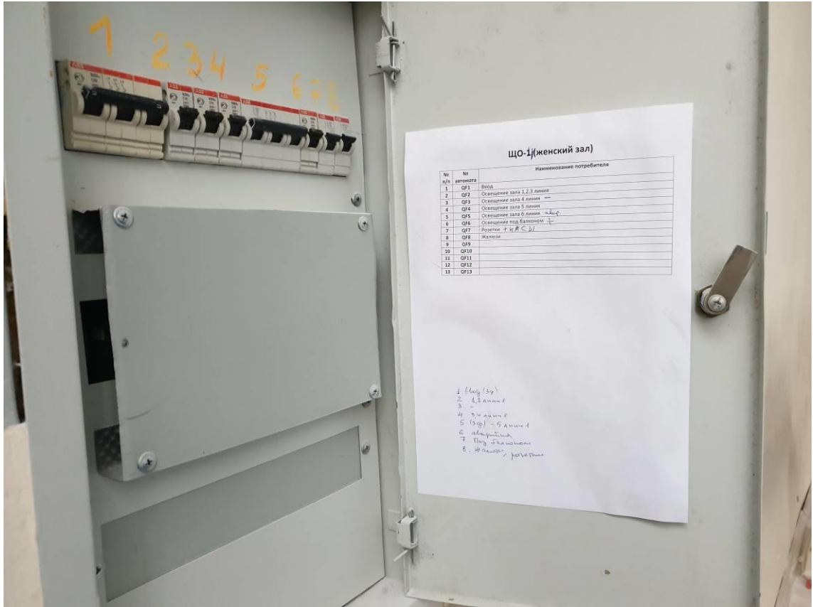
Фото 39. Щит освещения и силовой группы в зале.
