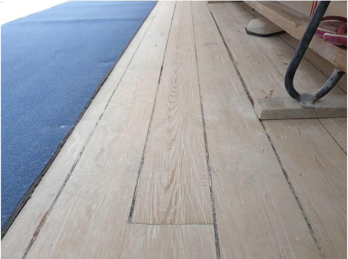
Фото 19. Полы в спортивном зале. Большие щели, между досками напольного покрытия.
