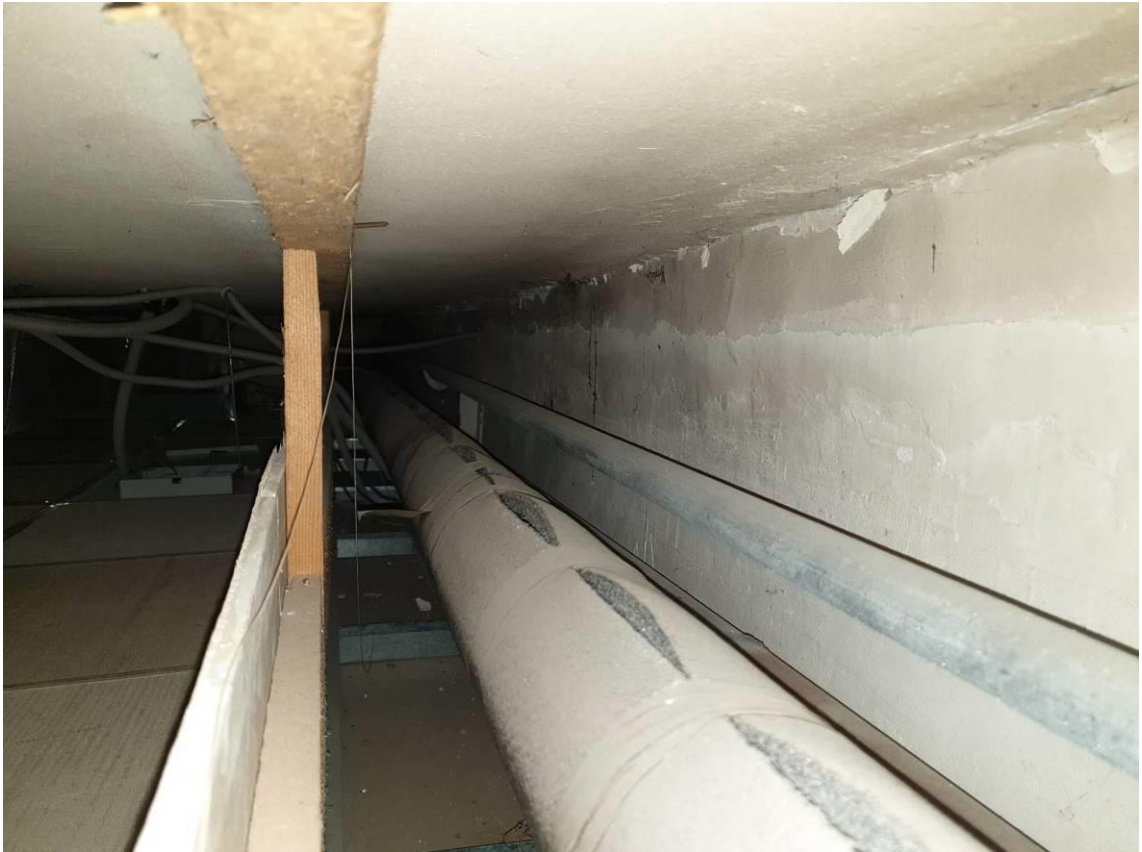
Фото 29. Магистральные трубы ХВС (слева) и отопления (справа), под потолком в административной части
