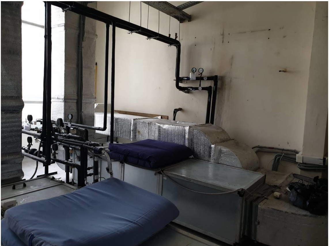
Фото 32. Вентиляционная, общий вид.
