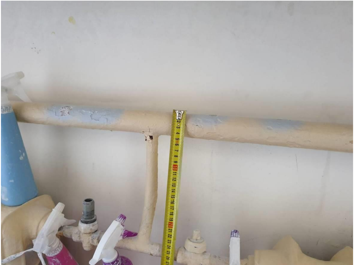
Фото 27. Коррозия трубопровода, отслоение окрасочного слоя труб.
