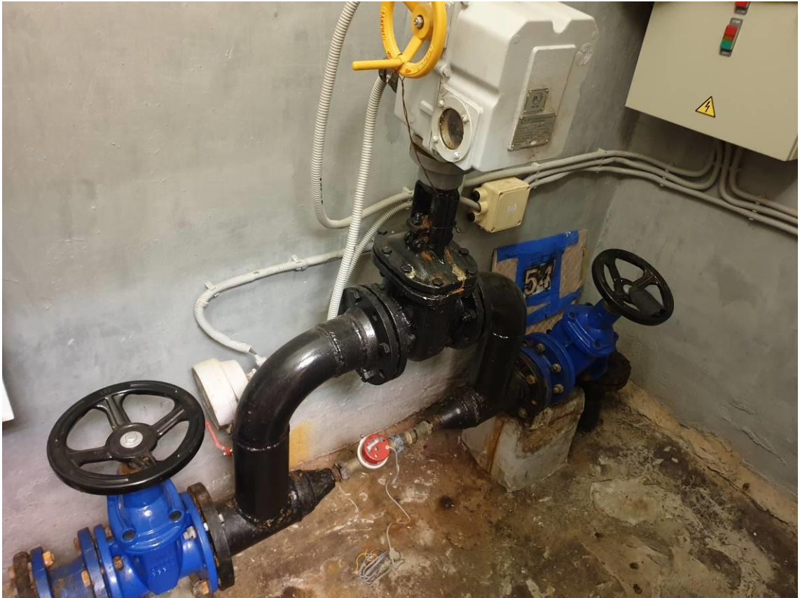
Фото 35. Ввод холодной воды.
