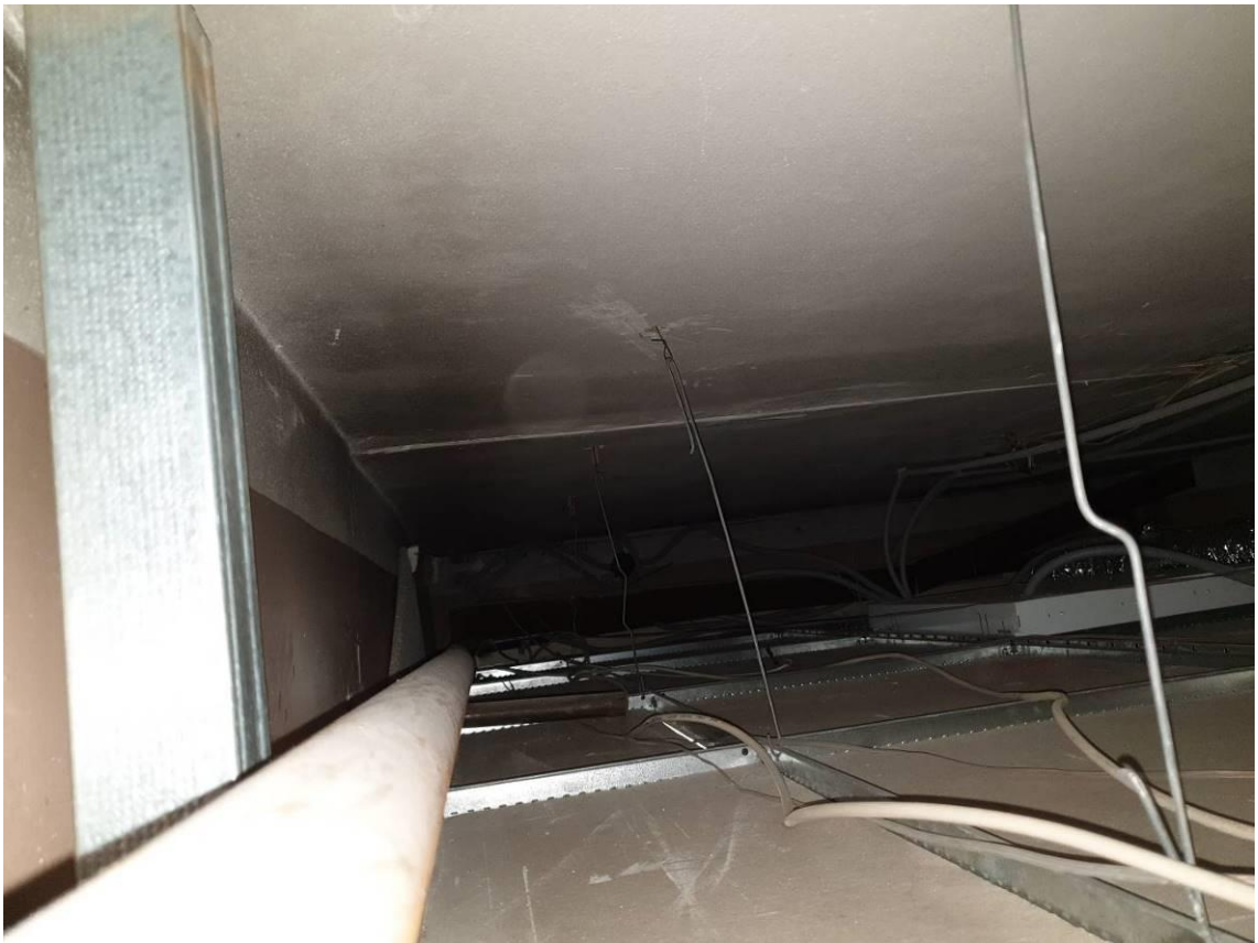
Фото 28. Магистральная труба отопления в административной части под потолком.
