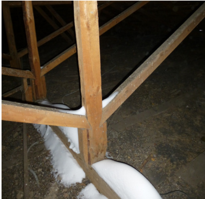
Рис.14 Отложение снега на чердачном перекрытии.
