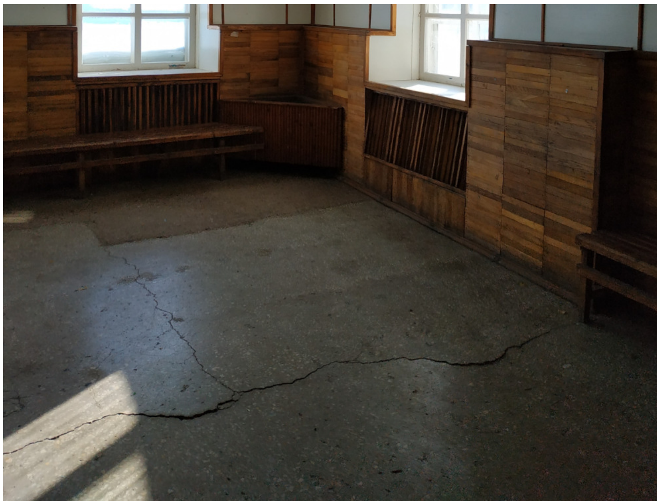
Рис.24 Разрушение мозаичного пола.
