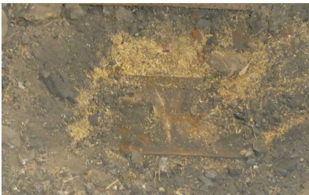
Рис.13 Металлическая балка покрытия.
