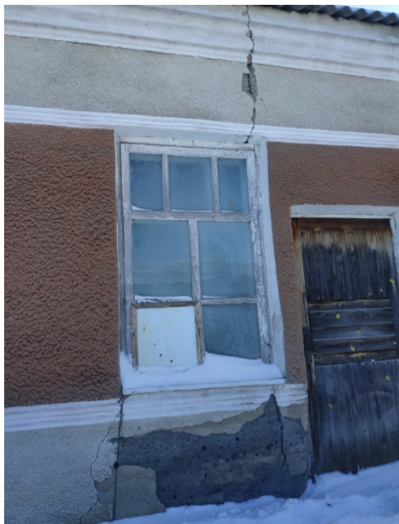
Рис.11 Трещины около простенка шириной 170 мм.
