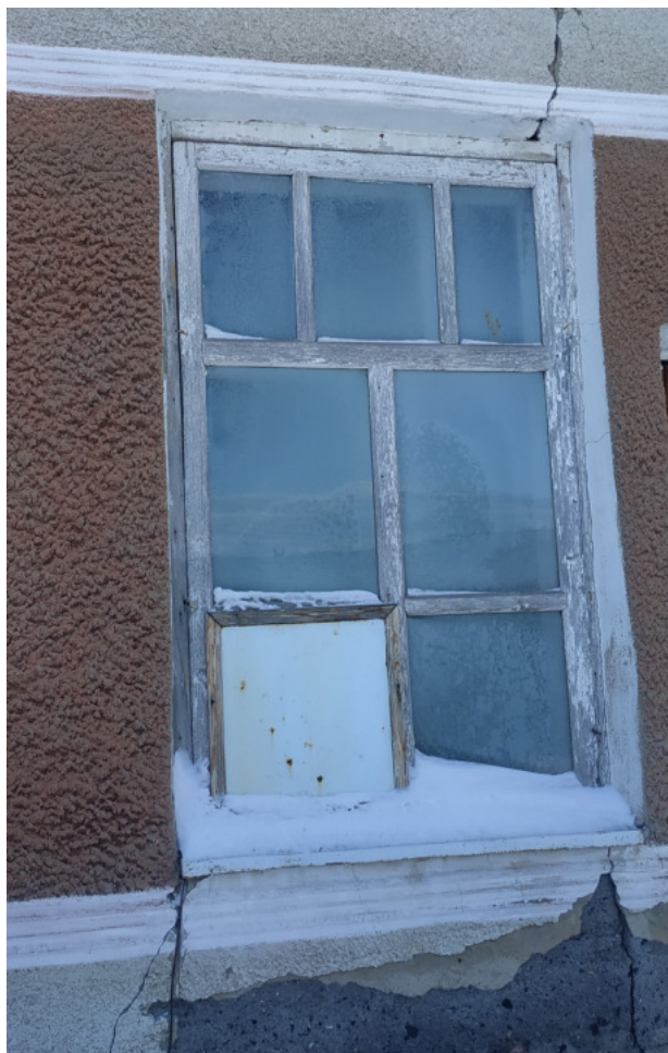
Рис.20 Отслоение лакокрасочного покрытия окна.
