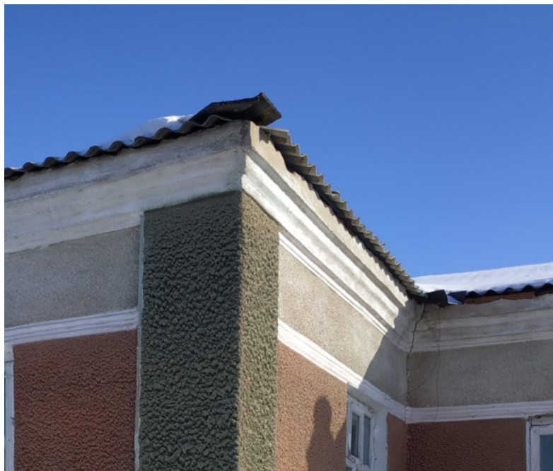
Рис.16 Повреждения защитного фартука из досок и кровельной стали.
