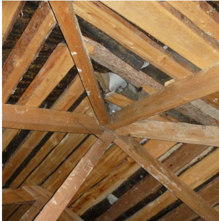
Рис.15 Повреждение обрешетки и защитных слоёв.
