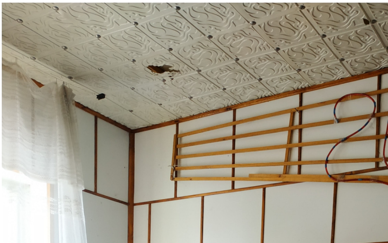
Рис.24 Повреждения облицовочной плитки ПВХ.
