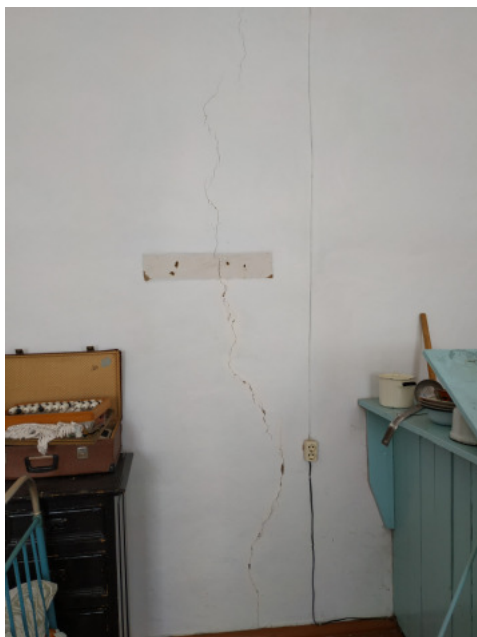
Рис.8 Трещина во внутренней стене по оси «В»
