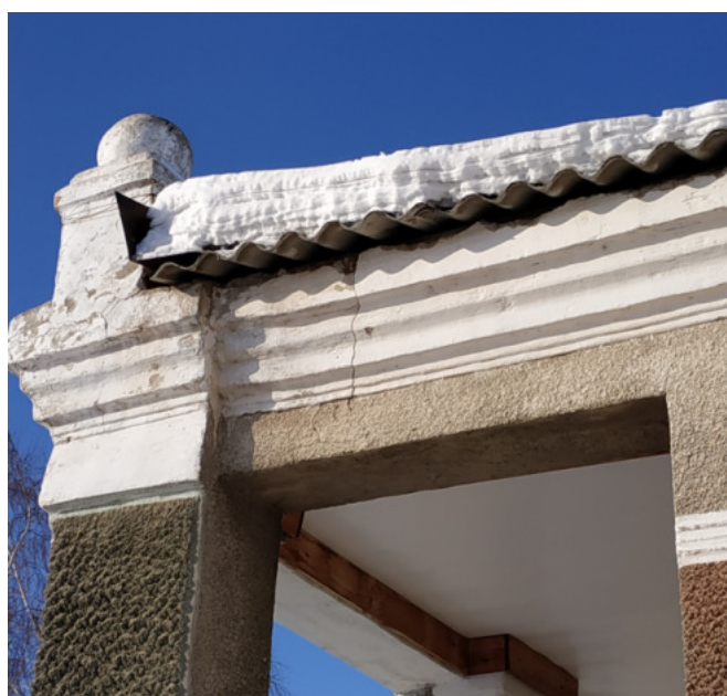
Рис.10 Трещина на карнизе.
