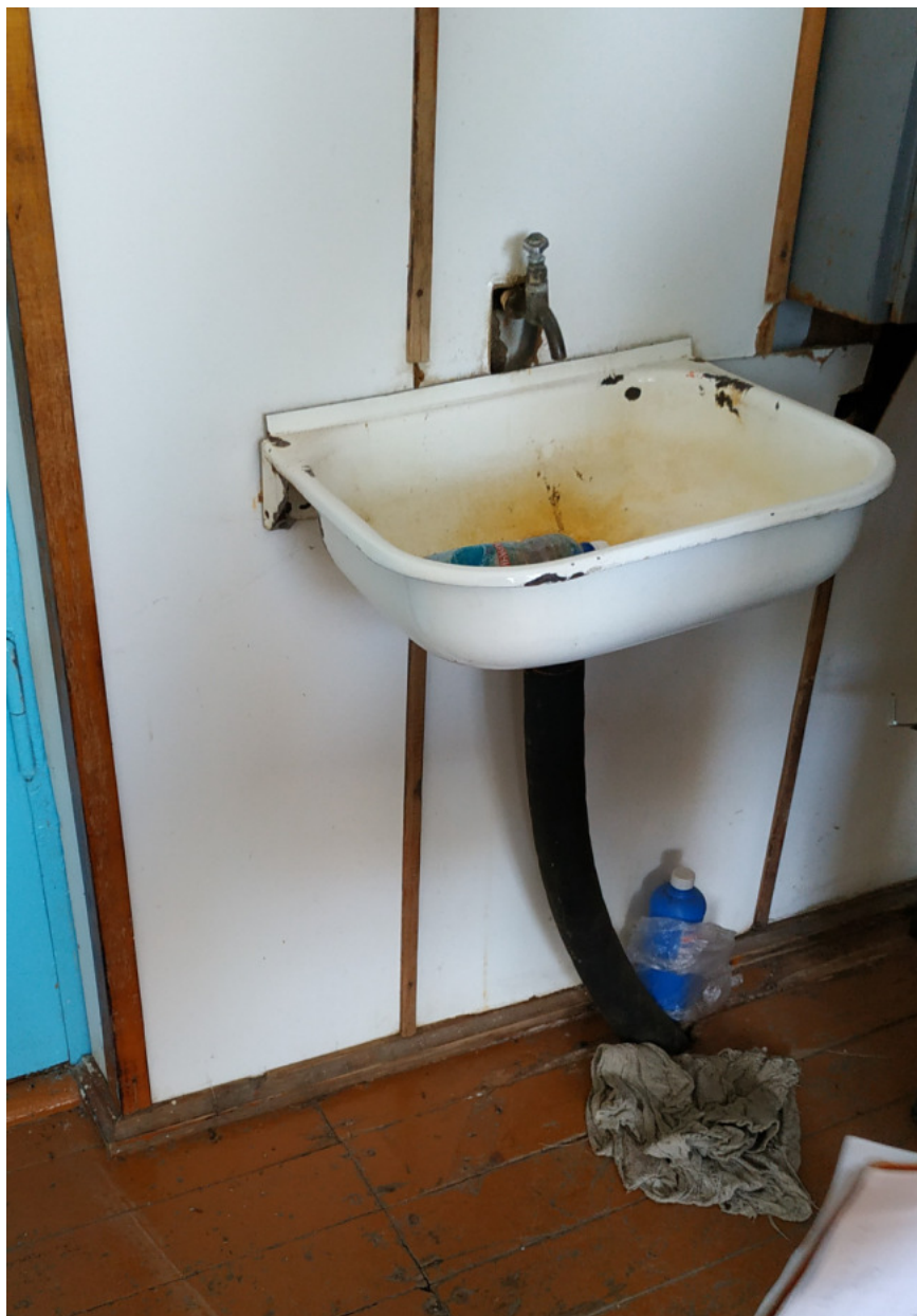
Рис.28 Отсутствие сифона на сливе.
