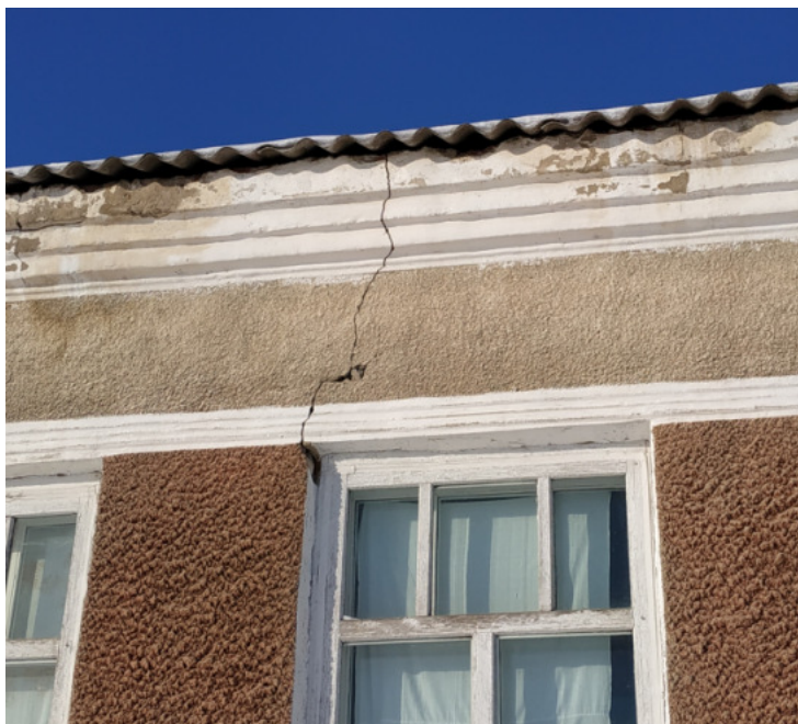
Рис.7 Трещина в надоконной части стены и в карнизе.
