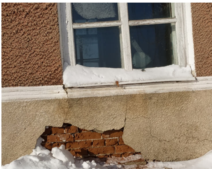
Рис.9 Отслоение штукатурки и разрушение кирпича в месте повреждения подоконных сливов.
