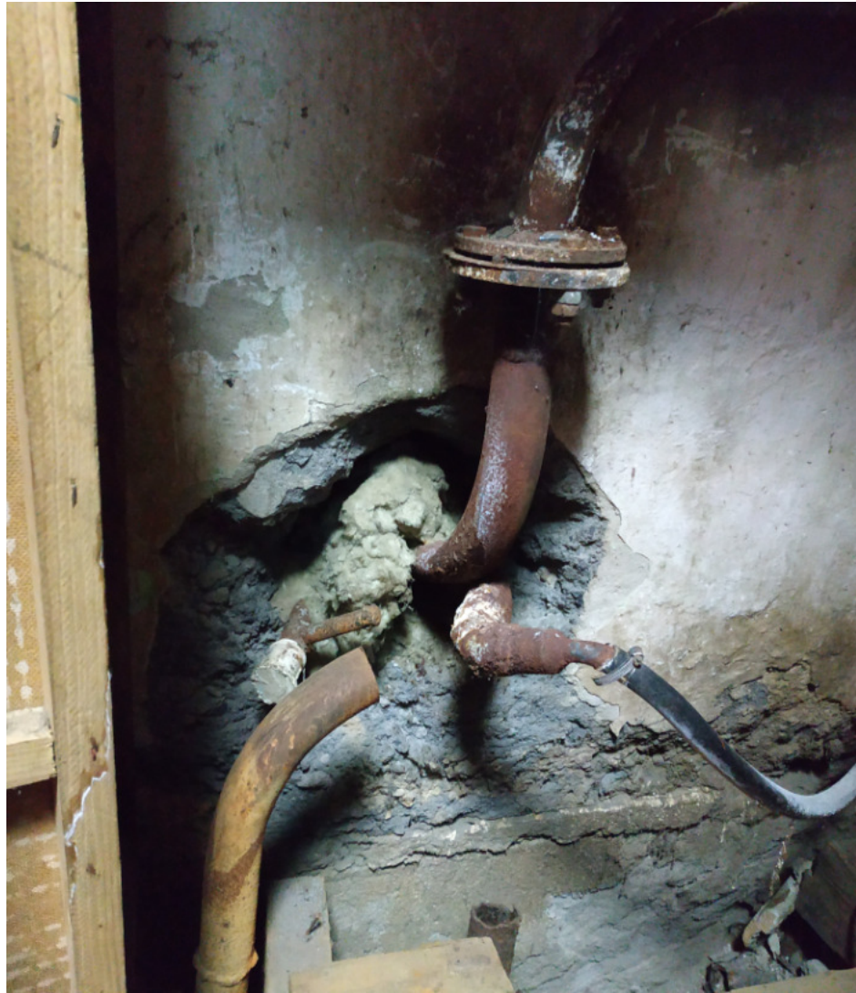
Рис.25 Узел ввода тепла и водоснабжения (трубы не покрашены и не теплоизолированы).
