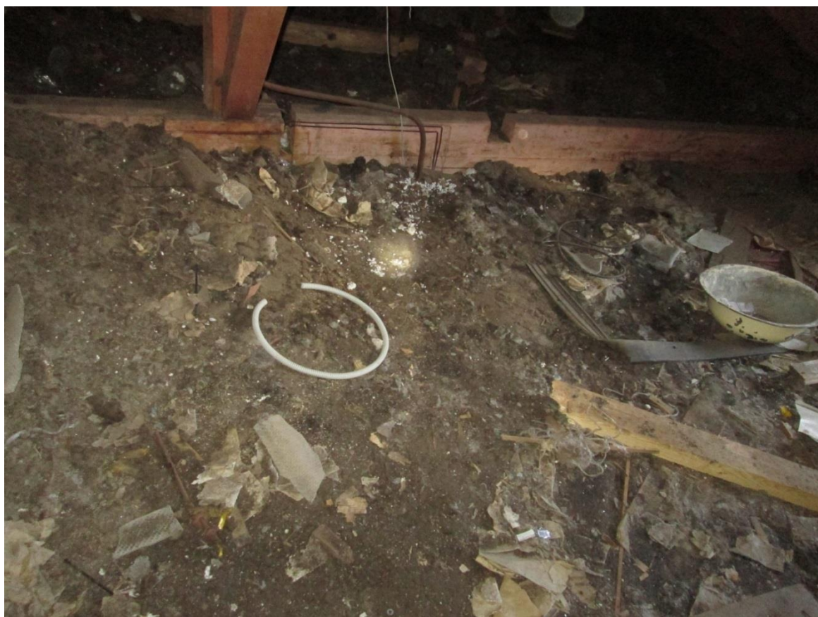
Фото Б.26. Состояние утеплителя
