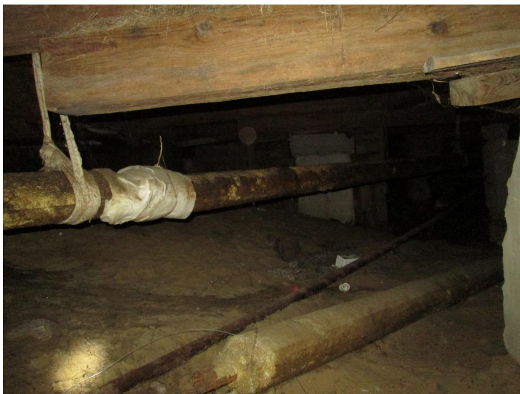
Фото Б.34.трубопровод холодного водоснабжения
