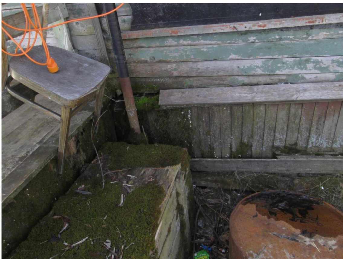
Фото Б.8. поражение гнилью конструкций крыльца, цокольной отделки и обшивки фасада
