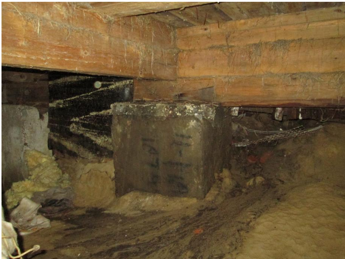
Фото Б.15. подтопление тех.подполья атмосферными осадками, замокание фундамента
