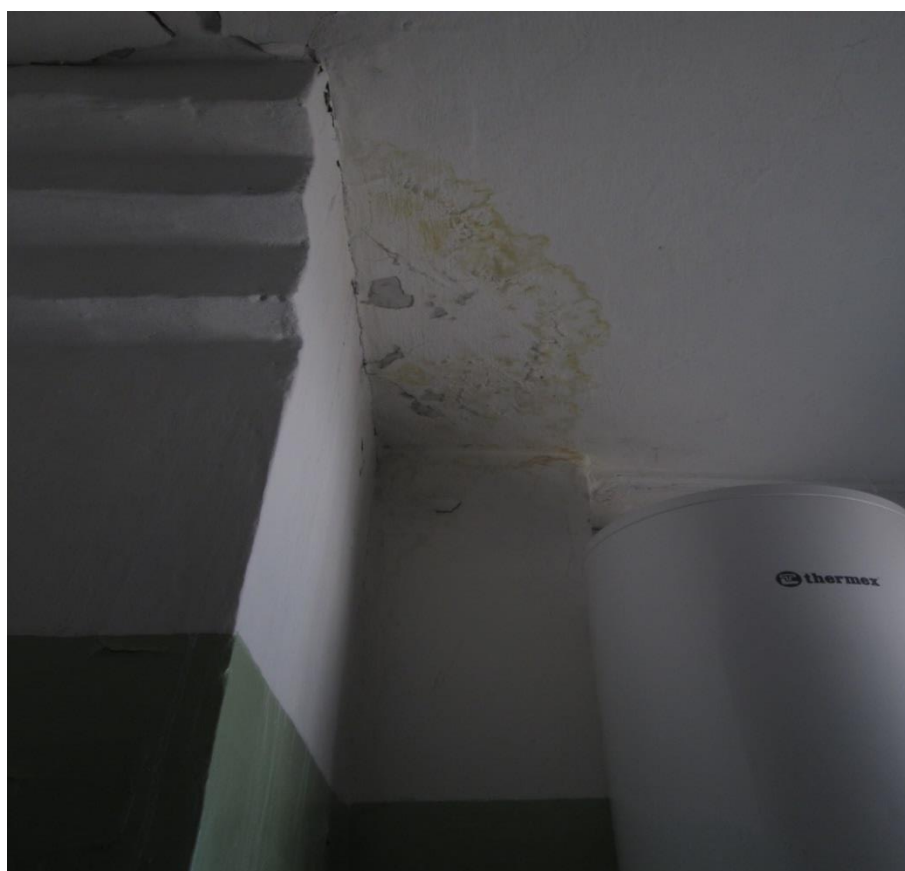
Фото Б.22. Следы протечек кровли на потолке 2-го этажа
