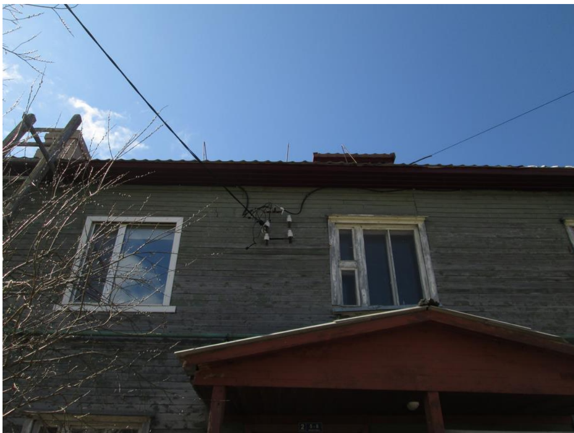
Фото Б.29. ввод электроэнергии в дом
