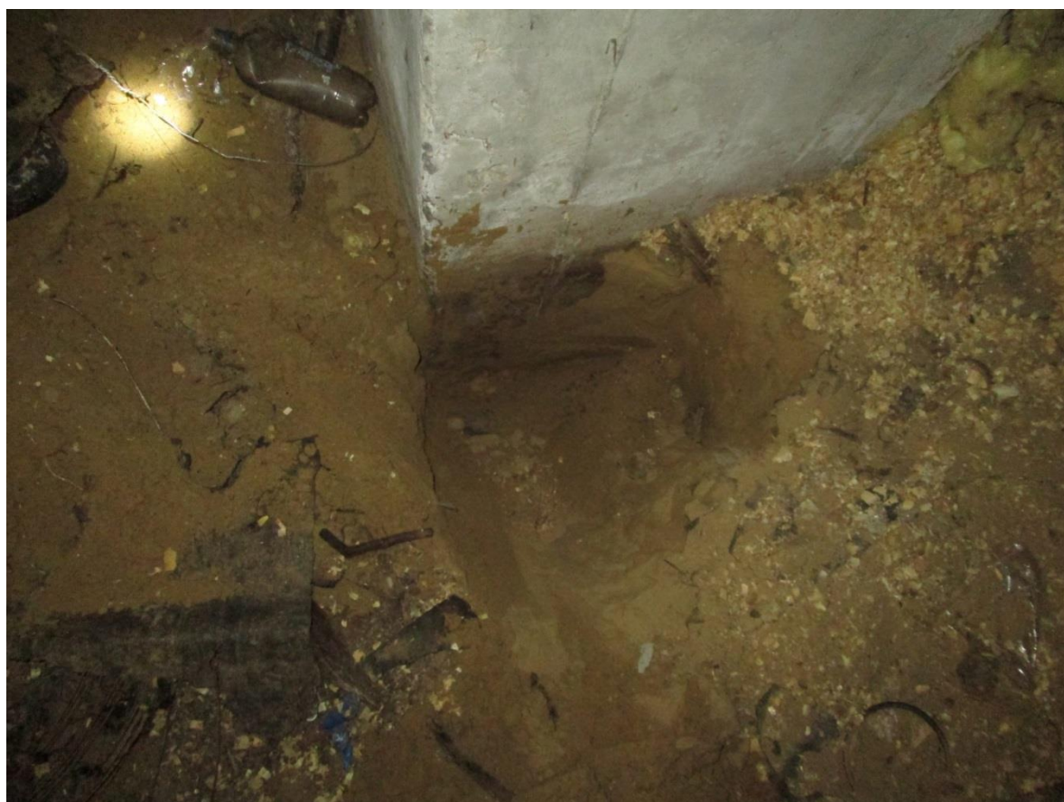
Фото Б.14. Отсутствие гидроизоляции
