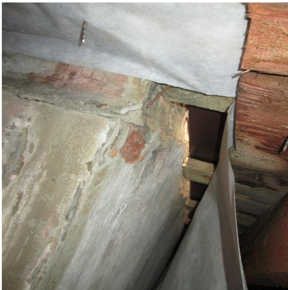
Фото Б.27. просветы и протечки кровли
