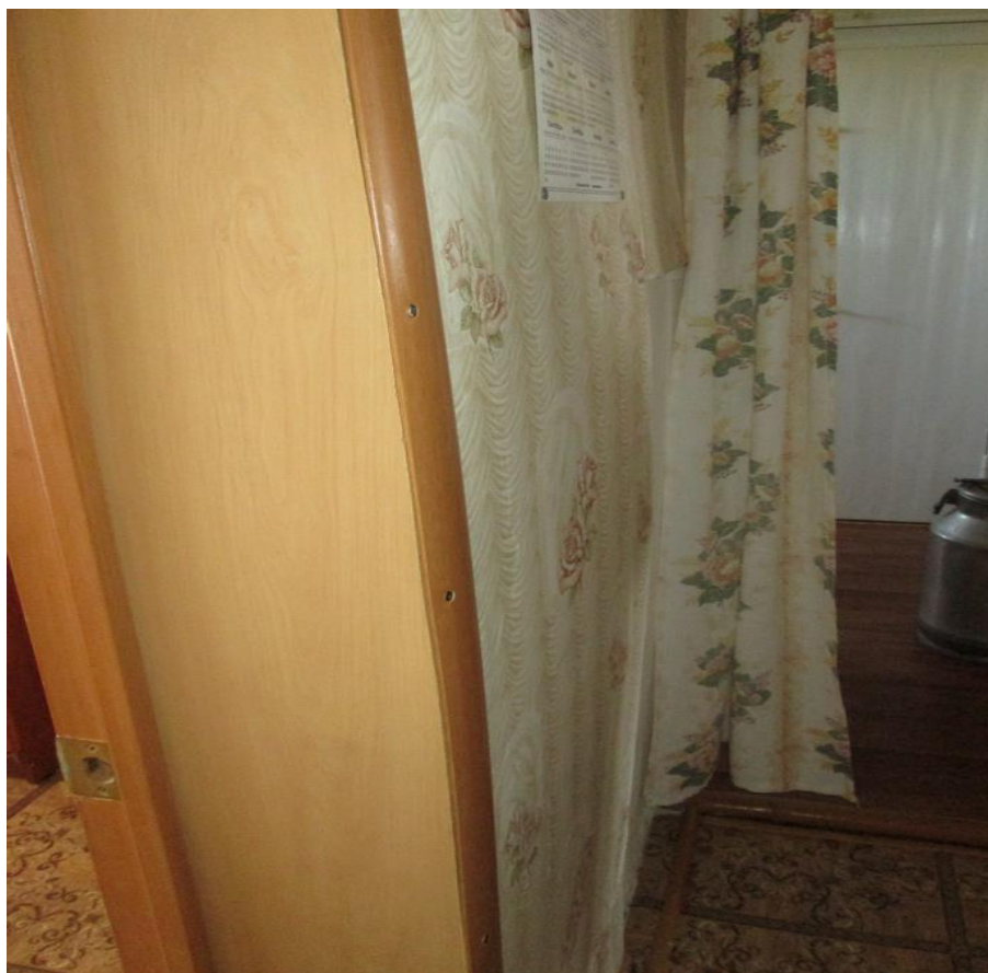
Фото Б.20. выпучивание внутренней стены
