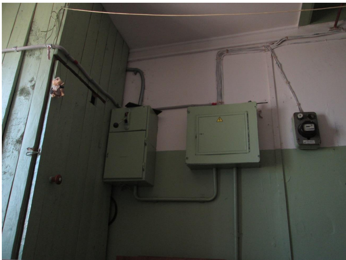
Фото Б.30. ВРУ и распределительный щиток
