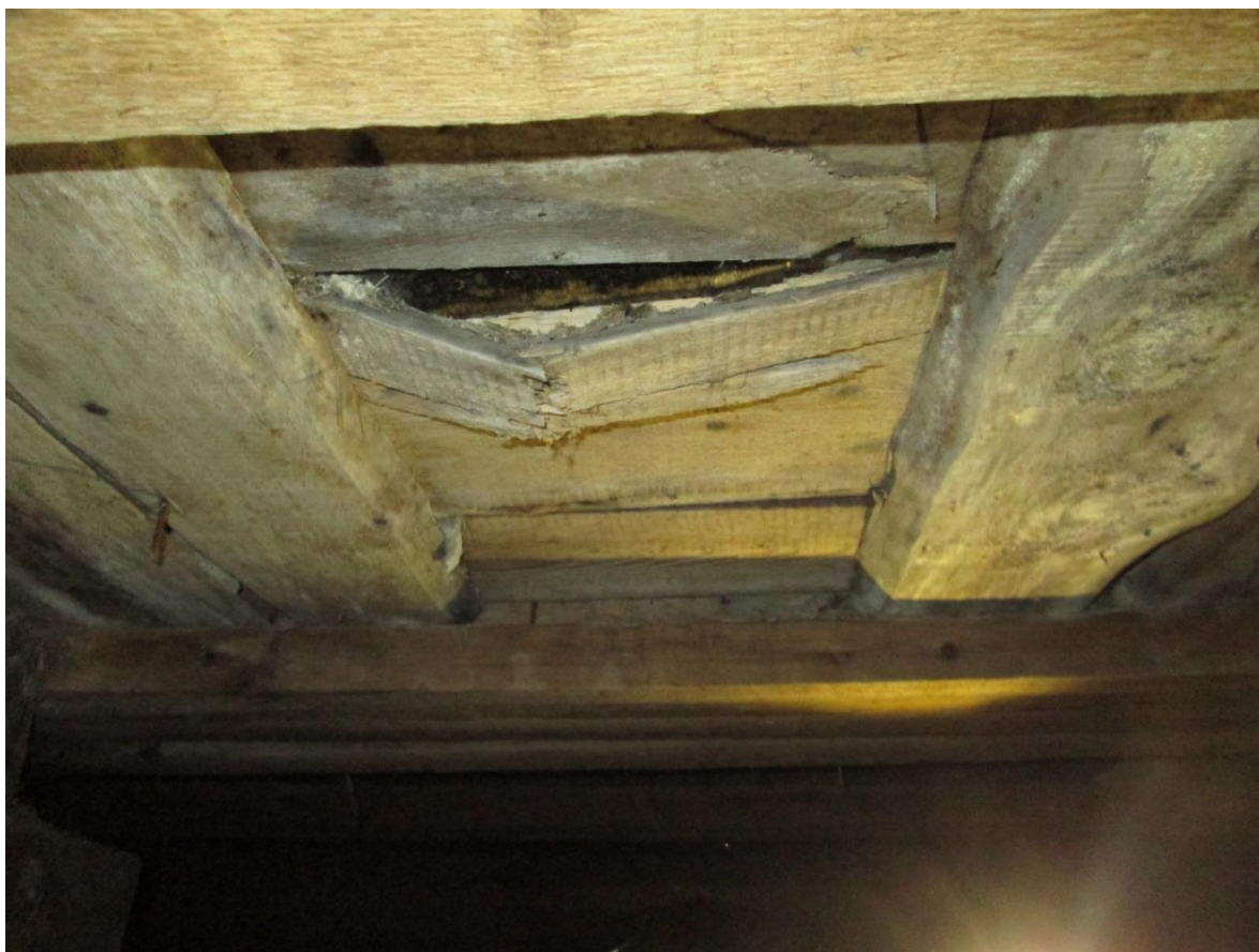
Фото Б.19. разрушение наката дощатого
