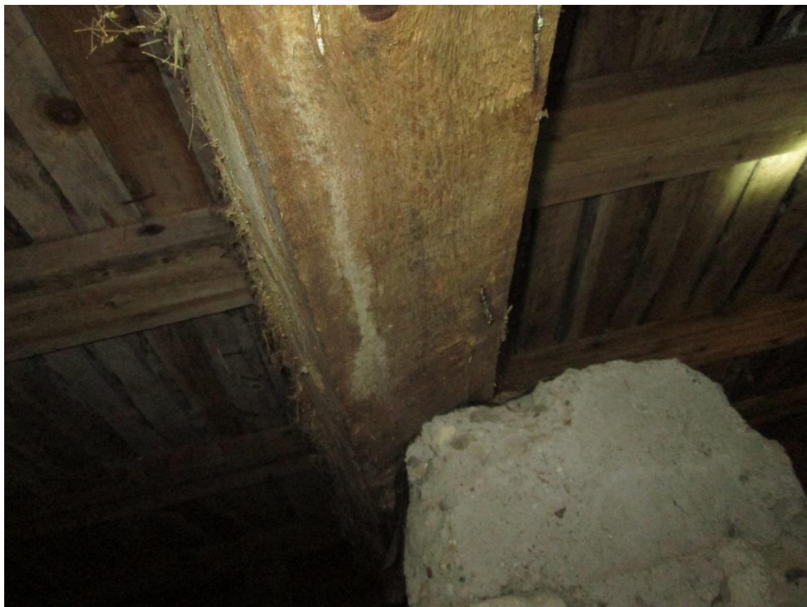
Фото Б.17-18. смещение бетонного столба от своего проектного положения
