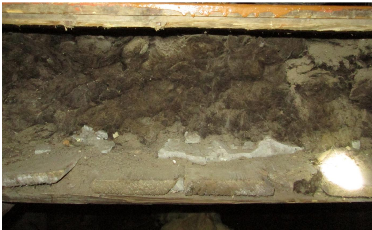
Фото Б.13. Состояние цокольного утеплителя
