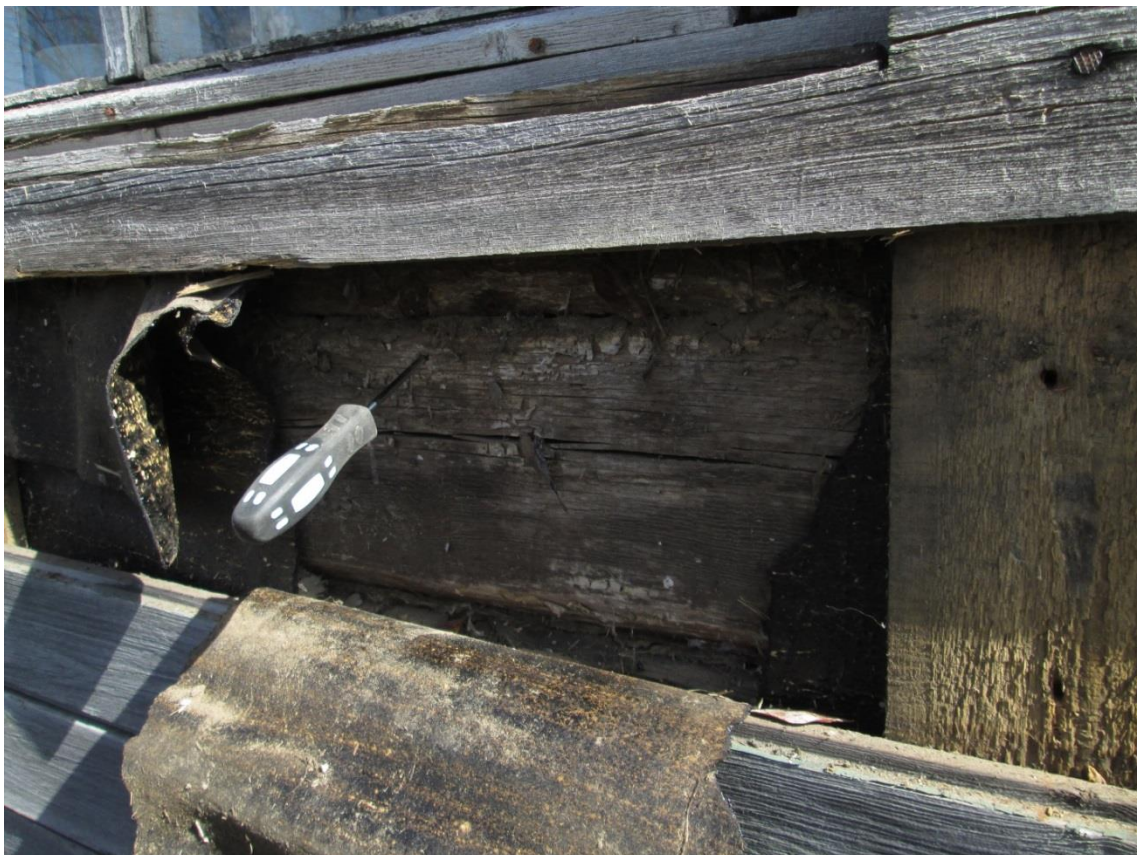
Фото Б.11. Поражение гнилью бруса.
