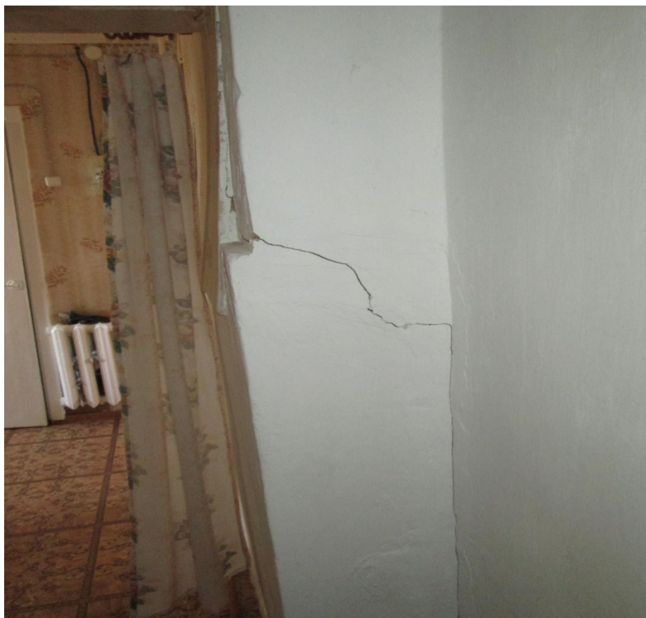
Фото Б.21. диагональные трещины в стене
