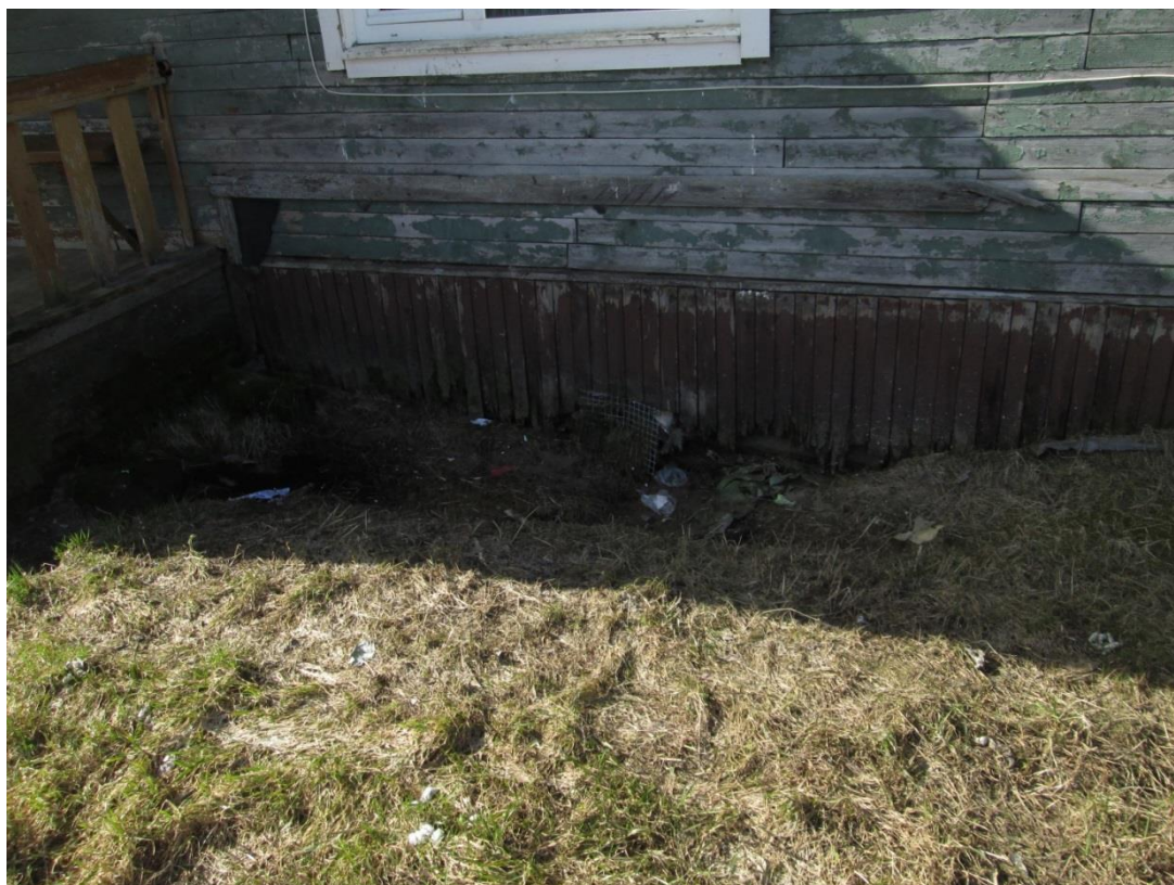
Фото Б.7. полное отсутствие отмостки,
