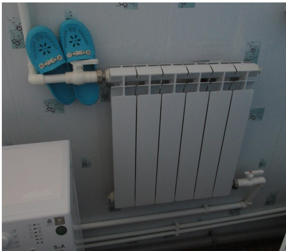
Фото Б.33.Радиатор отопления
