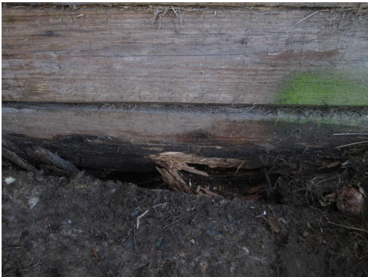
Фото Б.12. Поражение гнилью окладного венца.
