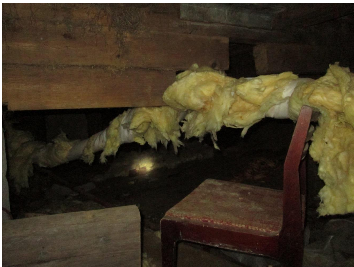
Фото Б.32.Состояние утеплителя теплопровода
