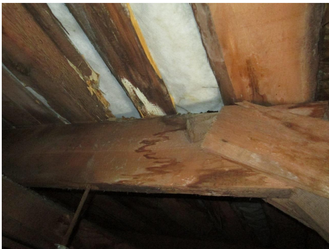
Фото Б.28. поражение рядовой обрешетки гнилью
