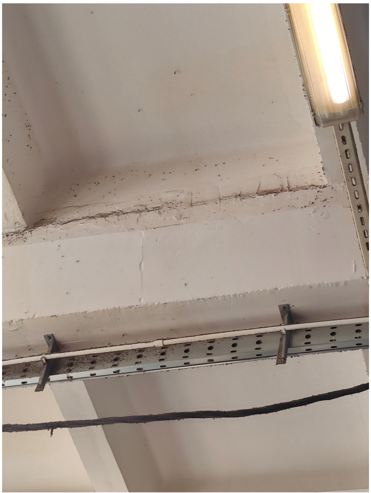
Незакрытая трещина в процессе накопления остаточных деформаций под приложением кратковременной нагрузки.
