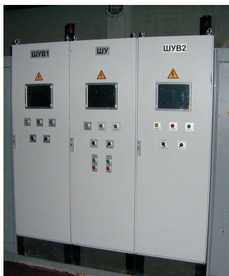
Шкафы управления ГВУ 2 ВЦ-25
