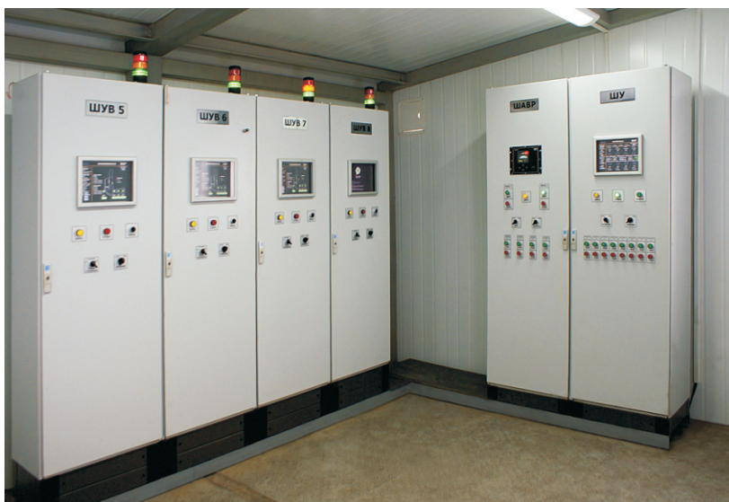
Шкафы управления ГВУ 8 ВЦ-15
