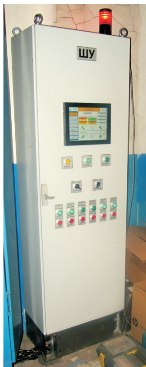
Шкаф управления ГВУ (ШУ) 6 ВЦ-15 в операторском отделе
