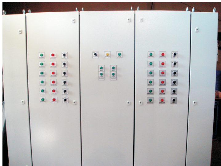
Силовой шкаф управления электрокалорифером
