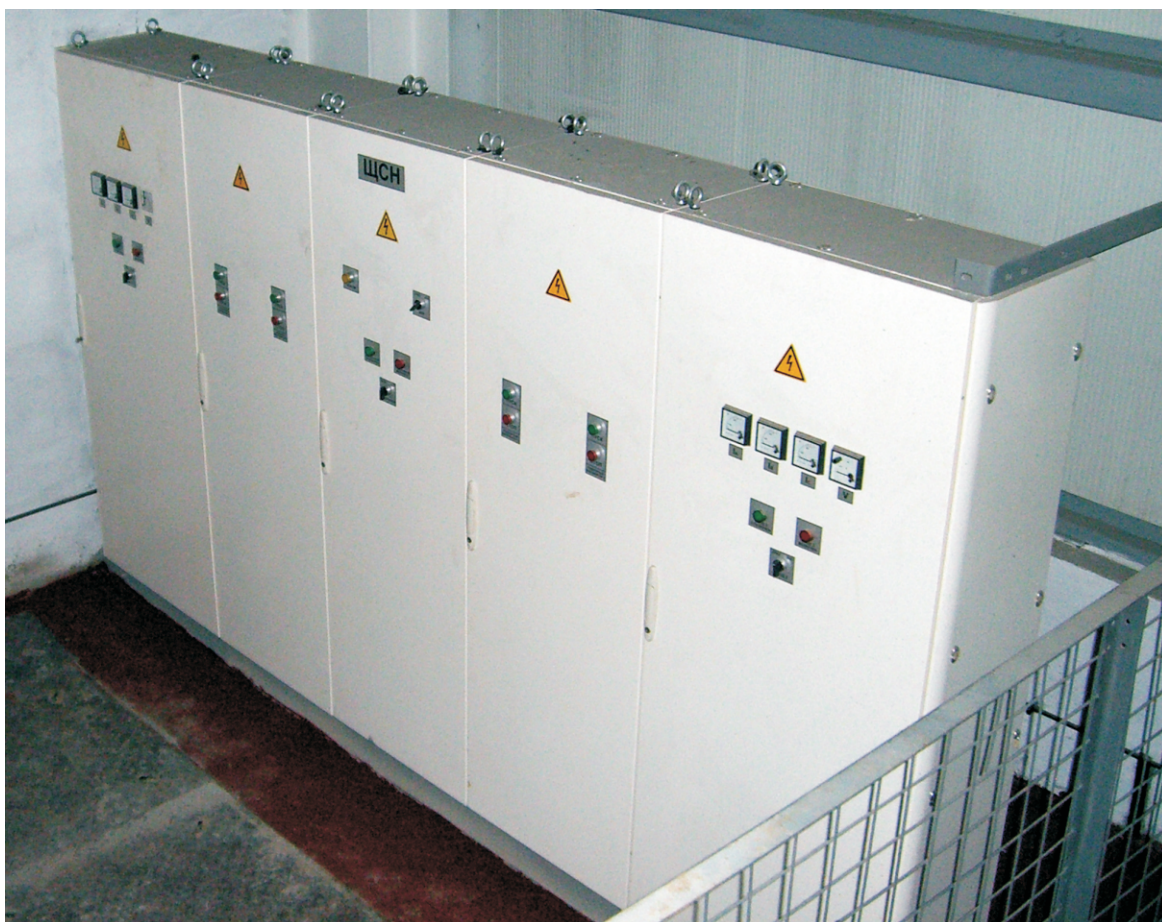
Щит собственных нужд 0,4 кВ
