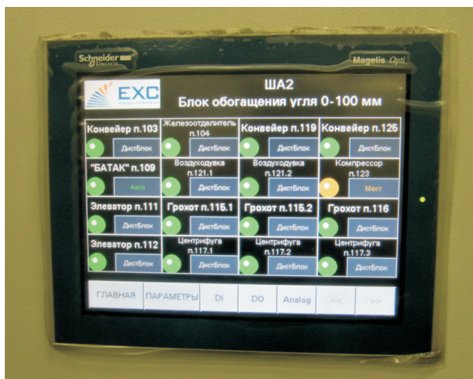
Панель управления на одном из шкафов автоматики
