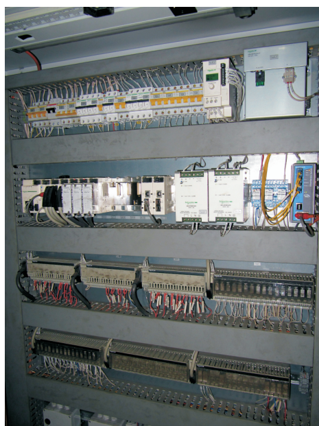
Один из шкафов автоматизации
