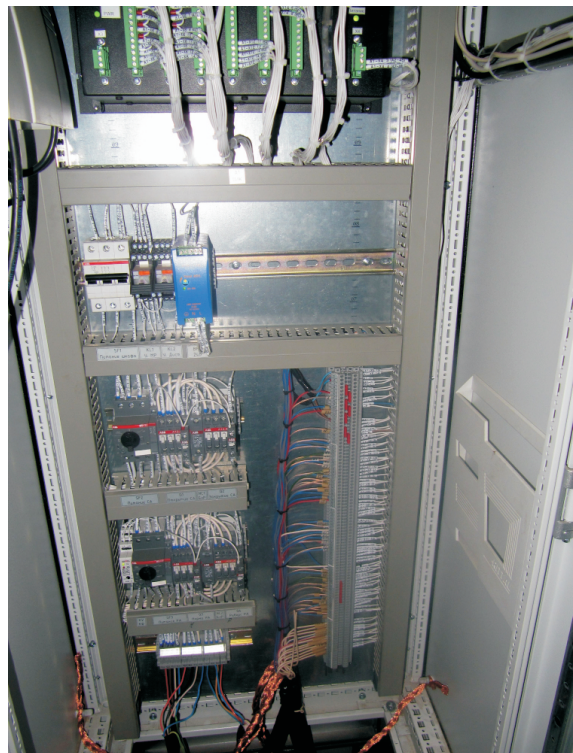
Шкаф управления вентилятором ВЦ-15
