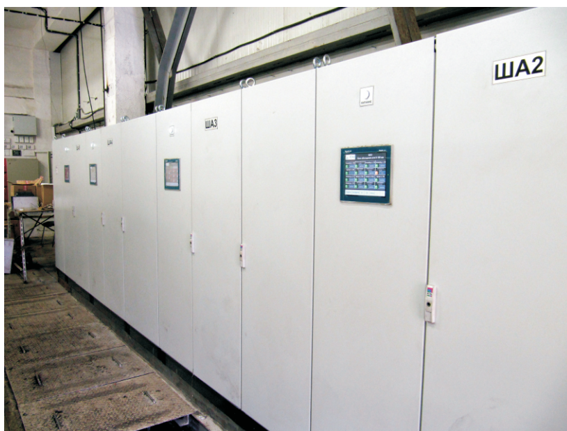
Шкафы автоматизации главного корпуса
