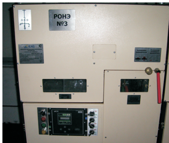
КРУ 6 для питания электрокалориферной установки
