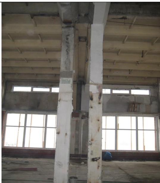
Фото №6. Общий вид на состояние деформационного шва.
