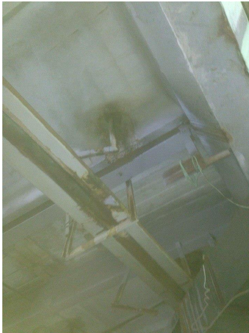
Рисунок 3.12. Протечка инженерных систем
