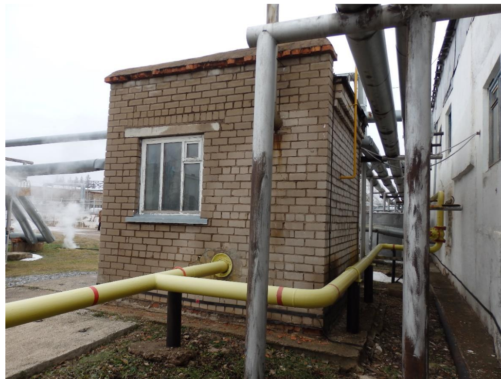
Обвязка наружного газопровода пункта учета газа
