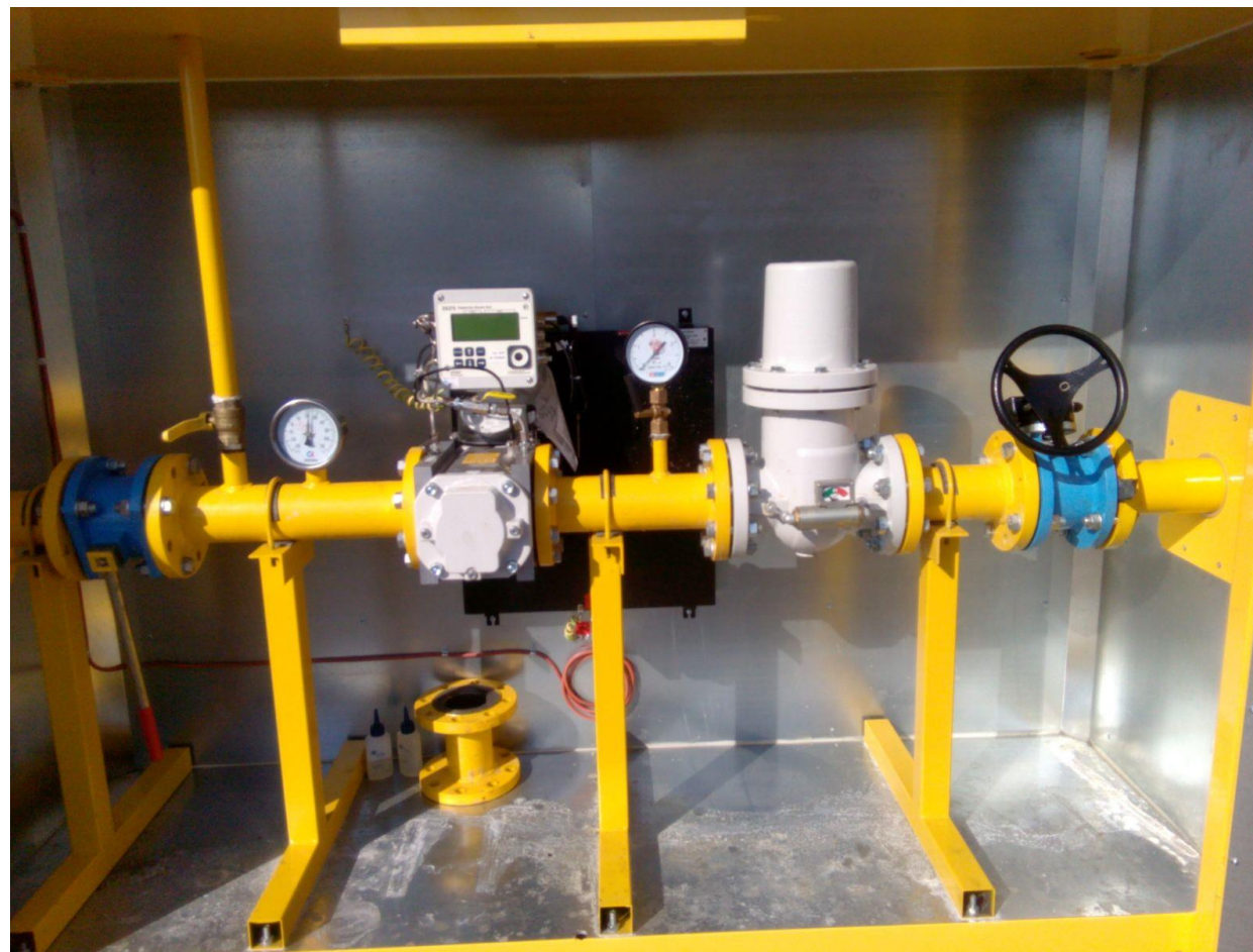
Внутренний вид пункта учета газа
