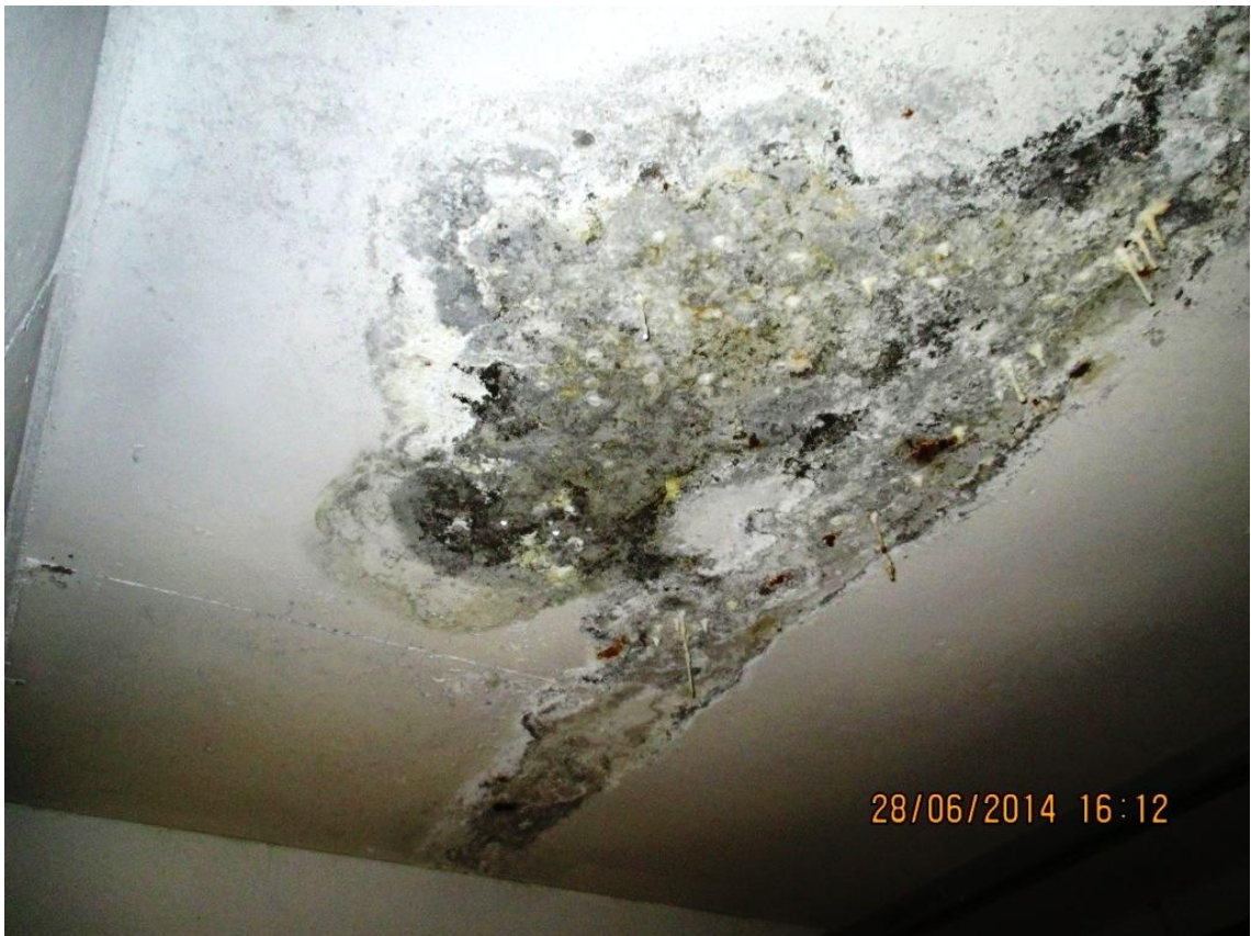
Фото №8. Следы сырости перекрытия над подземной автостоянкой.
