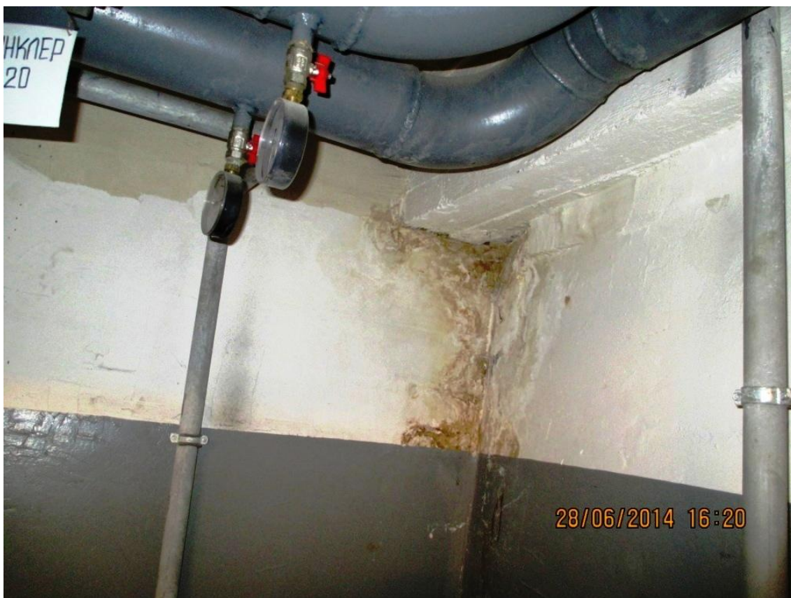
Фото №12. Следы сырости наружной стены подземной автостоянки.
