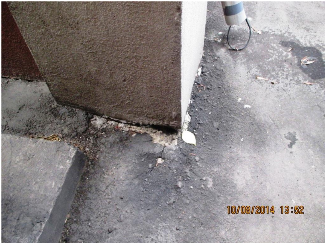
Фото №20. Щели в месте примыкания асфальтобетонной отмостки к наружным стенам здания (стр.19).
