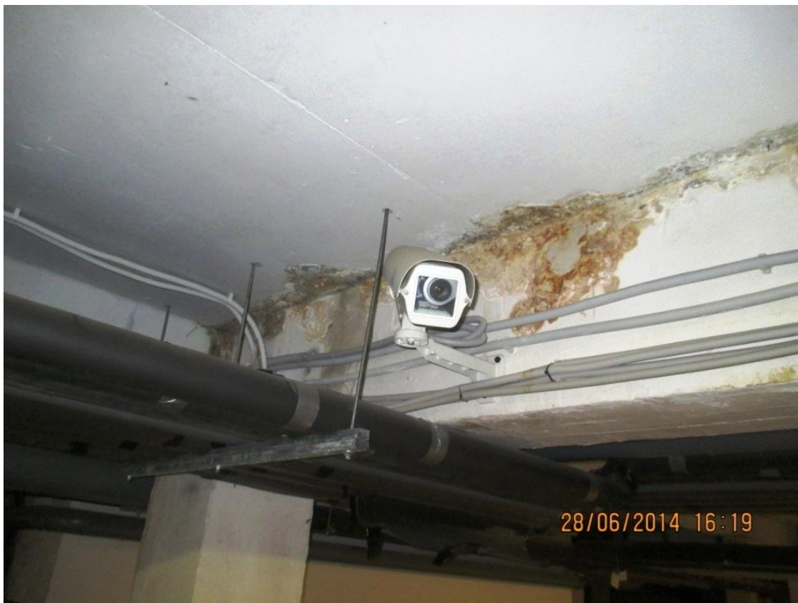
Фото №11. Следы сырости перекрытия над подземной автостоянкой.
