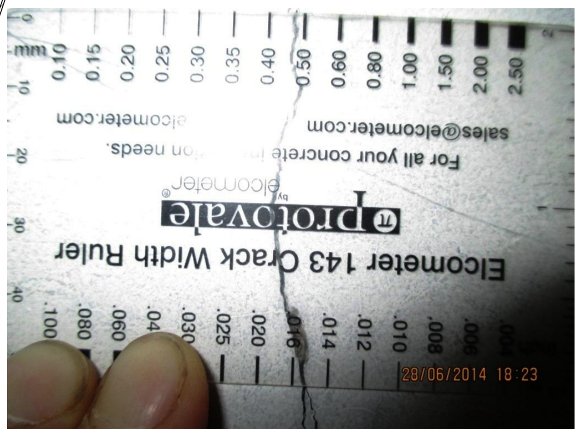
Обсл.№5/подв. Трещина в монолитном железобетонном ригеле.
