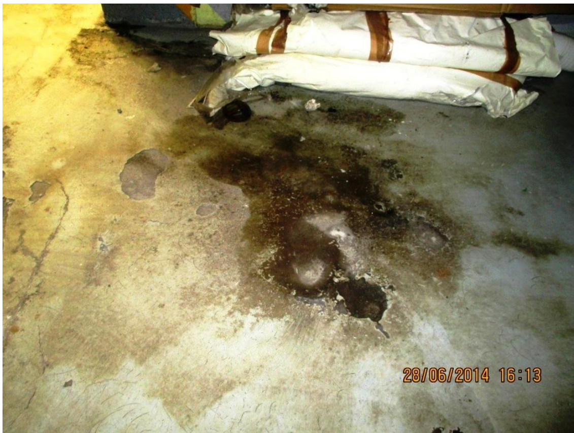
Фото №9. Следы сырости полов подземной автостоянки, разрушение выравнивающего слоя.
