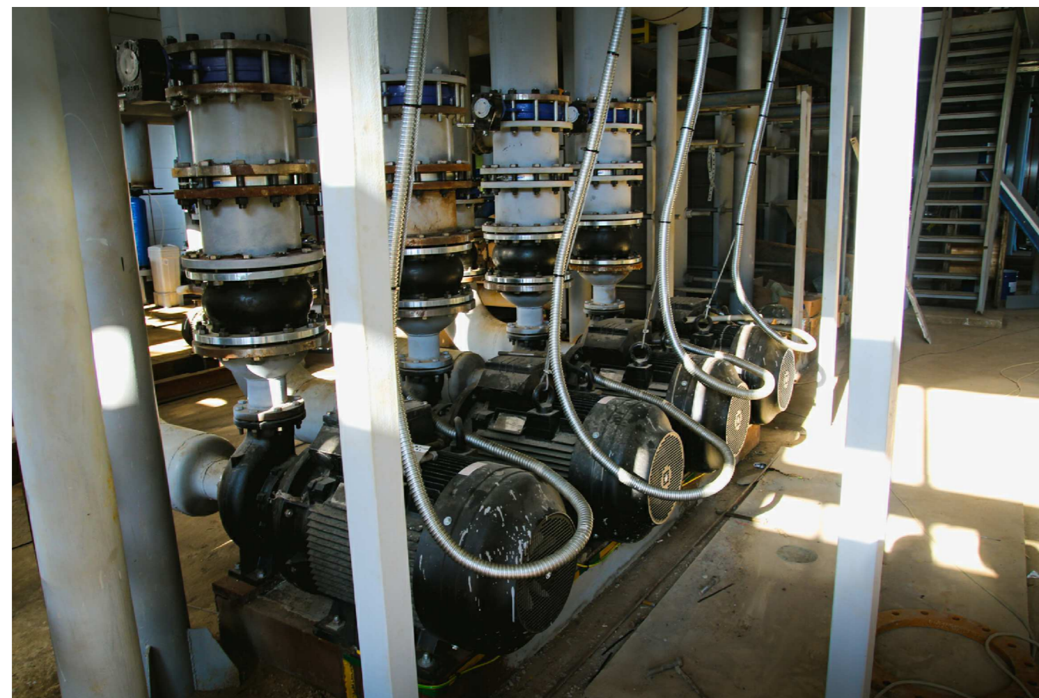
Узел насосов на объекте
