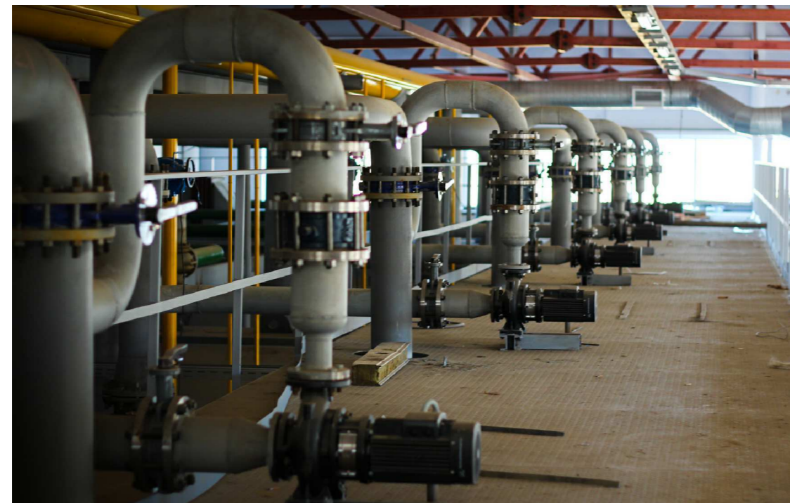
Узел насосов на объекте
